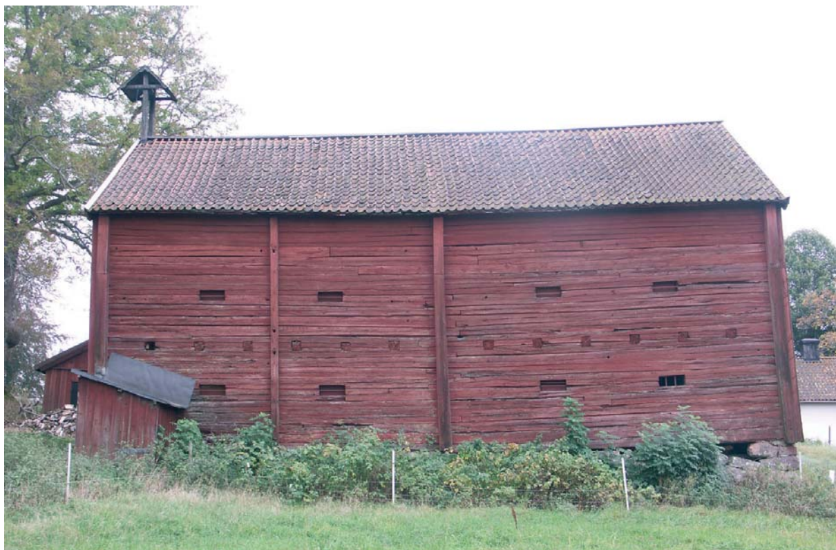
Bild 31. Magasinets norra fasad som har satt sig på mitten. Taket svackar.
