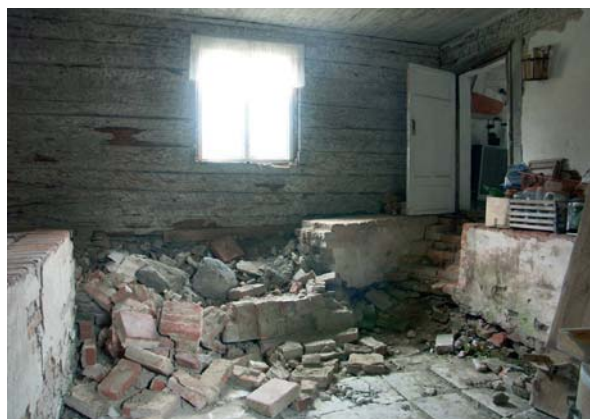
Bild 19. Mejeriet sett mot norr, där muren har rasat.
