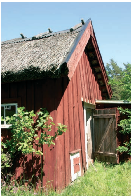
Bild 10. Södra gaveln av byggnaden innan takomläggningen. Vindskivor hade plåttäckning och ryggningen bestod av trapetskorrugerad plåt.
