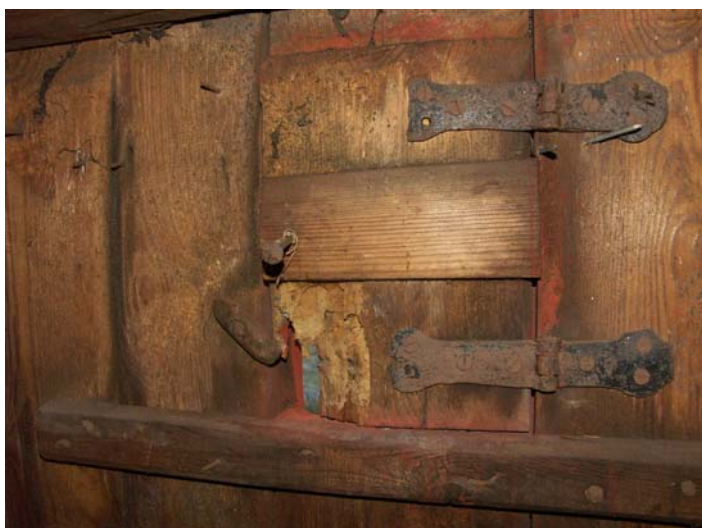
Luckan mot sydost är angripen av trägnagare, vilket gör att luckan är svår att haspa för.
