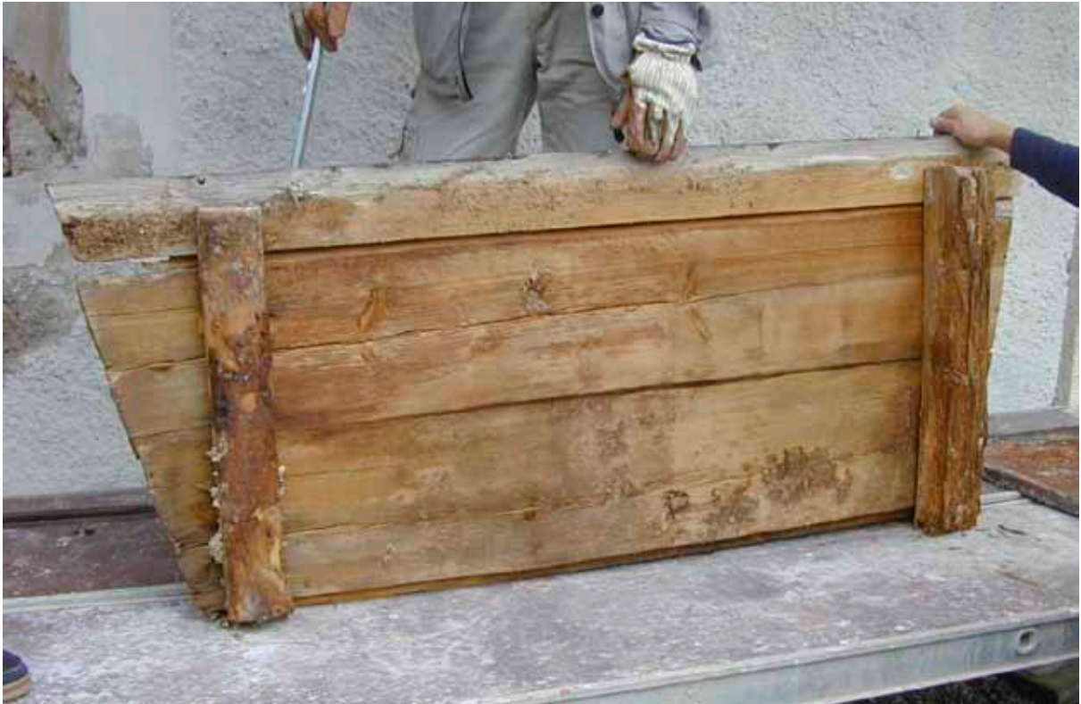
Figur 21. Undersidan på ett av de kasserade spikunderlagen till solbänksplåtarna på sydsidan.
