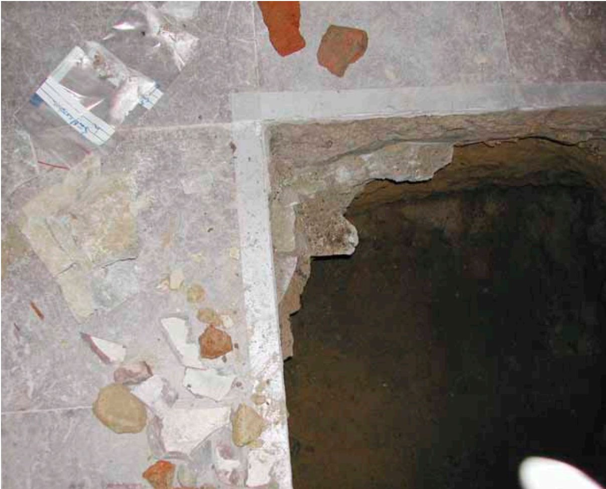
Figur 82. Hörnet till altarskivan skadades då entreprenören skulle öppna schaktet.
