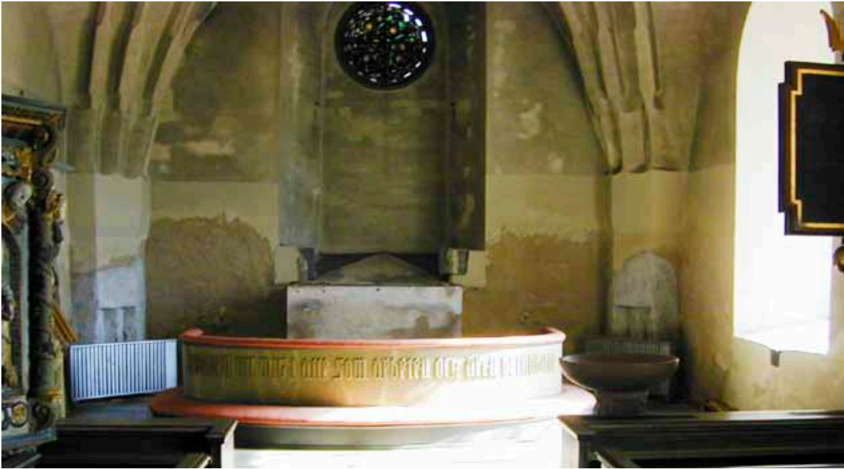
Figur 40. Korets väggar hade omfattande saltutfällningsproblem vilket orsakade färg och putsbortfall. Foto taget i mars 2003.
