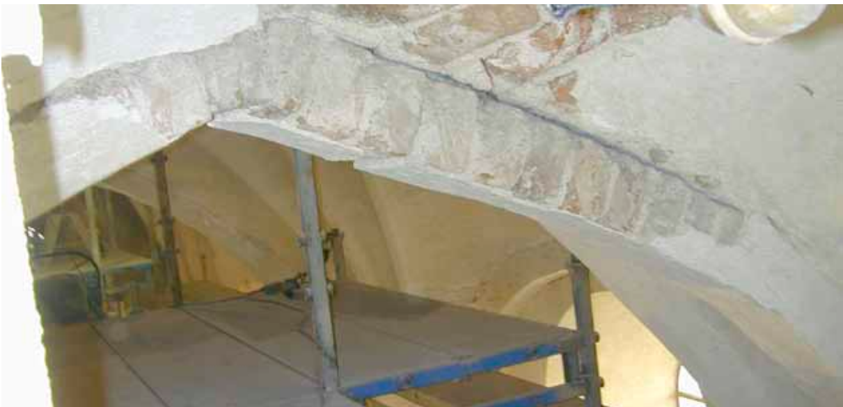
Figur 41. Gördelbågen mellan västra och mälärsta valven var deformerad åt söder på ett sätt som bedömdes kunna äventyra konstruktionen. Detta parti sattes därör om. Den ointäckta klotförsedda länken till ljuskjronan i västvalvet (skymtar i bildens högra övre hörn) var föremål för diskussion under projektet. Klotens förgyllning bär fortfarande 2005 spår av kalkstänk från denna incident..
