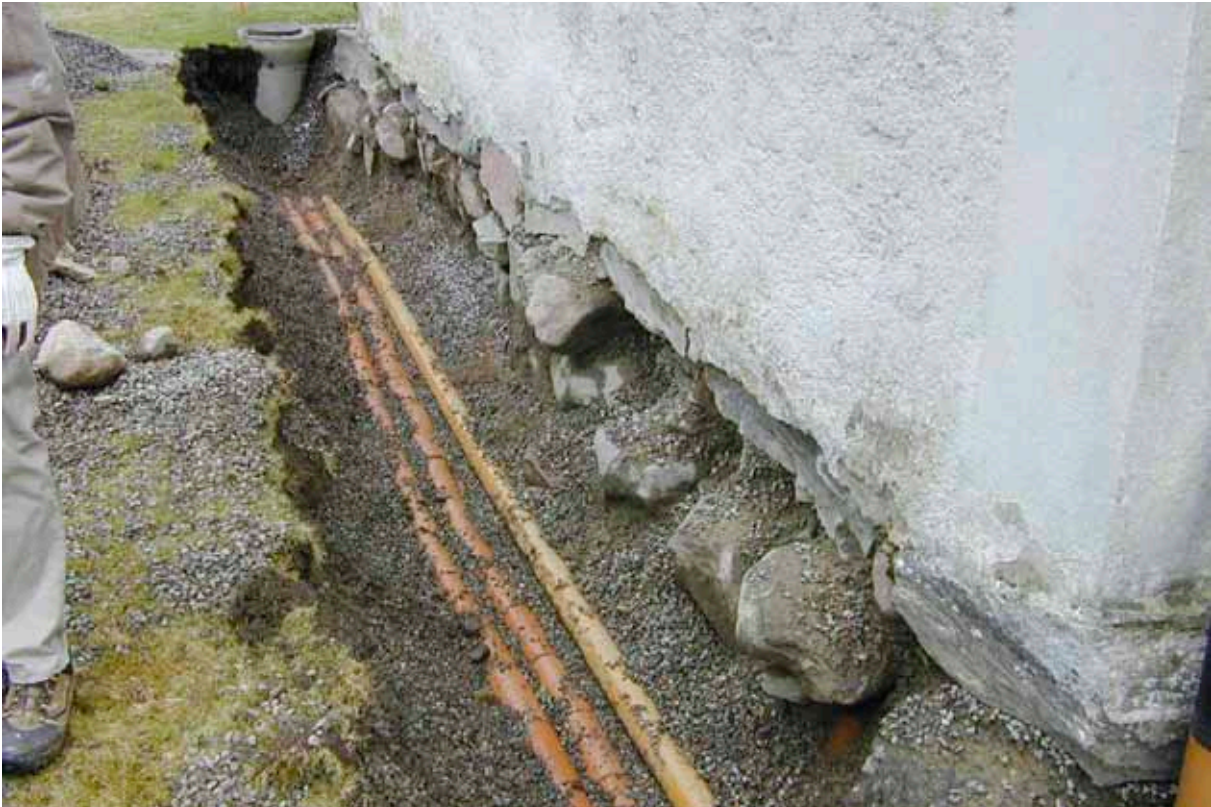
Figur 32. Dräneringsschaktet längs korgaveln öppnades för att kontrollera dess funktion. Foto april 2003.
