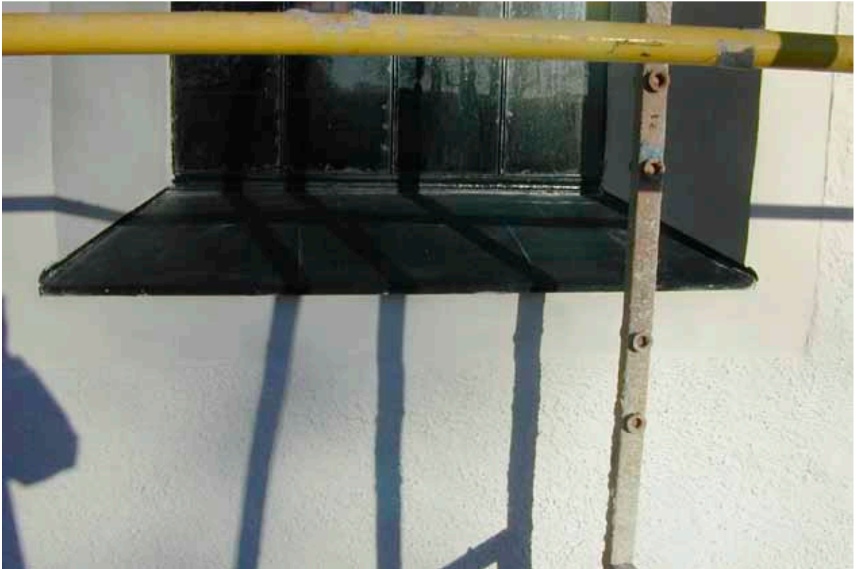
Figur 25. Långhusets gamla solbänksplåtar är bevarade men förändrade där de ansluter fönsternischens putsfasad.
