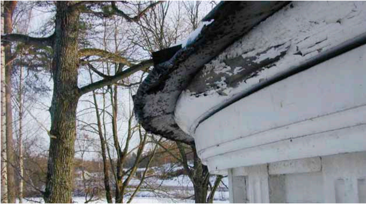
Figur 21. Takläckage förekom i anslutning till takfoten samt i anslutning till kulan vid det koniska takets spets. Färgbortfallet och det mörknade träet på bilden antydde att rötskador i viss omfattning förekom i anslutning till ett sådant läckage.
