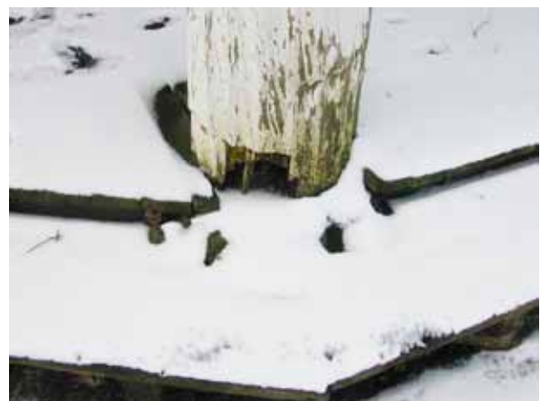
Figur 20. Rötskador på kolonn som är orsakad av bakfall från kolonnens på bilden snötäckt fundament.
