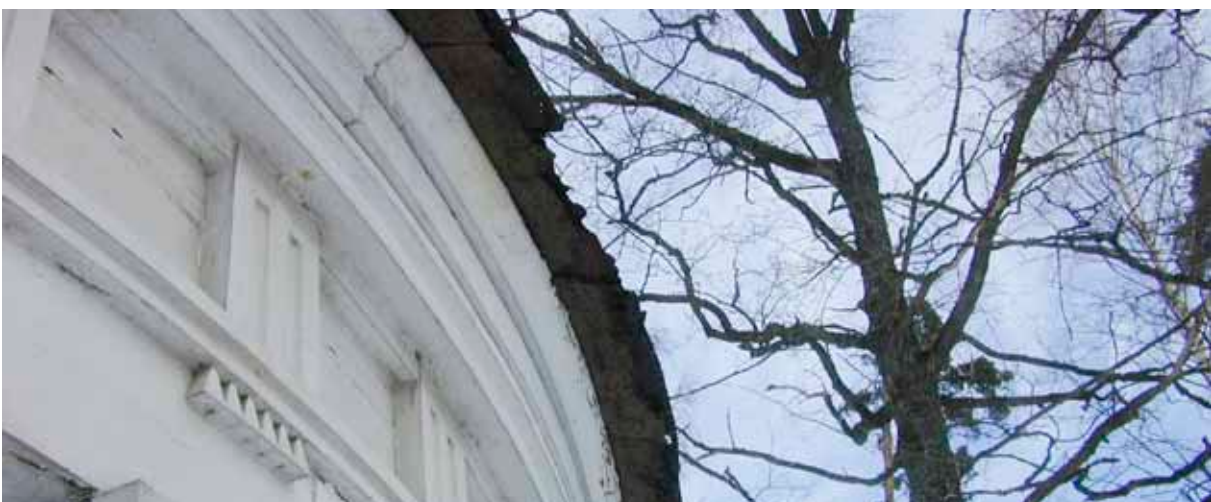
Figur 22. Språngblecket samt ett stort antal av plåtskivorna i det nedersta skiftet (vid takfot) hade allvarliga rostskador.
