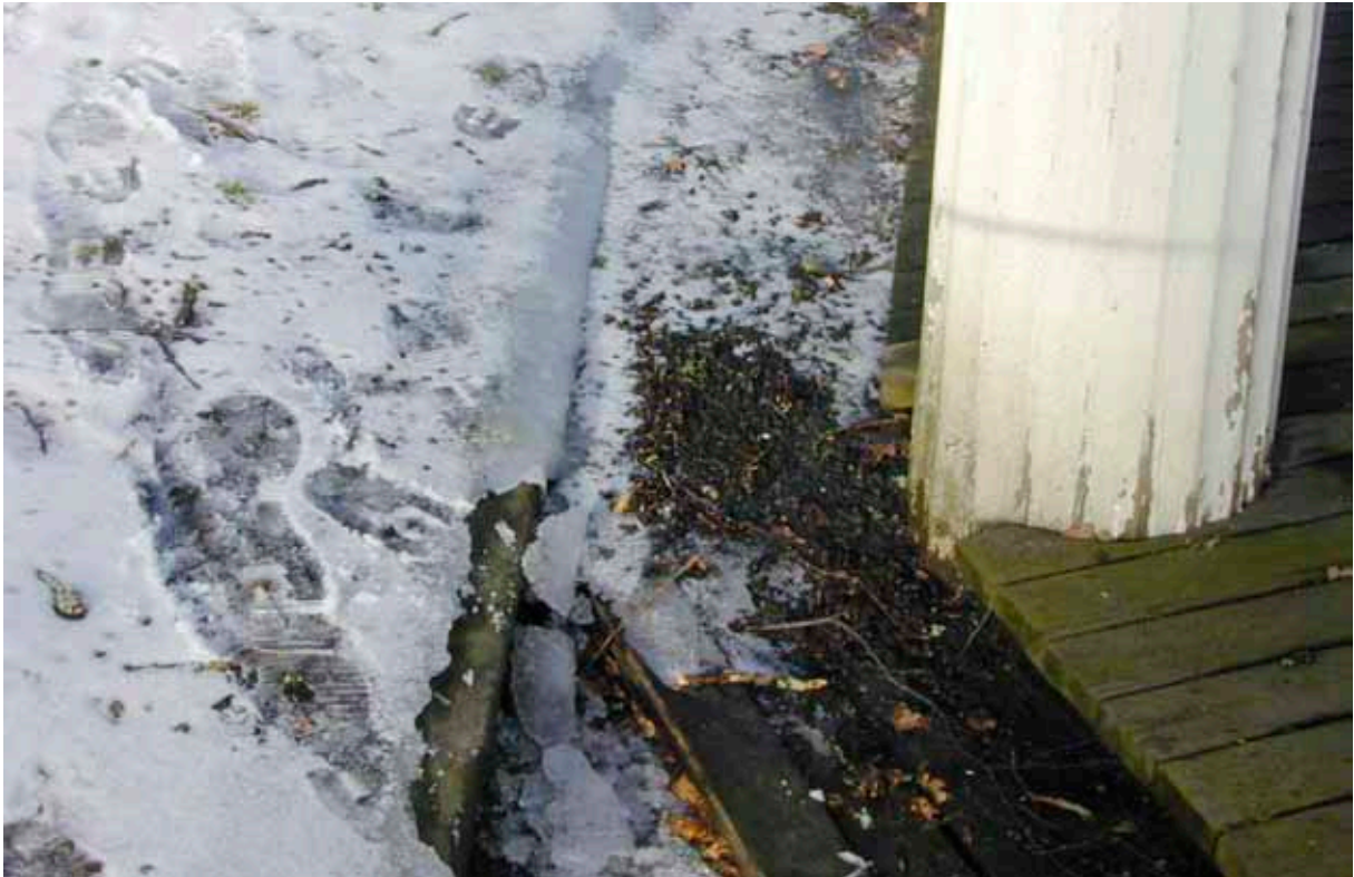
Figur 19. I samband med anläggande eller underhåll av framfartsvägen till 1960-talsvillan på tempeludden har marknivån förhöjts i omedelbar anslutning till templet. Detta innebär att löv, jord mm kan spolas ner mot templets vilket bidrar till förna och jordbildning i anslutning till templets träkonstruktioner. Risken för rötskador är överhängande.
