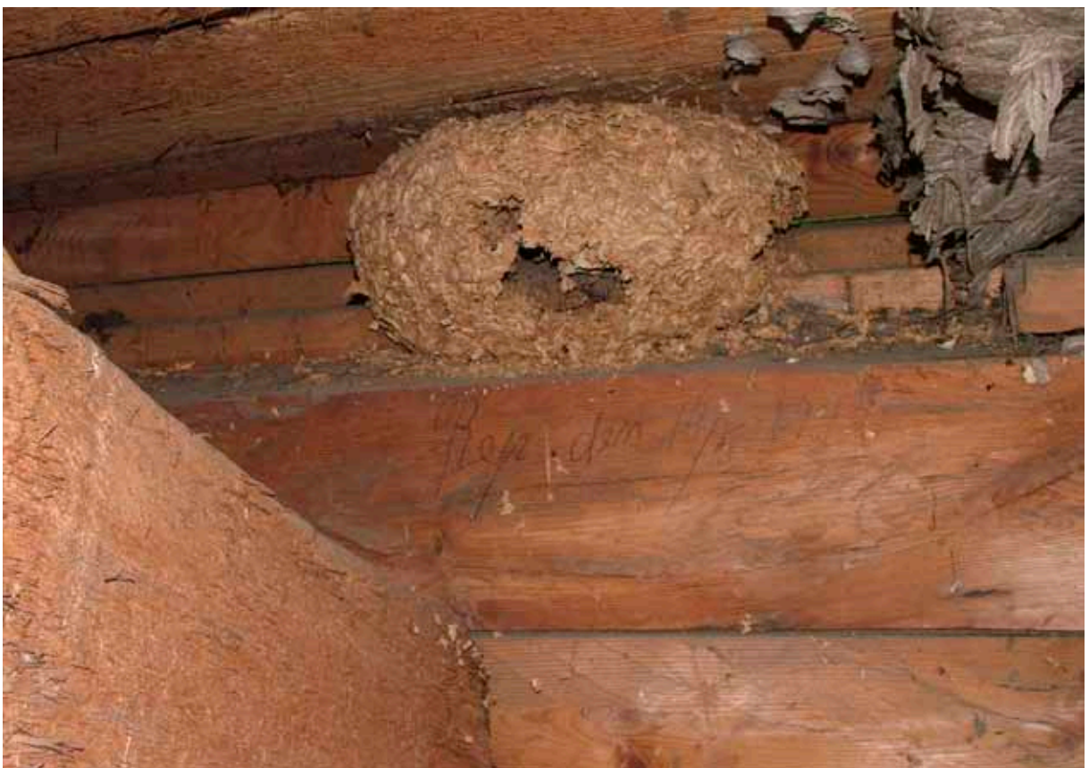
Figur 39. En inskription på hammarbandet till templet under innertakets skivtäckning daterar en reparation till 14 maj 1945. Detta bör vara tidpunkten för monteringen av masonitetaket. Bjälken i bildens nedre vänstra hörn utgör del av det välvda konstruktionsvirke varpå det ursprungliga vävspända taket var monterat. (Foto: Anita Lindqvist 2004)
