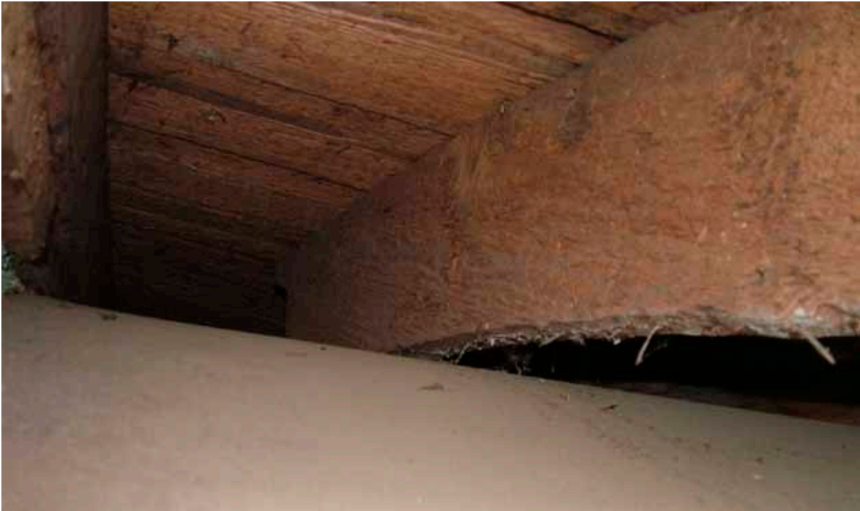
Figur 40. Den välvda regeln har ugjort spikunderlag till ursprungligt innertak. Masoniteskivtäckningen syns nedan i bild och plåttakets undertak av råplanade brädor syns i ovankant. (Foto: Anita Lindqvist, 2004)
