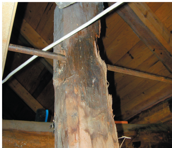
Rötskador på en följare som utgjorde den östra infästningspunkten för ett dragstag som går tvärs över byggnaden i nivå med vindsbjälklaget.
