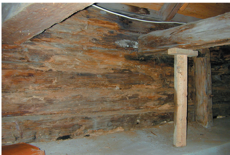
Rötskadat väggparti före åtgärd- Rötskadan försvagade infästningspunkten för en av bjälkarna till vindsbjälklaget. Hammarbandet var av samma anledning försvagat vid sparrarnas infästning i anslutning till det aktuella väggavsnittet.
