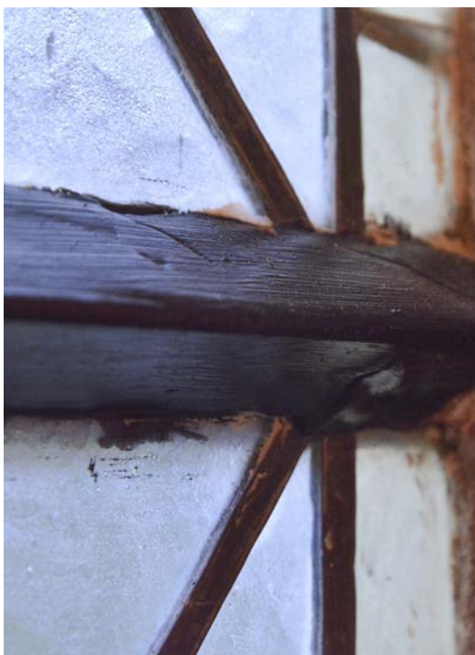
Bild 15. Rostskyddsmålad tvärpost på ett av fönstren. SLM D2021-0443.
