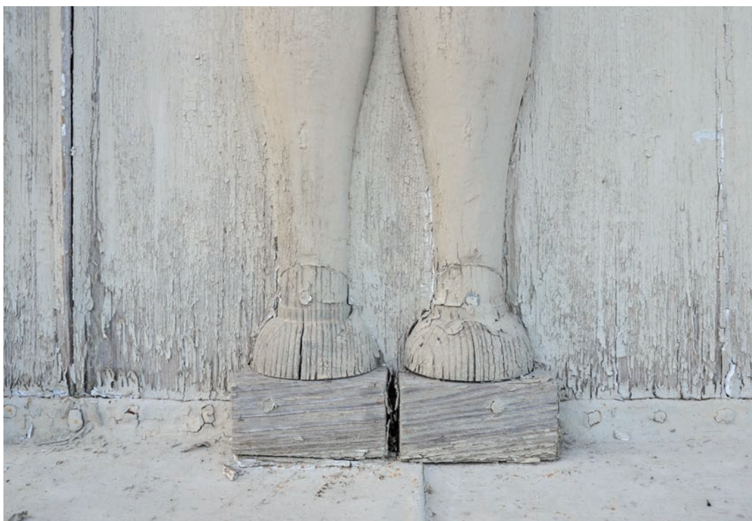
Två av balusterdockornas basar i en av fönsterbröstningarna före åtgärd. Färgen har flagat och sprickor finns i träet. Foto: Emelie Mattsson (SLM D2018-0631)
