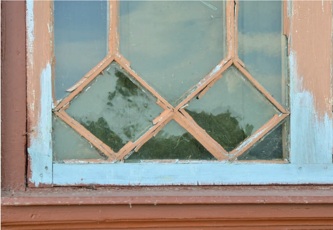
En av fönsterbågarna före åtgärd. Kittet har släppt från glas och trä och färgen flagar på sina ställen. Penseln har strukits ren på bågen efter målning av fasad, därav den ljusa färgen. Foto: David Hansson (SLM D2018-0644)
