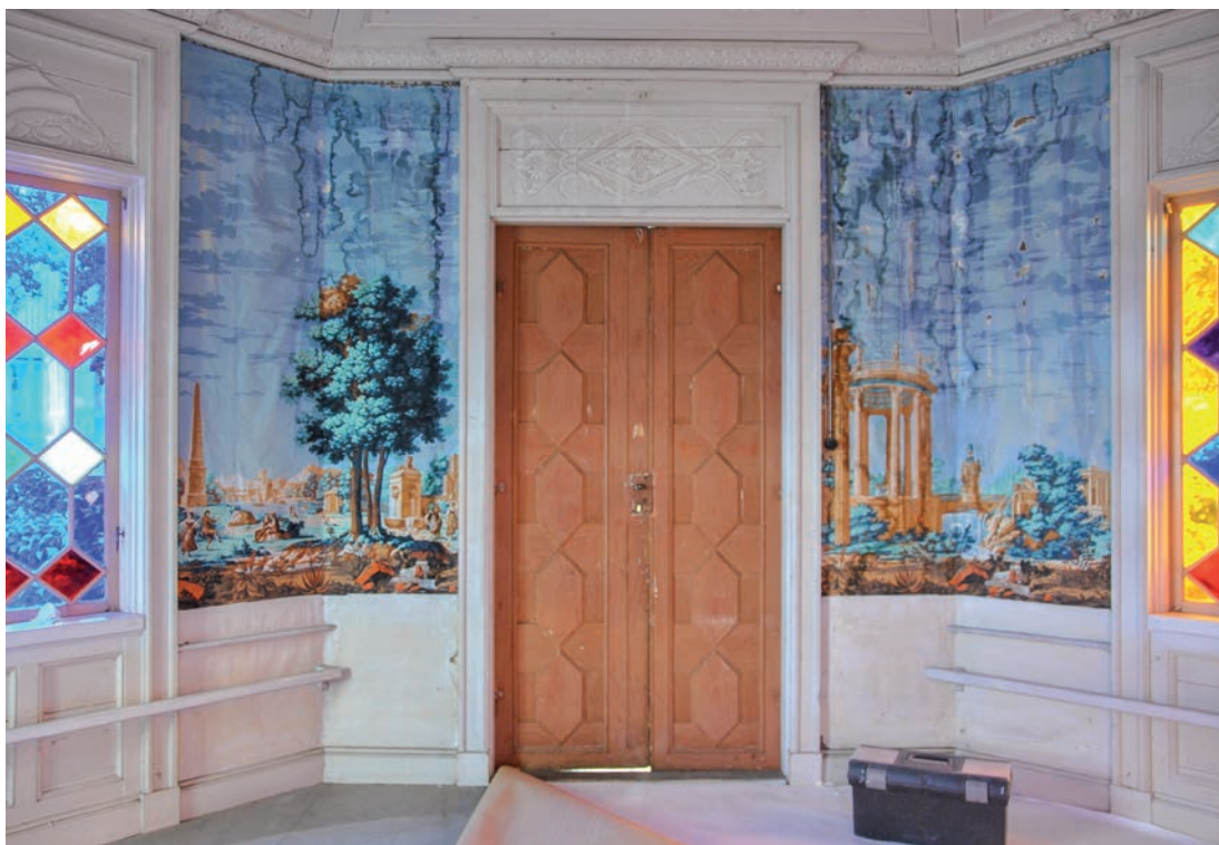
Paviljongens interiör före konservering av tapeter och målning av snickerier. Tapeterna har stora missfärgningar efter fuktproblematik och även hål efter insektsangrepp. Foto: Emelie Mattsson (SLM D2018-0632)
