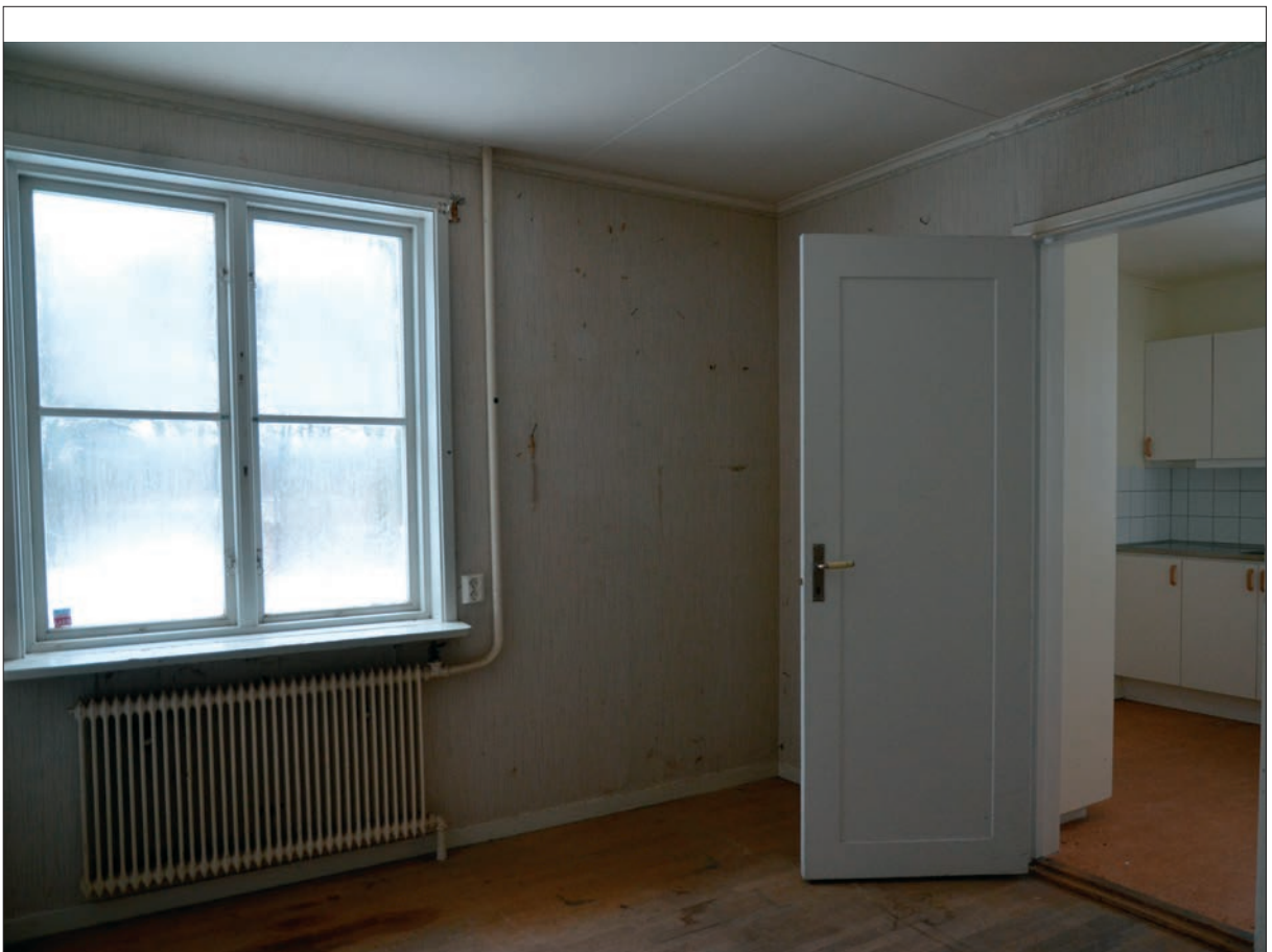
42. Vy av sovrummet som ligger intill köket, fönstret vetter mot baksidan. Läggmärke till den tidstypiska 1940-tals dörren med bakelithandtag (Slm D2016-0044).
