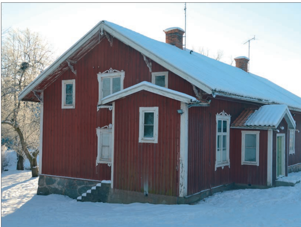
12. Stora skolan, nordöstra gaveln. Den tillbyggda entréfarstun tillkom på 1940-talet (Slm D2016-0015).
