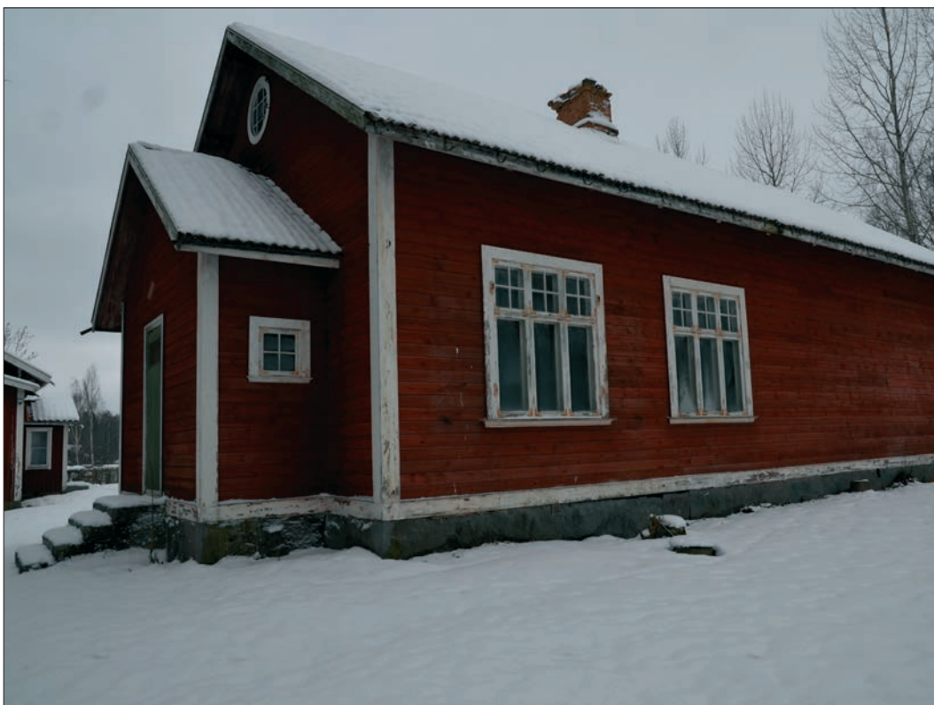
68. Småskolan sedd från baksidan. Huset bevarar ursprunglig arkitektur. De två sexluftsfönstren har småspröjsade övre bågar vilket är tidstypiskt för jugendperiodens stilideal (Slm D2016-0068).
