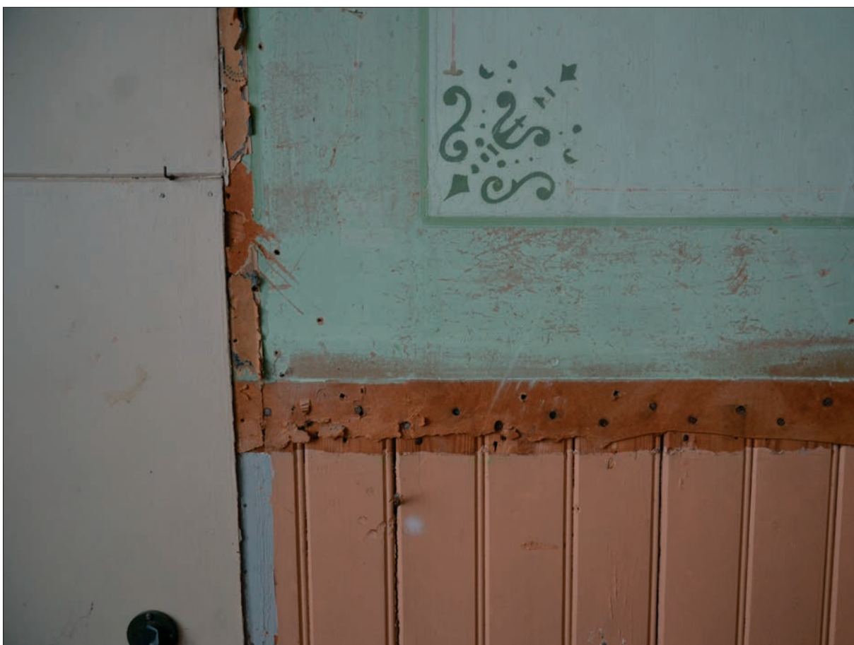
79. Bakom skivtäckningen finns den ursprungliga pärlspontpanelen bevarad. Ovan limfärgsmålade och schablonmålade pappspänning (Slm D2016-0079).
