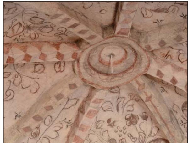
25 Rökrören kopplade till brandlarmsinstallationen är märkbart mindre synliga efter att valvens rengjorts. (Slm D2014-597).
