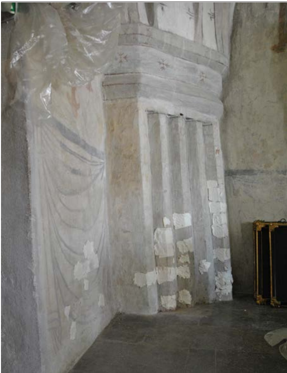
20 Saltutdrivning ur valvpelarna i koret 2014-03-21 (Slm D2014-592).
