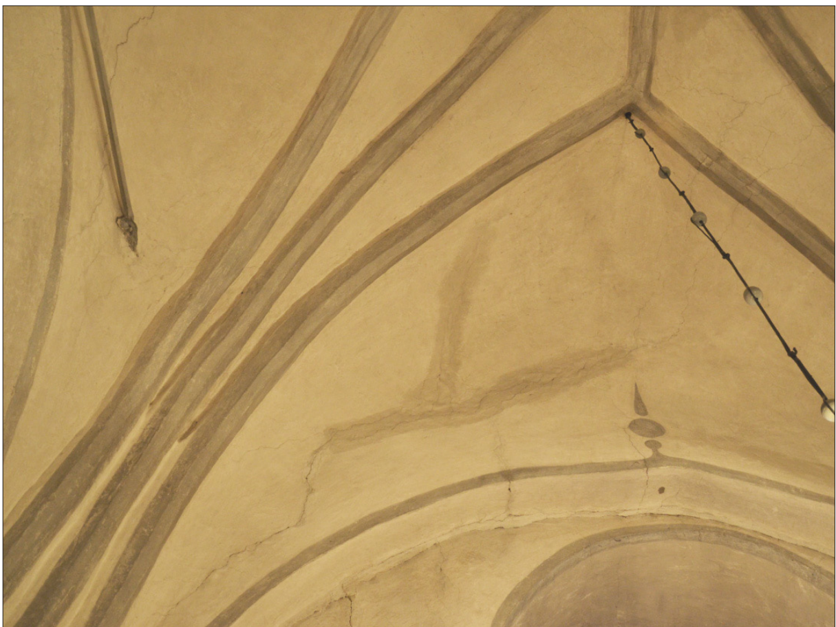
8 En av de södra valvkapporna före åtgärder. En större putsspricka samt en gammal väl synlig retuschering (Slm D2014-581).
