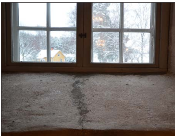
15 Cementhaltiga lagningar förekom i långhusets fönsternischer. (Slm D2014-587).
