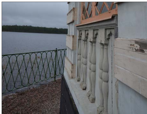
7 Balustraden under fönstren. Horisontellt liggande brädor utgör illusionistisk tegelrusticering. (Slm D2013-634).
