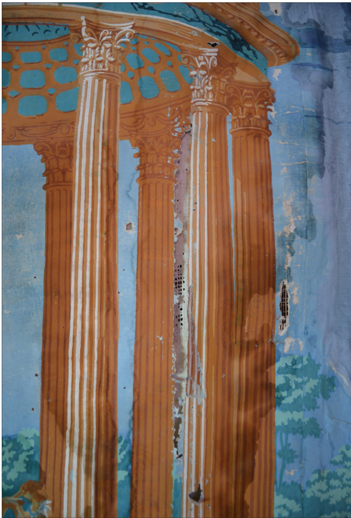
34 Närbild av skadorna i limfärgstapeten (Slm D2013-653).
