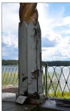
29 Den yttre kolonnen på höger sida är illa åtgångnen (Slm D2013-651).
