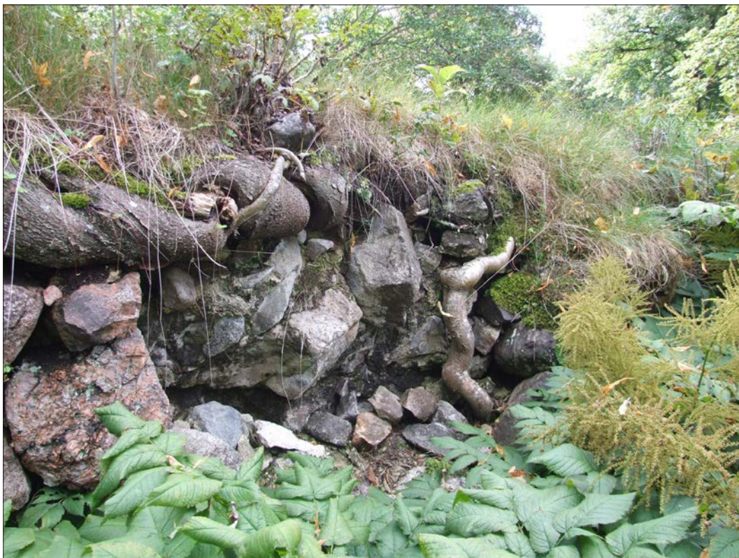
6 Trädrötter hade växt på muren och in mellan stenarna. Bruksmurens norra sida, östra delen (Slm D2013-693).
