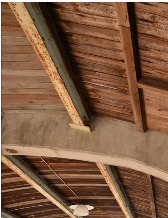
43 Takbalkarna är rostangripna och panelen täckt med svartalger (Slm D13-517).
