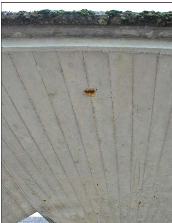
45 Trappornas betongkanter har kraftig moss- och lavpåväxt. (Slm D13-519)
