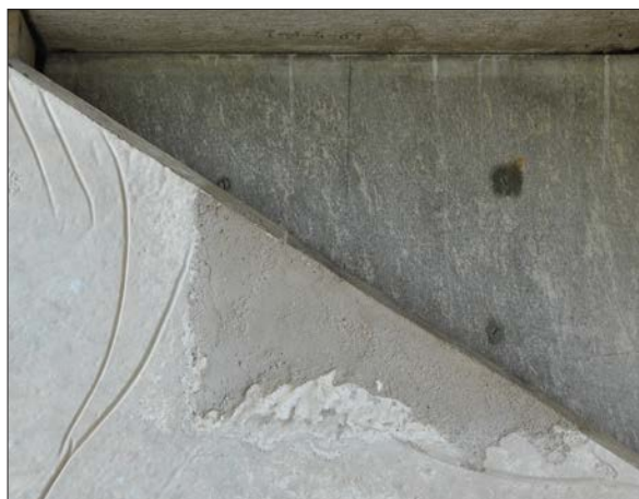
40 En tidigare ovarsam lagning av betongskada. Lagningen är varken till färg eller struktur anpassad efter befintlig betongyta. (Slm D13-514).
