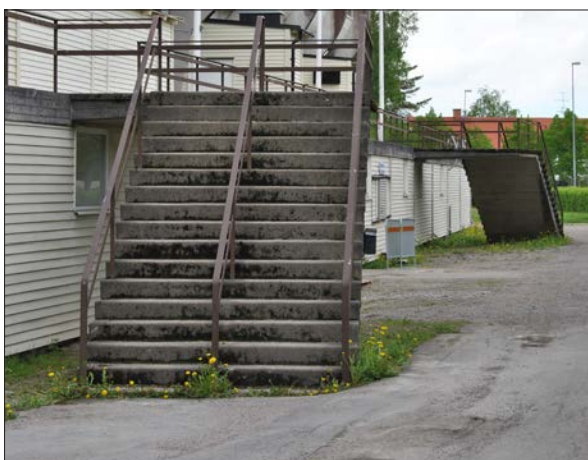
39 Vegetation på och kring grunden och trapporna håller kvar fukt som kan orsaka vittringsskador i betongen (Slm D13-5013).
