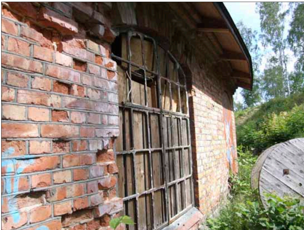
33 Fönsterparti mot baksidan. Glaset är krossat. Delar av fasaderna är nedklottrade.
