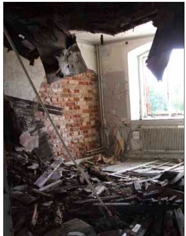
95 Nedrasat bjälklag i rum HöE.
