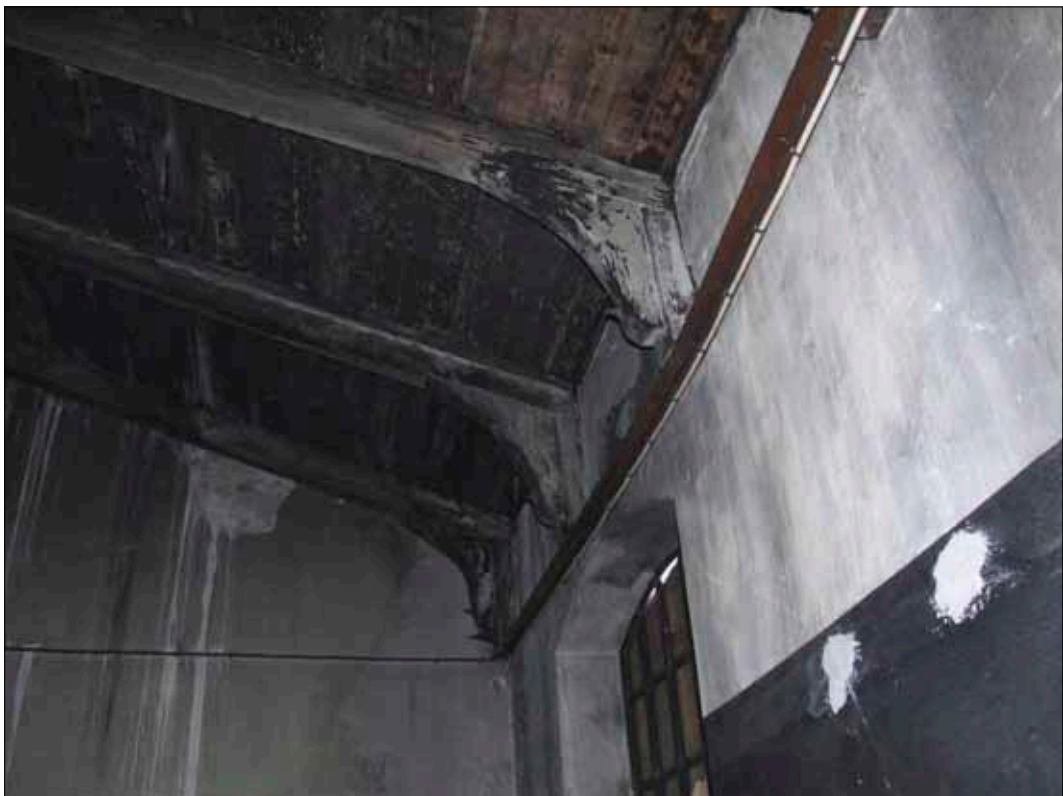
61 Takstolarnas upplag i lokstall 3.
