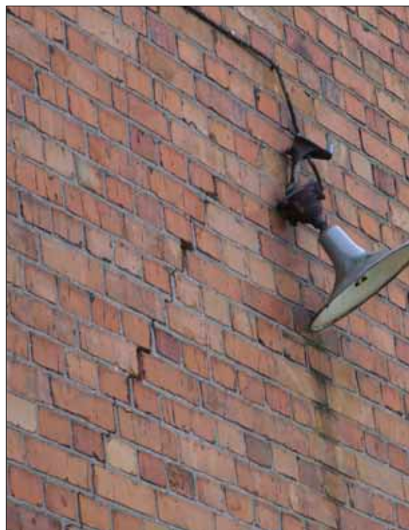
35 Spricka i lokstallets gavel mot väster.
