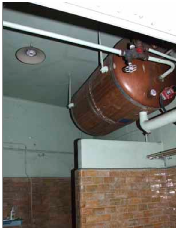
70 Varmvattenberedare i duschen innanför omklädningsrummet i stall 12, rum 12D.
