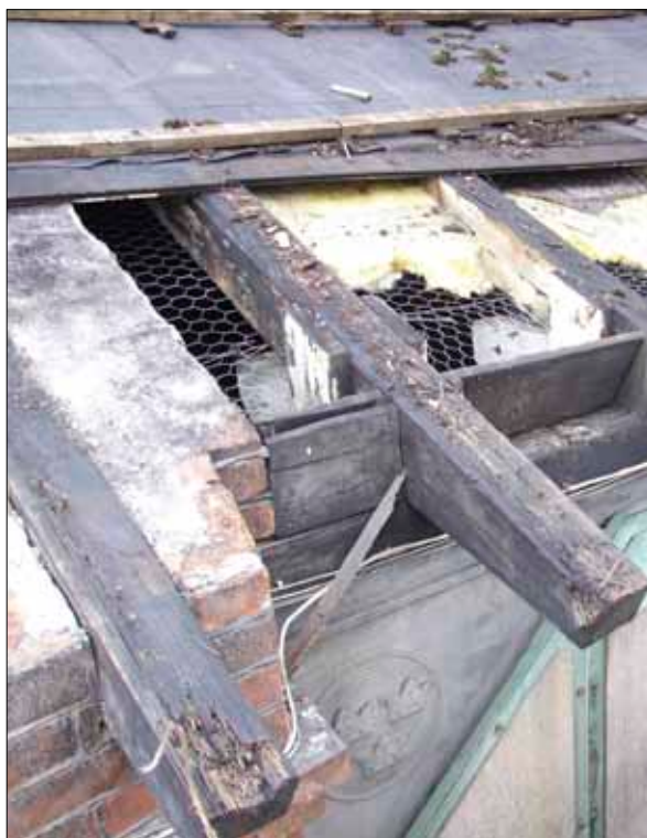
34 Rötskadade takstolskonstruktioner ovanför lokstall 13 under pågående reparationsarbeten.
