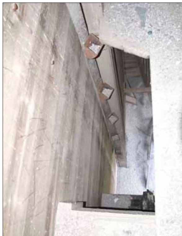
82 Detalj av "paternosterverket" som transporterar sanden till övre våningen.
