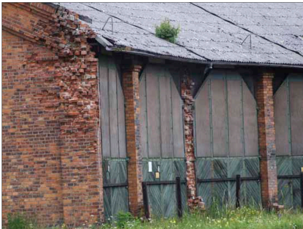
31 Sönderfrusna tegelmurar, sydvästra gaveln av lokstallet och stall 1-4.
