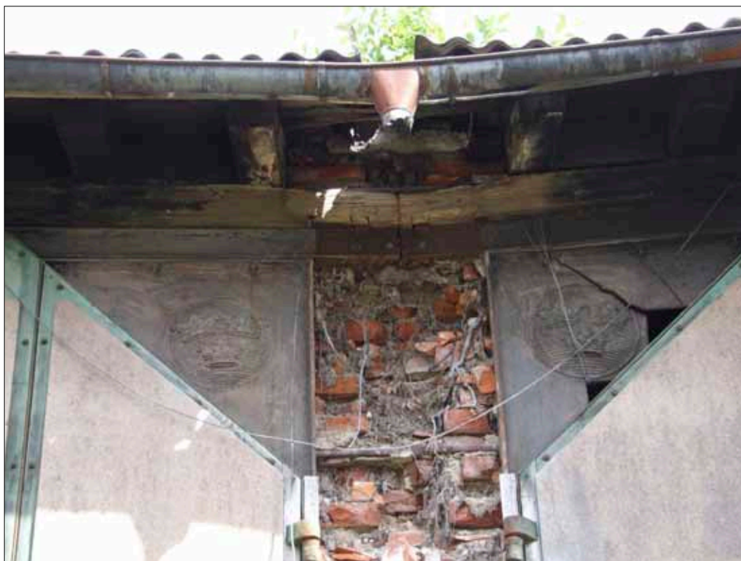
32 Den murade pelaren mellan portarna. Rötter från buskar som växer på taket har trängt in i muren. Högra gjutjärnsplattan har spruckit.
