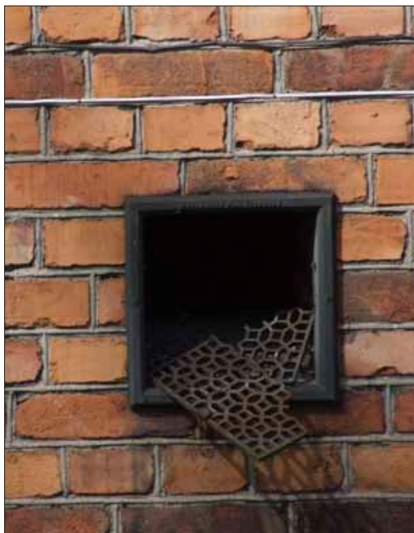
49 Trasigt ventilationsgaller i högdelen.
