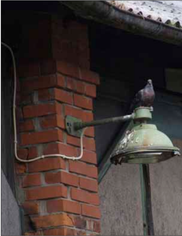
28 Detalj av väggarmatur placerad på murpelaren mellan ingångsportarna i lokstallet.
