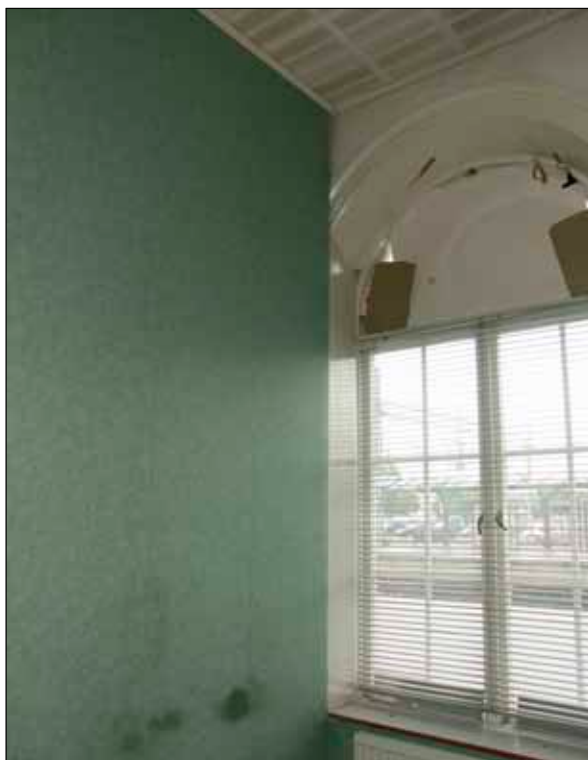
34 Sekundär vägg uppsatt i rum 102, vilket inkräktar på fönsternisch och foder.
