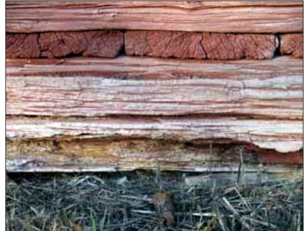
89 Skada på syllstocken på byggnadens sydöstra långsida (Slm D09-829).
