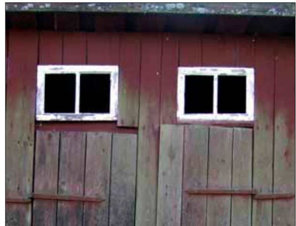
111 Fönsterglas saknas vid utedassen (SIm D09-849).
