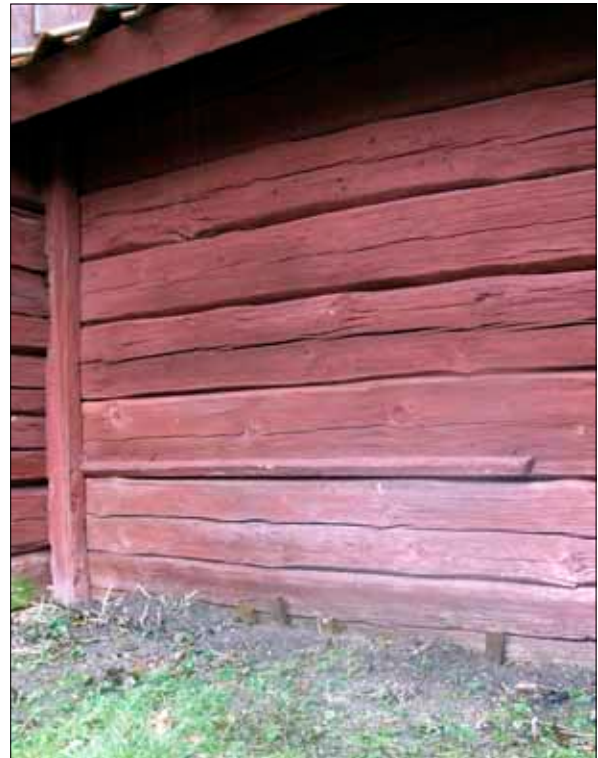
84 Den höga marknivån på byggnadens sydöstra sida har orsakat rötskador på syllstocken (Slm D09-824).
