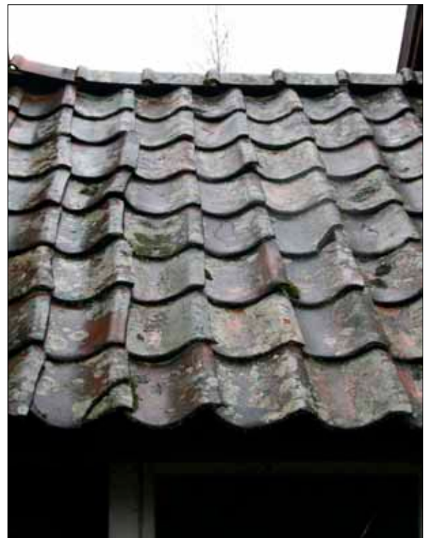
85 Skadade pannor på byggnadens nordvästra takfall (Slm D09-825).
