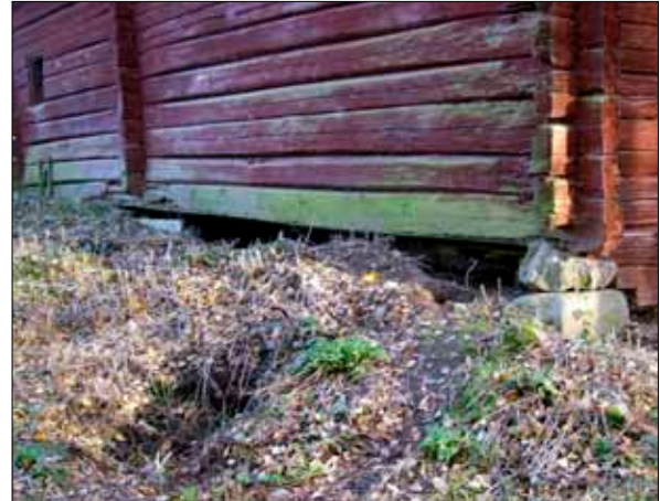
104 Skador orsakade av grävling (Slm D09-842).
