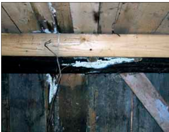
96 Rötskador orsakade av läckande tak (Slm D09-835).
