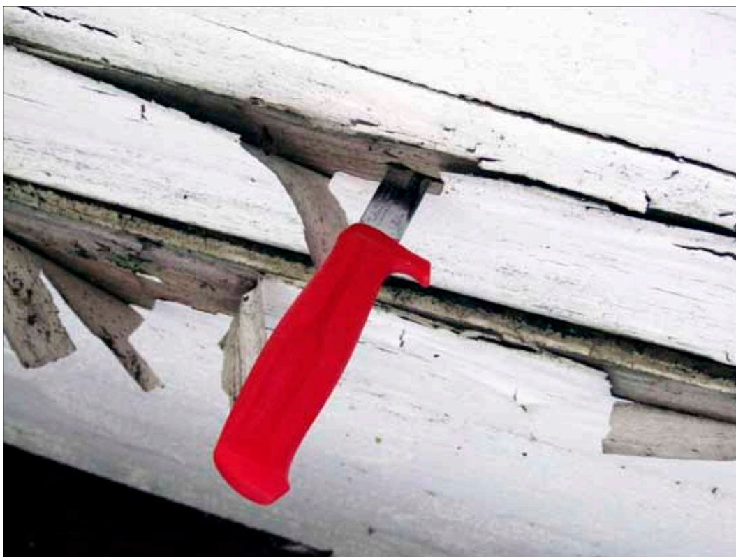
116 Röttskadat virke i undertaket på förstuvisten vid hus 2 (Slm D09-853).
