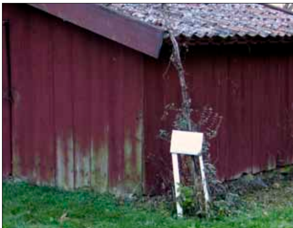
95 Hög marknivå i anslutning till byggnaden har orsakat rötskador på panelens nedre delar (Slm D09-766).
