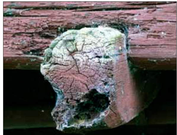
90 Skada på svalgångens bärande bjälke (Slm D09-830).
