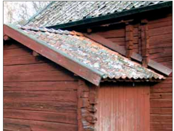
99 Byggnadens tak har en del spräckta takpannor, framför allt på det nordöstra takfallet (Slm D09-769).
