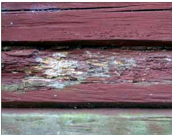
87 Angrepp av traskadeinsekter på byggnadens nordvästra långsida (Slm D09-827).
