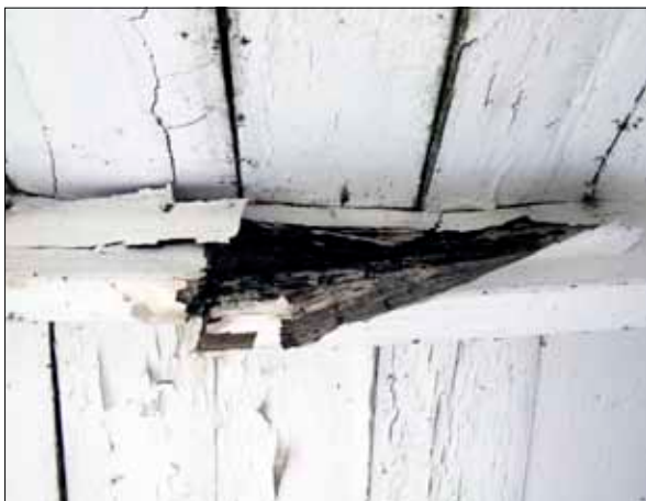
83 Rötskada på förstukvistens undertak (Slm D09-823).
