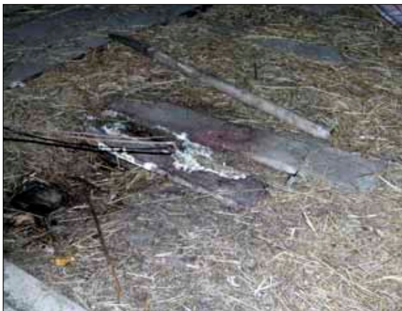
107 Rötskador i golvet orsakat av takläckage (Slm D09-845).
