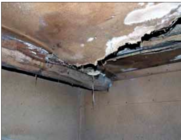
109 Rötskador i taket i rum 1003 (Slm D09-847).
