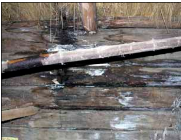
108 Rötskador i timmerväggen orsakade av tak- läckage (Slm D09-846).
