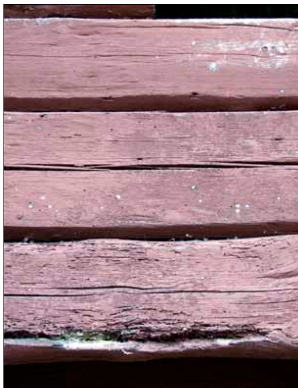
94 Angrepp av träskadeinsekter på svalgångens yttre vägg (Slm D09-834).
