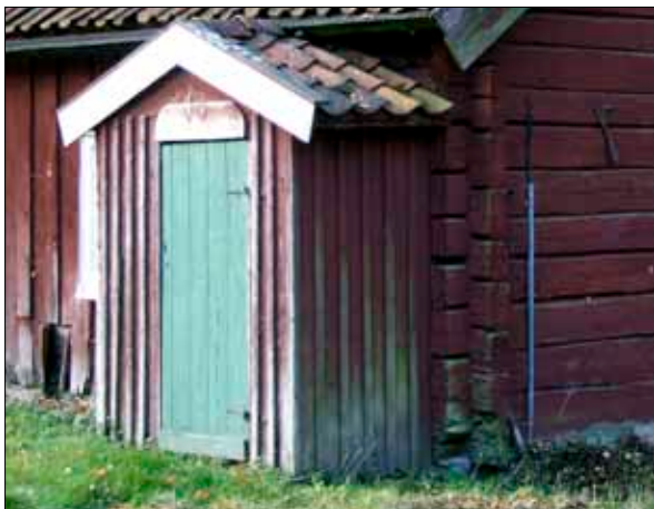
113 För hög marknivå vid byggnadens norra del (Slm D09-850).
