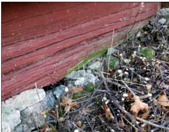
103 Buskage och sly har vuxit tätt in på byggnaden (Slm D09-841).
