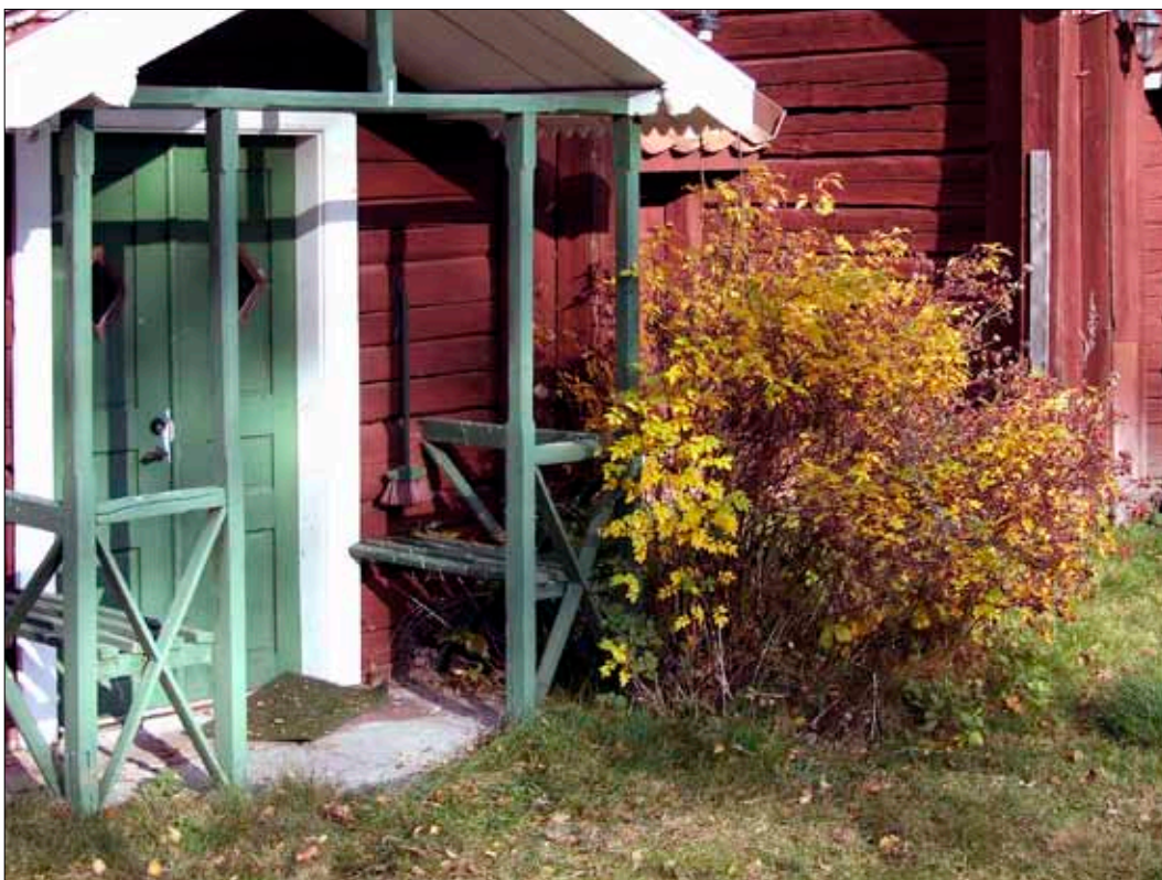
76 Marknivån är generellt för hög i anslutning till byggnaderna (Slm D09-817).
