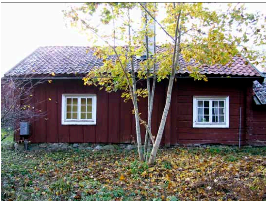
77 Byggnadernas fönster är generellt i behov av renovering. Hus 2 från nordväst (Slm D09-757).
