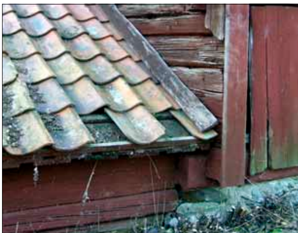
102 Nedfallna tegelpannor på det nordöstra takfallet (Slm D09-840).
