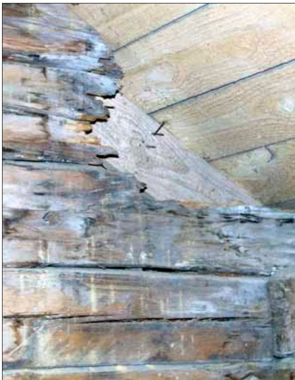
92 Rötskador i det nordvästra hörnet av rum 504, från öster (Slm D09-832).
