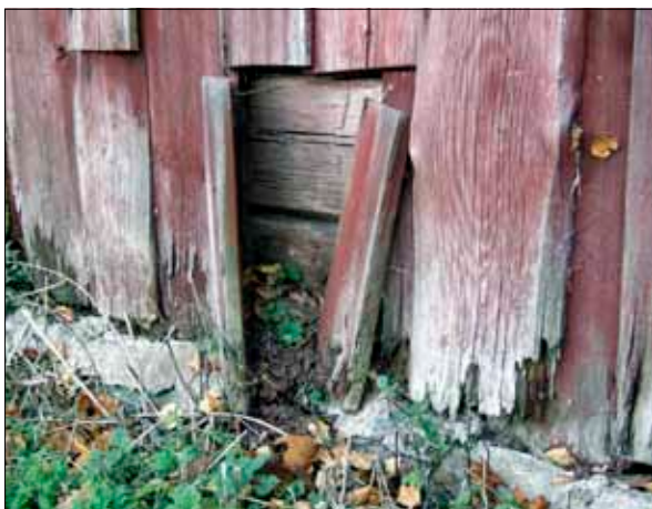
114 Rötskadad panel på byggnadens nordöstra fasad (Slm D09-851).
