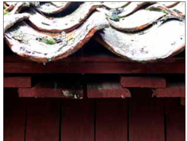
100 Rötskada på underlagstaket (Slm D09-838).
