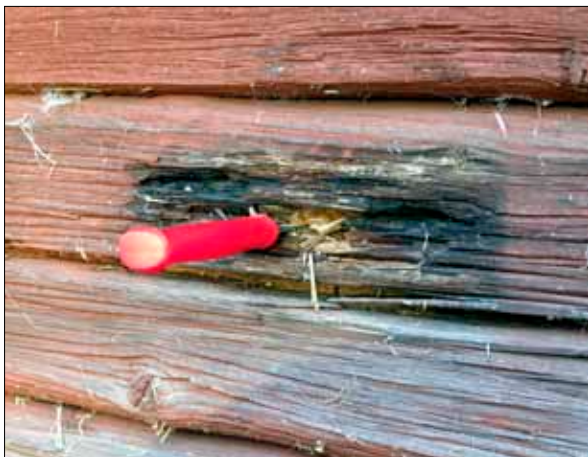
101 Rötskada på byggnadens sydvästra långsida (Slm D09-839).
