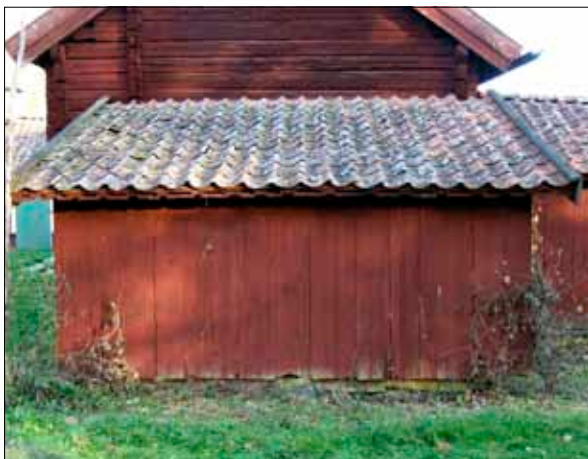
97 Byggnadens tak behöver ses över (Slm D09-836).
