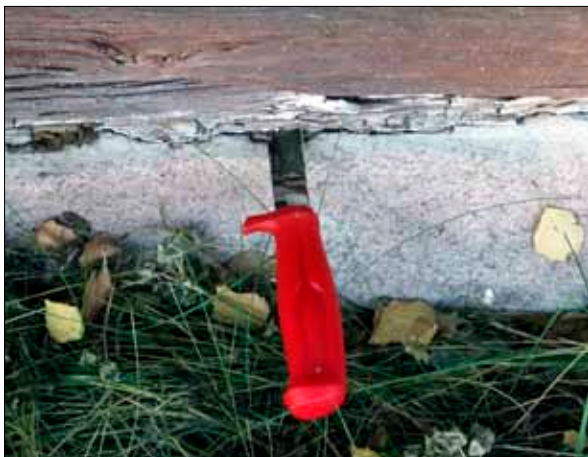
86 Rötskada orsakad av gjutning av grund (Slm D09-826).
