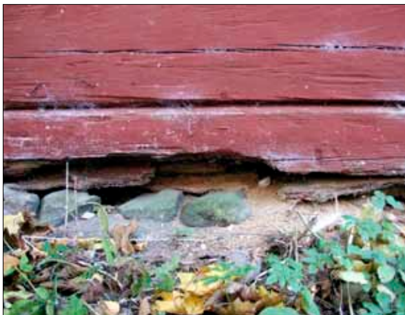
81 Skada på syllstocken på byggnadens nordöstra långsida (Slm D09-821).
