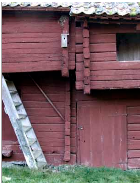
93 Byggnadens östra del har sjunkit i anslutning till hus 5 (Slm D09-833).
