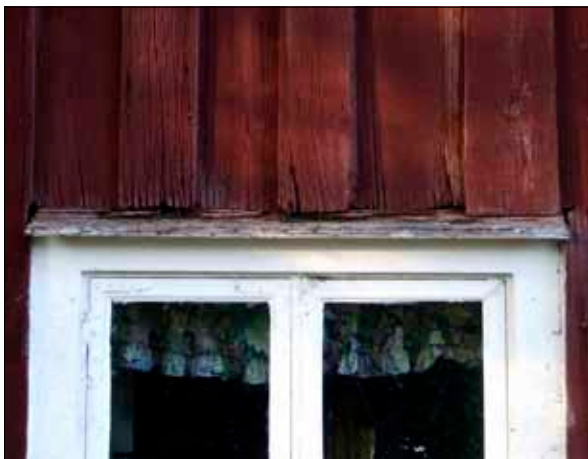
115 Rötskadad fönsterbräda på byggnadens sydöstra gavel (Slm D09-852).
