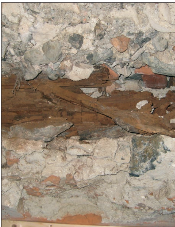
15 I samband med håltagningen noterades det rötskadade hammarbandet (Slm D12-0313).
