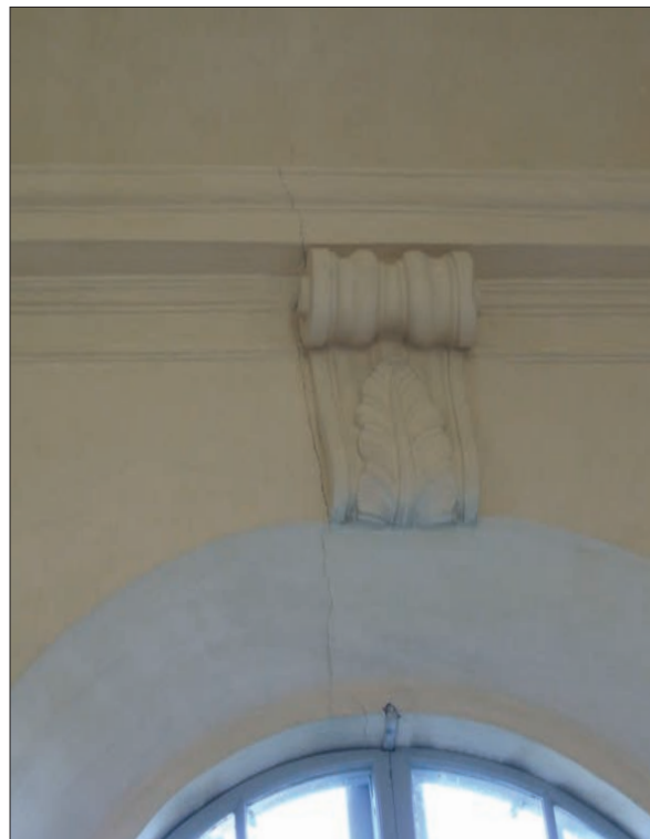
12 En av korets sprickor i fönsternischen före det att putslagning utfördes (Slm D12-0310).
