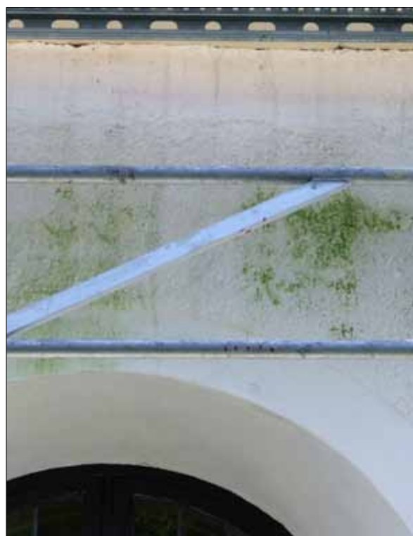
22 Kraftig algpåväxt uppträdde på kyrkans fasader efter kraftiga regnväder som sköljde ned skräp från kyrkans tak (Slm D11-225).
