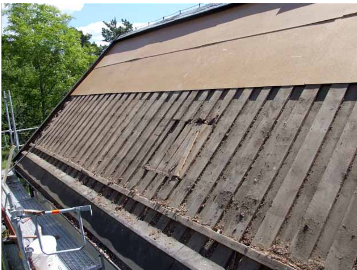
23 I samband med omläggningen av taket på korets södra takfall påträffades en igensatt, okänd taklucka till korets vind. Fotograf Eva Wockatz, Sörmlands museum (Slm D11-226).
