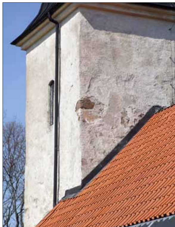
13 Bompartier och partier med nedfallen puts förekom främst på tornet (Slm D11-216).
