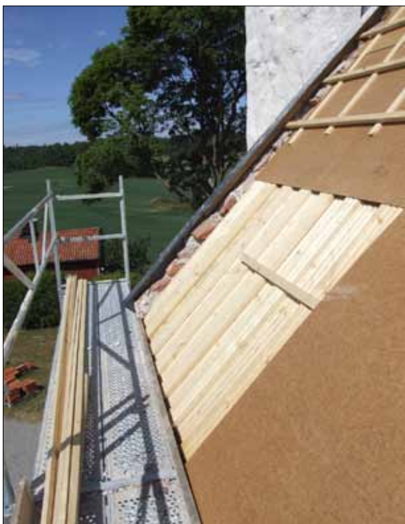
16 Lagade rötskadat parti på långhusets södra takfall. Foto: Eva Wockatz, Sörmlands museum (Slm D11-219).
