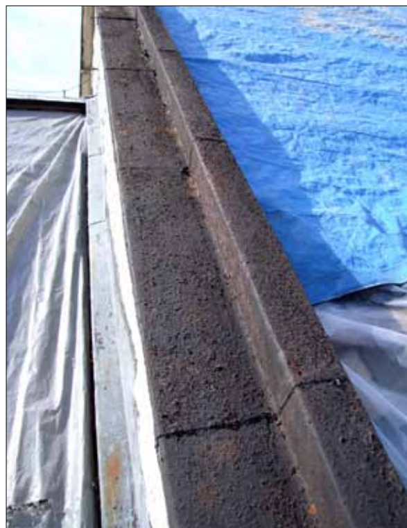
17 Vindskiveplåtarna av svartplåt på långhusets östra gavel var kraftigt rostangripna (Slm D11-220).
