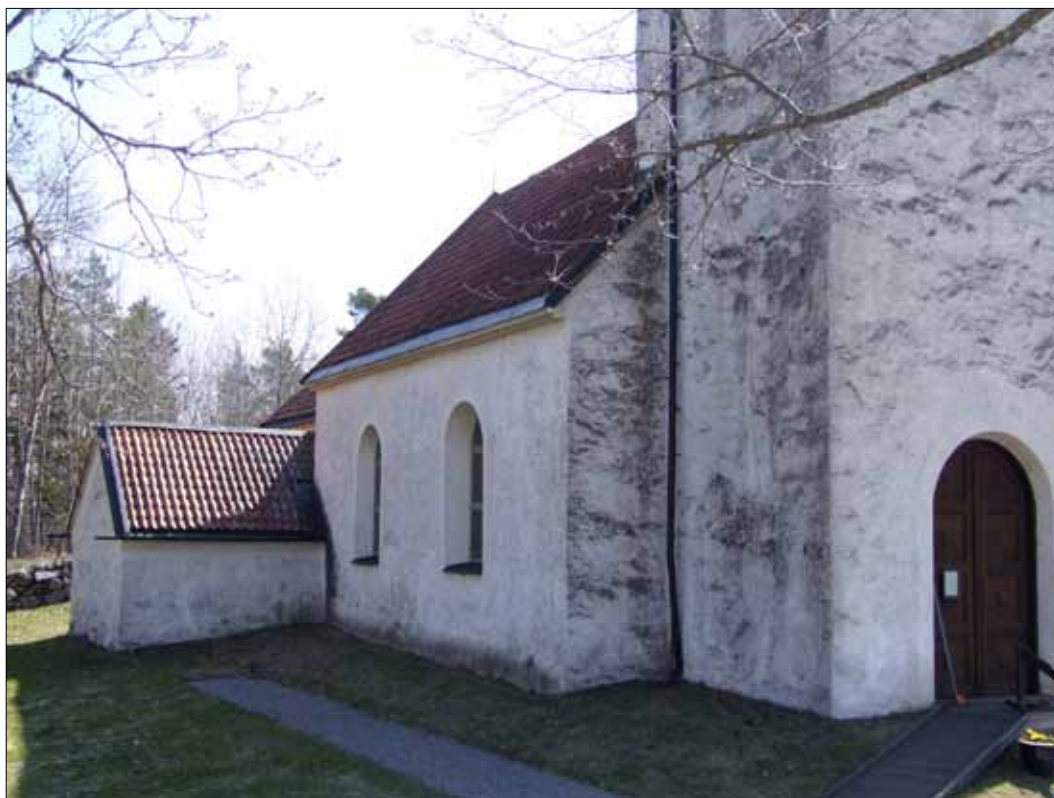
11 Före restaureringen var kyrkans fasader kraftigt nedsmutsade och uppvisade påväxt av alger och lavar (Slm D11-214).
