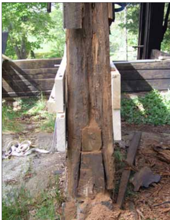
10 Syllen sedd från öster före lagningen. Strävorna var gafflade över syllen och fastspikade med spik/järn/bult (Slm D11-595).
