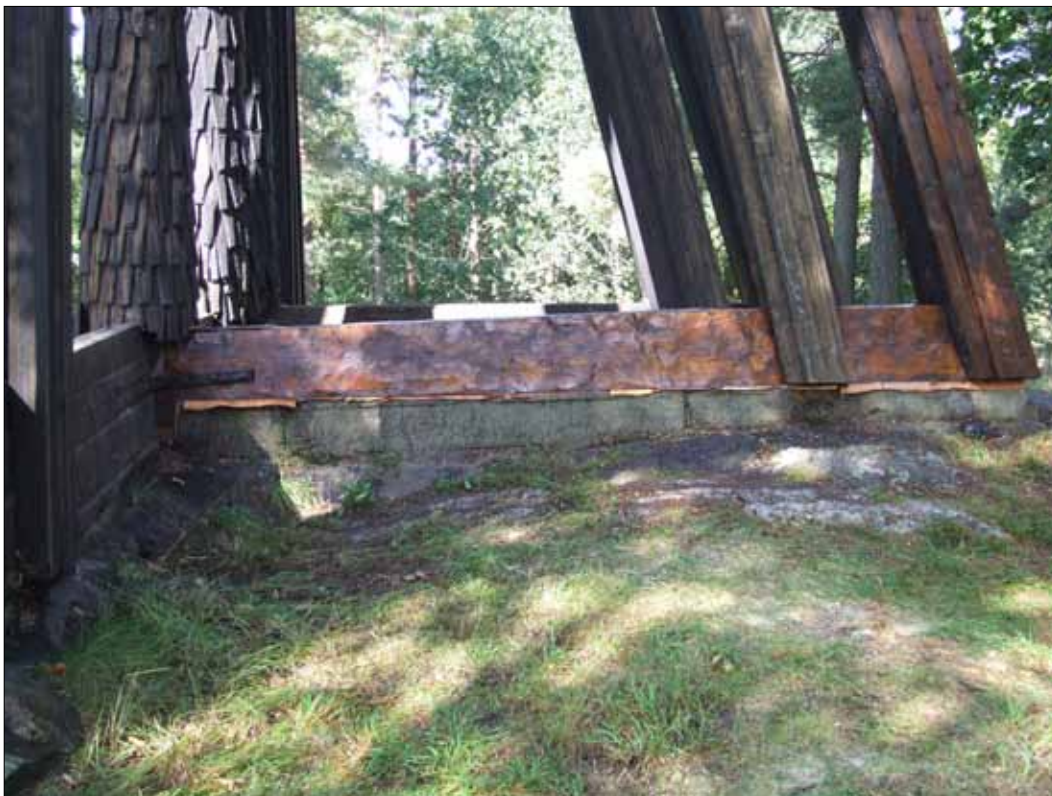
14 Östra delen av södra syllen bilades och lades på näver. Foto efter lagning och tjärning. Arbetet utfördes av Emanuel Jakobsson, Historiskt trähantverk (Slm D11-599).
