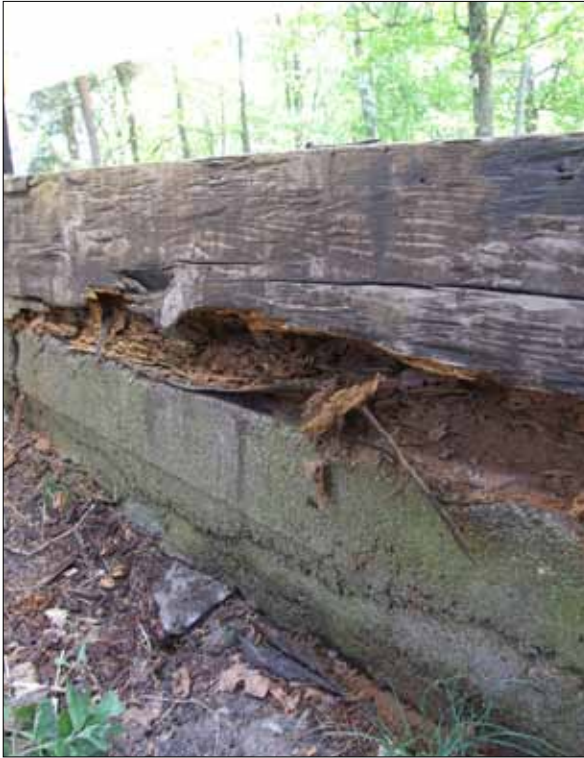
3 Syllstocken vilar på en äldre gjutning. Under syllstocken låg ett lager papp (Slm D11-588).
