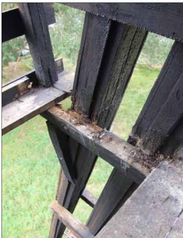
8 Rötskada på bärande bjälke i söder till klockplattformen (Slm D11-593).
