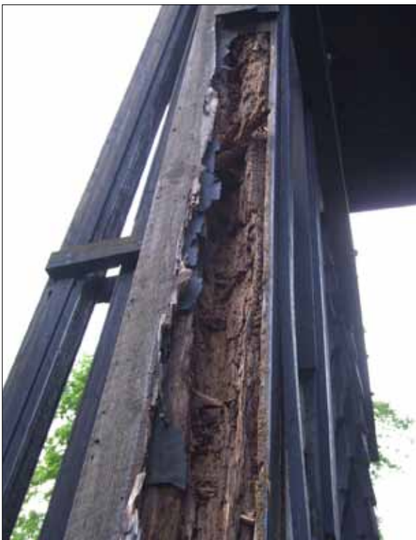
5 Yttre snedsträvan som går ned till samma syll visade sig också vara i dåligt skick (Slm D11-590).
