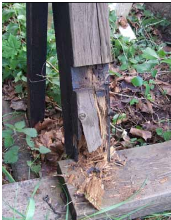
7 Rötskada på stegens nedre del (Slm D11-592).
