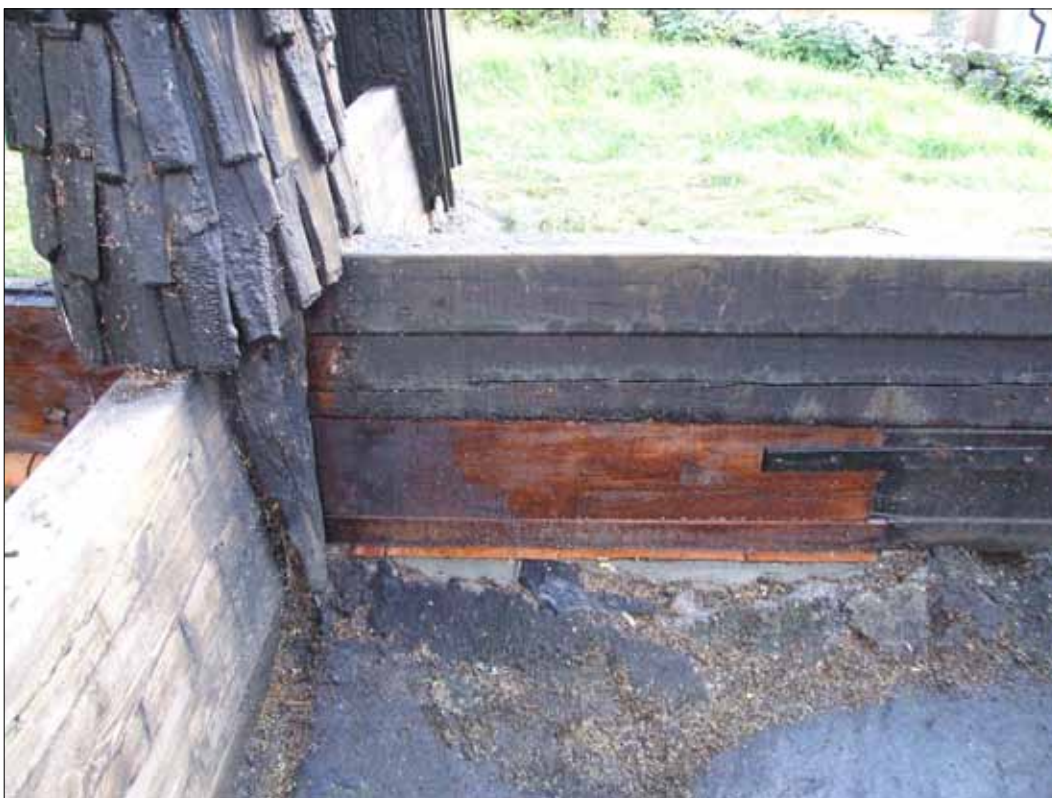
15 Västra delen av södra syllen lagades i med sågat virke som tidigare. Arbetet utfördes av Mats Lundkvist Byggservice AB. Notera den äldre bevarade "gafflingen" av mittstolpen (Slm D11-600).
