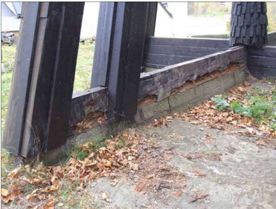
2 Östra delen av södra syllstocken som hade stora rötskador, sedd från nordost (Slm D11-587).
