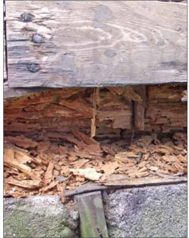
4 Detalj av syllens rötskada (Slm D11-589).
