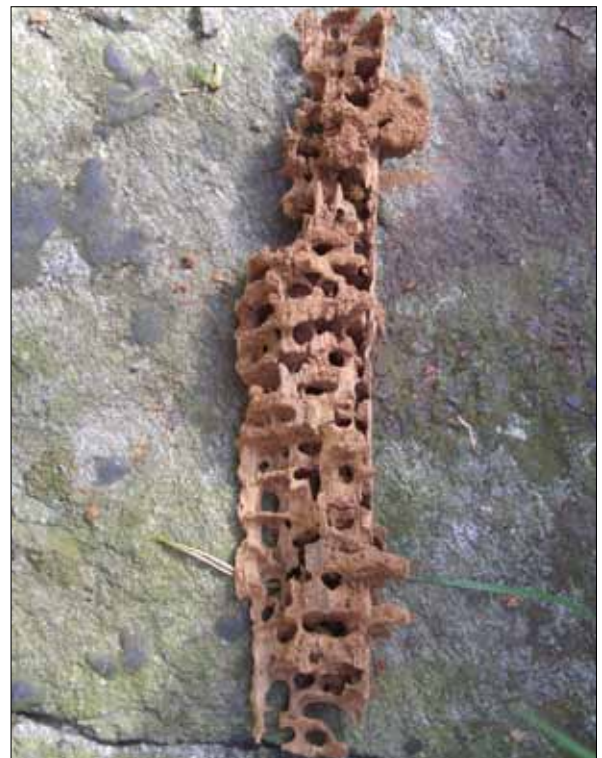
6 Del av det rötskadade virket från snedsträvan, som också var angripet av myror (Slm D11-591).
