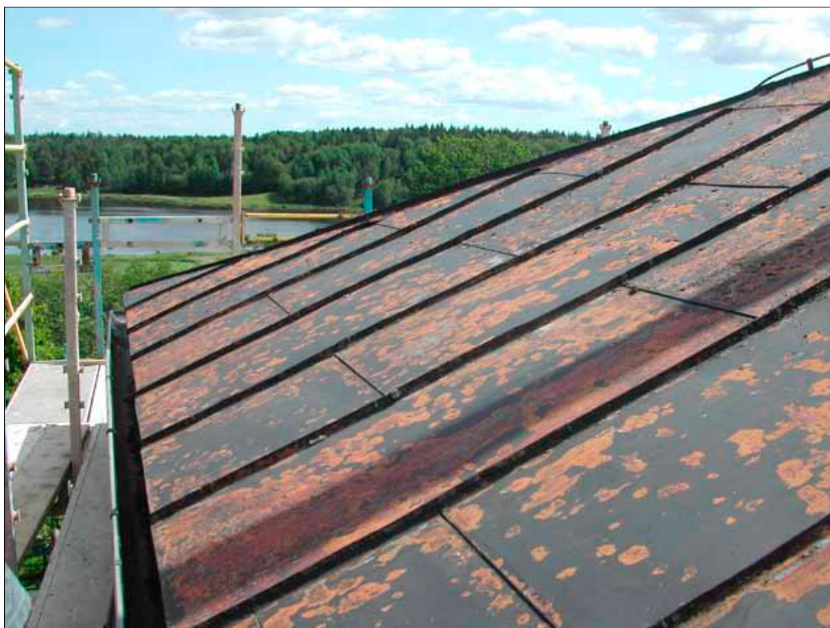
7 Taket på koret var rostigt.
