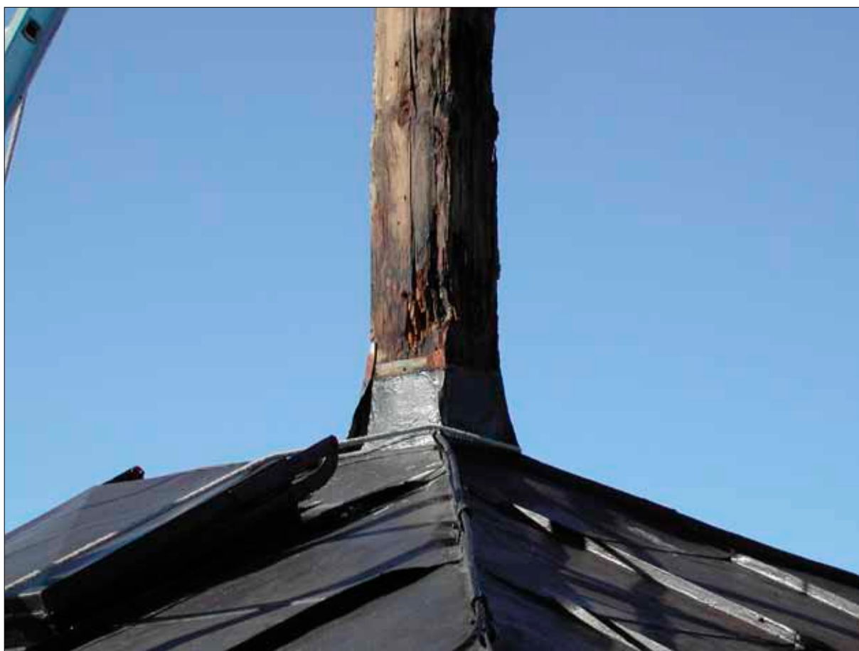
15 När plåten togs bort på det gamla korset syntes rötskadan vid fästet.
