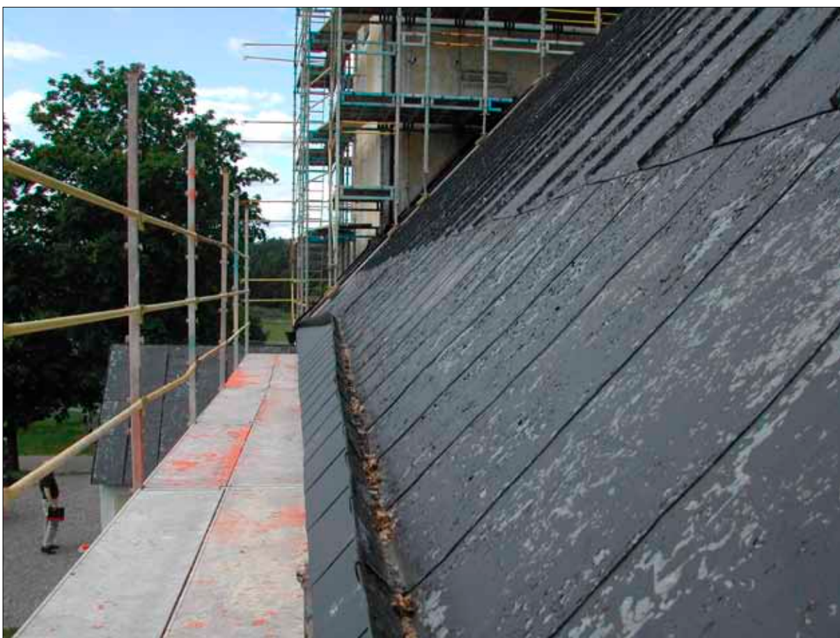
9 Takfärgen på långhuset flagade.
