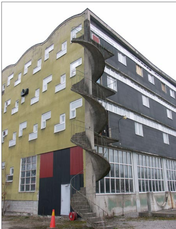
Utrymningstrappan i det södra fabriekshörnet var kraftigt eroderad och kunde inte användas.
