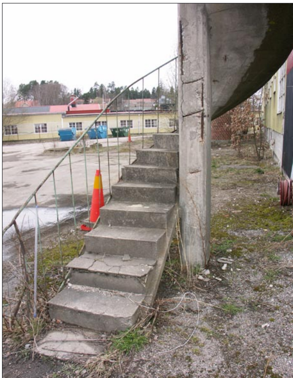
Spiraltrappans nedre del som var söndervitrad.
