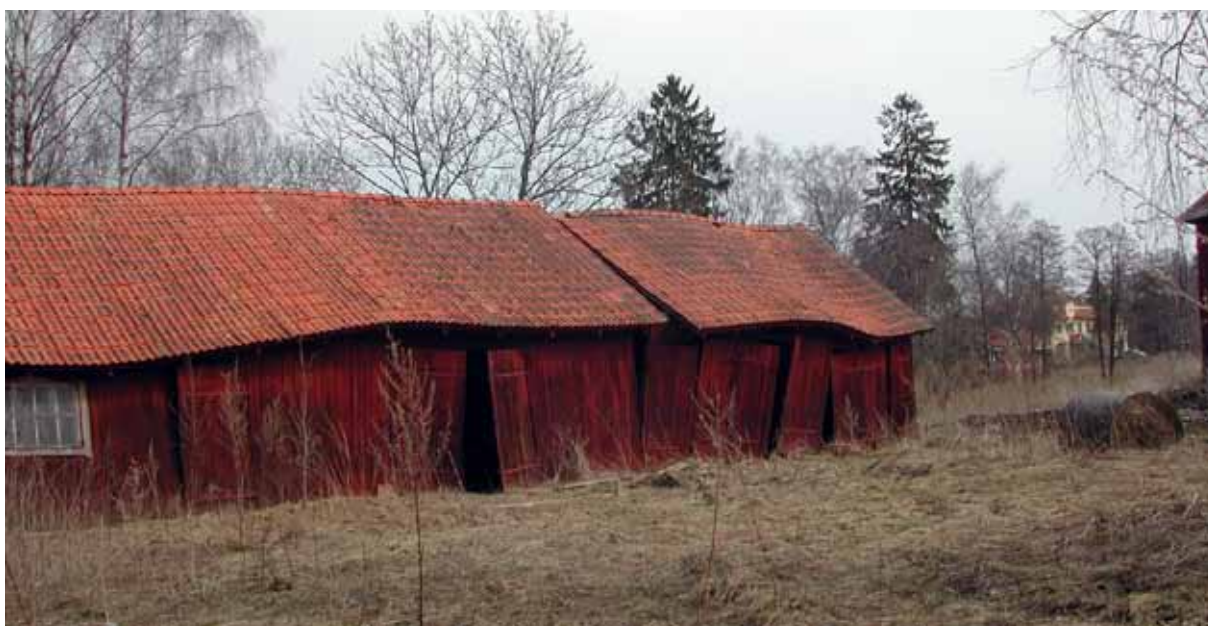
Bild 38. Sågbyggnaden från väster. Taket svackar betydligt.
