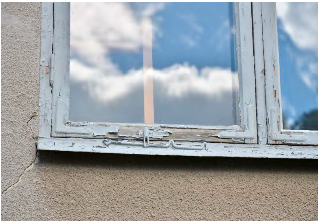
Bild 27. På grund av den goda virkeskvaliteten är fönstren relativt välbehållna trots bristande underhåll. Det som kan misstas för rötskador är till stora delar bara avflagnad färg och delvis bortfallet linoljekitt. Detta åtgärdas genom skrapning, omkittning och målning med ny linoljefärg. SLM D2022-0374.
