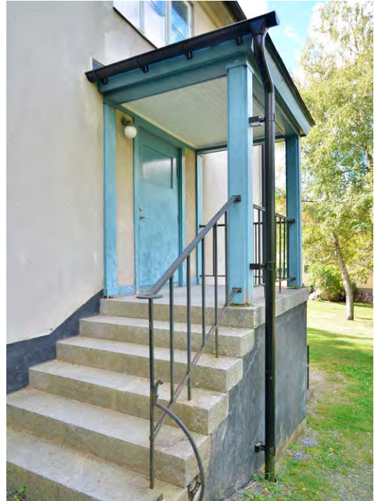
Bild 26. Baksidans (östfasadens) öppna förstuvist med något enklare utformning och med aningen tydligare funktionalistiska karaktärsdrag. SLM D2022-0373.
