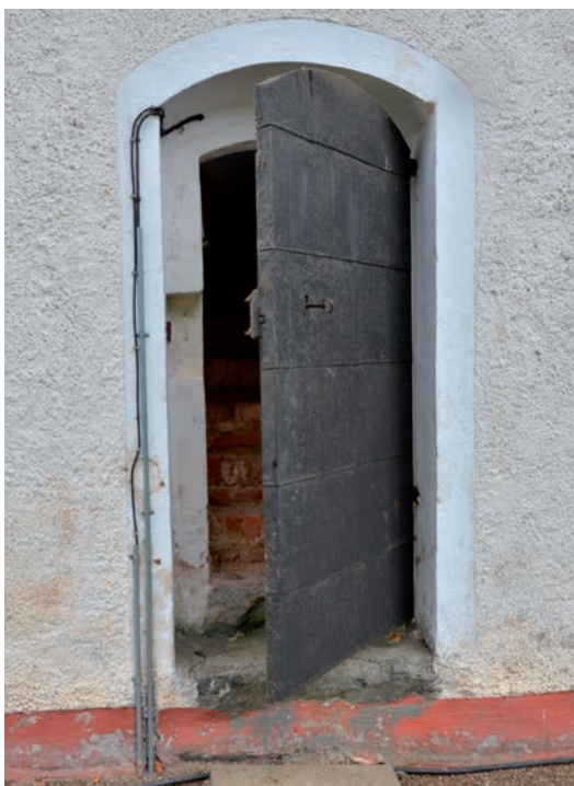
Bild 11. Befintliga elkablar vid ingången till tornet, innan renovering. Foto 2021-08-18. SLM D2022-0075.
