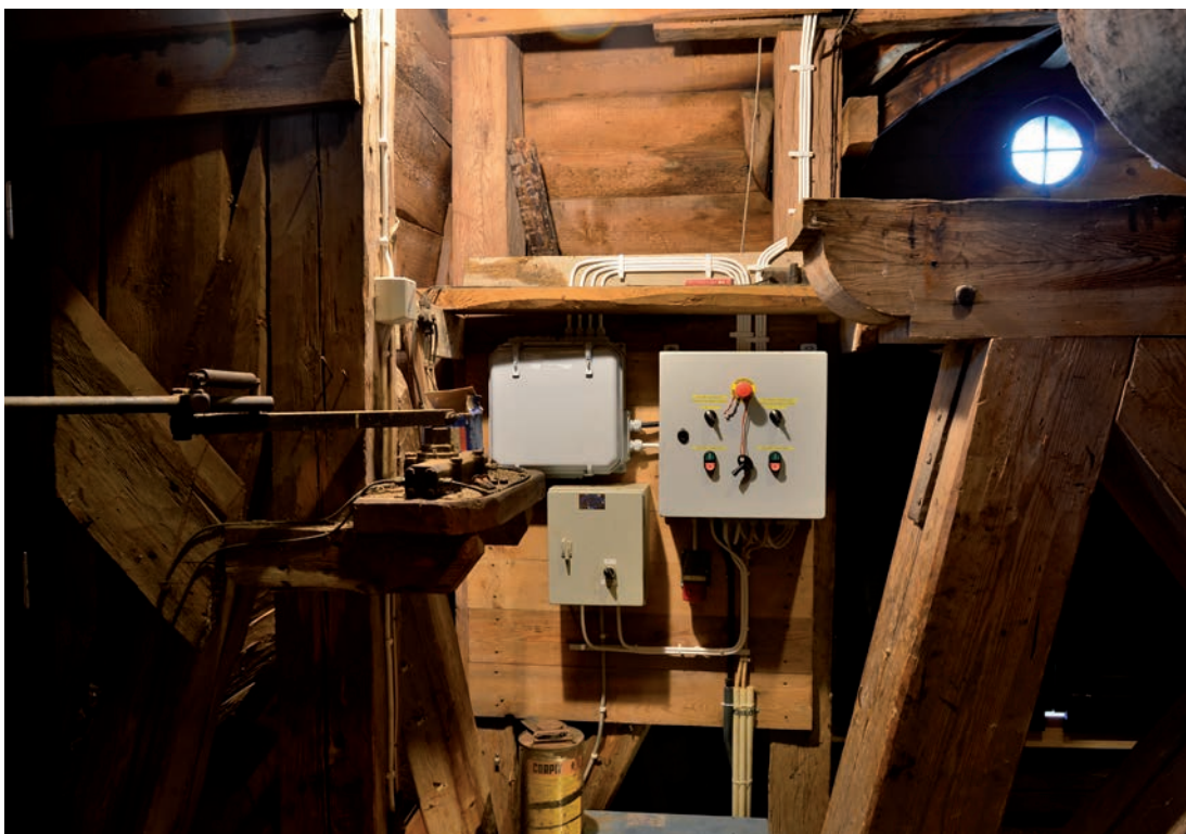
Bild 27. Kabeldragningar och automatik efter avslutade arbeten. Foto 2021-11-03. SLM D2022-0091.
