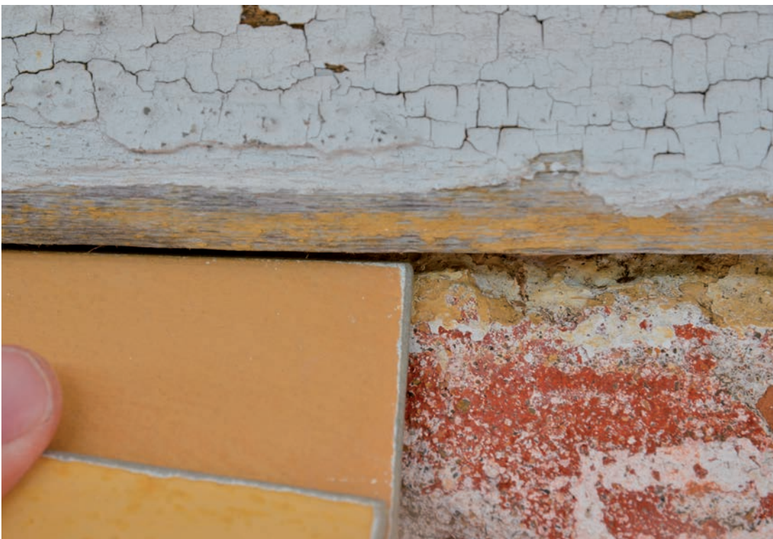
Bild 39. Röda kalkfärgsrester samt gula kalk- och linoljefärgsrester under takfoten mot öster. Foto 2021-08-24. På bilden hålls Oxidgult 920:5 (nederst) samt Obränd terra 46:11 (överst) upp. SLM D2022-0103.
