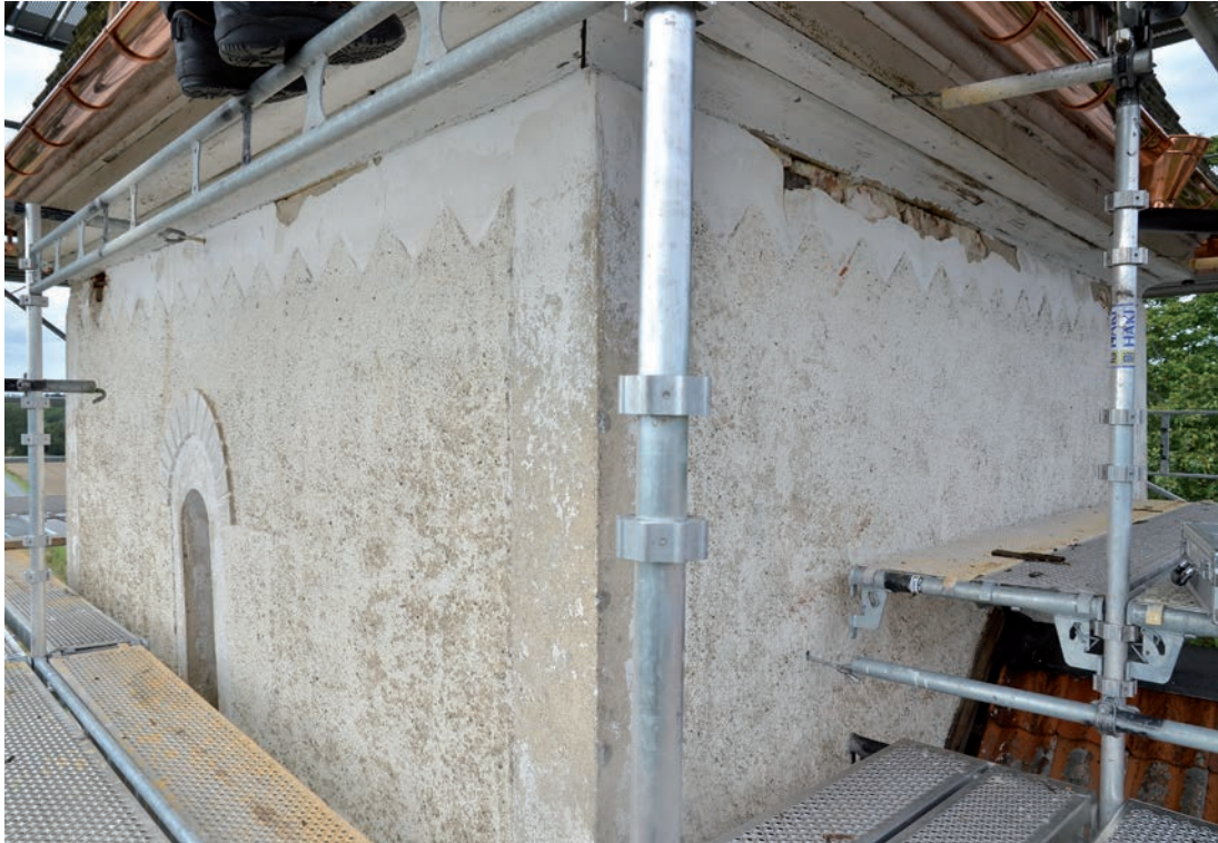
Bild 32. Tornets sydöstra fasader innan renovering. Notera putssprickorna under takfoten till höger i bild (östra fasaden) där rester av röd och gul kalkfärg hittades. Foto 2021-08-24. SLM D2022-0096.
