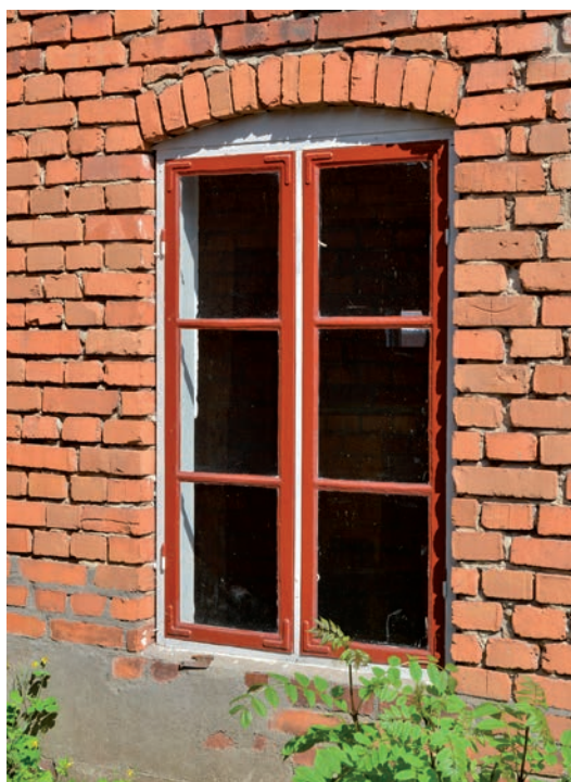
Fig 8. Ett av fönstren på röda byggnadslängans murade väggparti. Tegelmuren saknar bearbetad fog vilket skapar mörka skuggor. Fönsterbågarna som tidigare var vitmålade har nyligen målats röda. (SLM D2019-0279)
