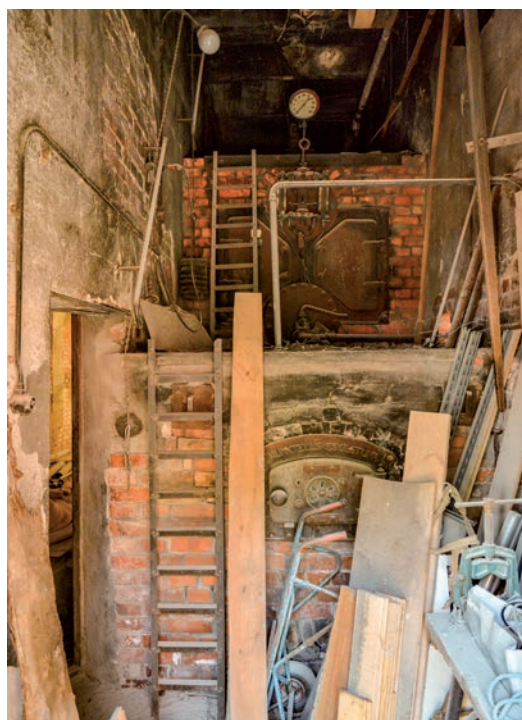
Fig 9. Ångpannan i tegelbyggnadens norra utbyggnad. (SLM D2019-0280)
