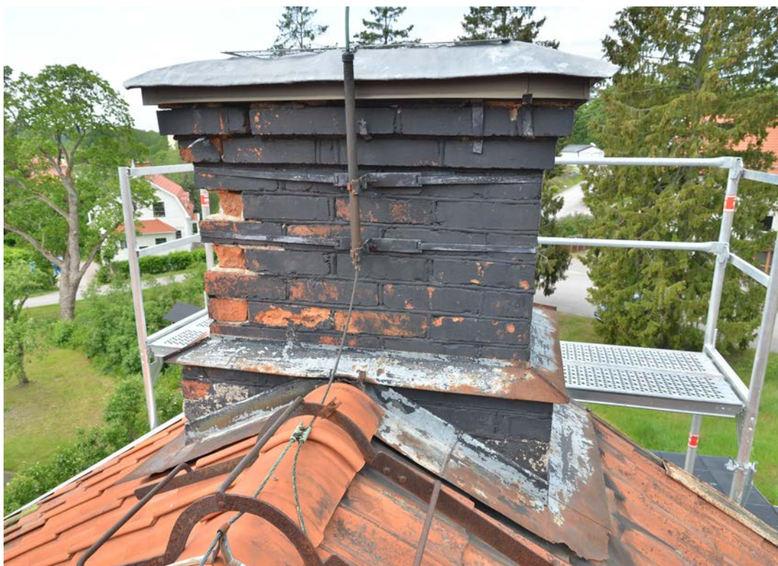
Västra skorstenen, vy mot väster. Notera vittringsskadorna på teglet, gravrostskador på nederbeslagen och åskledaren som är fäst med plåtband. Foto 2019-06-03. SLM D2019-0490.
