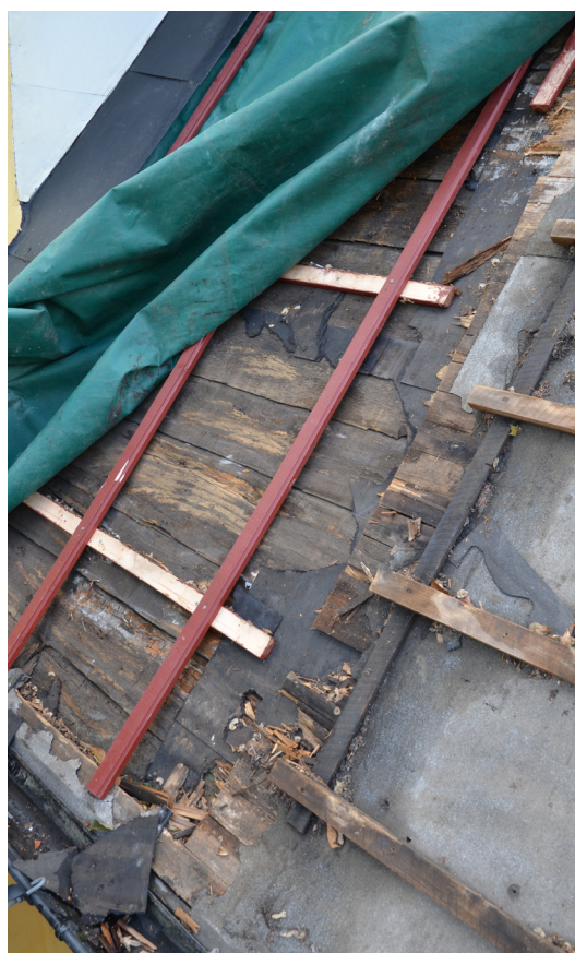
Underlagstaket på norra takfallets västra del var kraftigt rötskadat. Foto 2018-10-03 (SLM D2019-0429).
