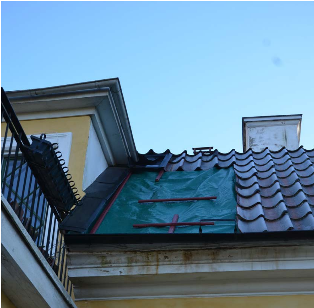
Skadan väster om takkupan på norra takfallet som täckts provisoriskt med en presenning. Foto Kjell Taawo 2018-11-08 (SLM D2019-0426).
