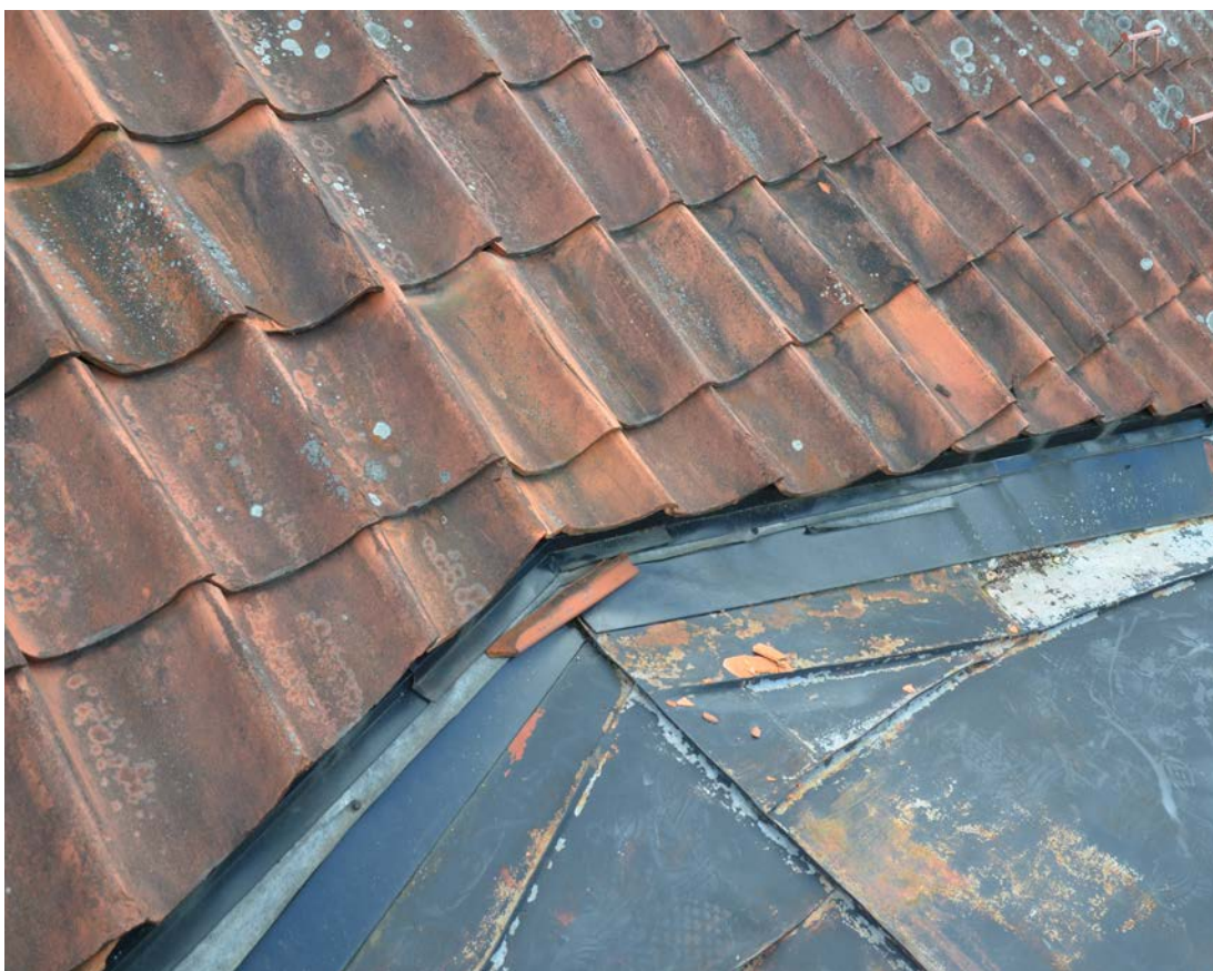
Norra takkupan. Plåtarbetet i takkupans övre del bedömdes kunna utgöra en risk för läckage eftersom det inte var fackmannamässigt utfört. Foto 2018-10-03 (SLM D2019-0433).
