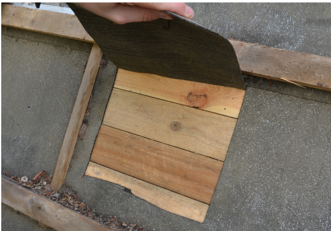
På det norra takfallets östra del var skicket på underlagstaket gott. Foto Kjell Taawo 2018-10-03 (SLM D2019-0430).
