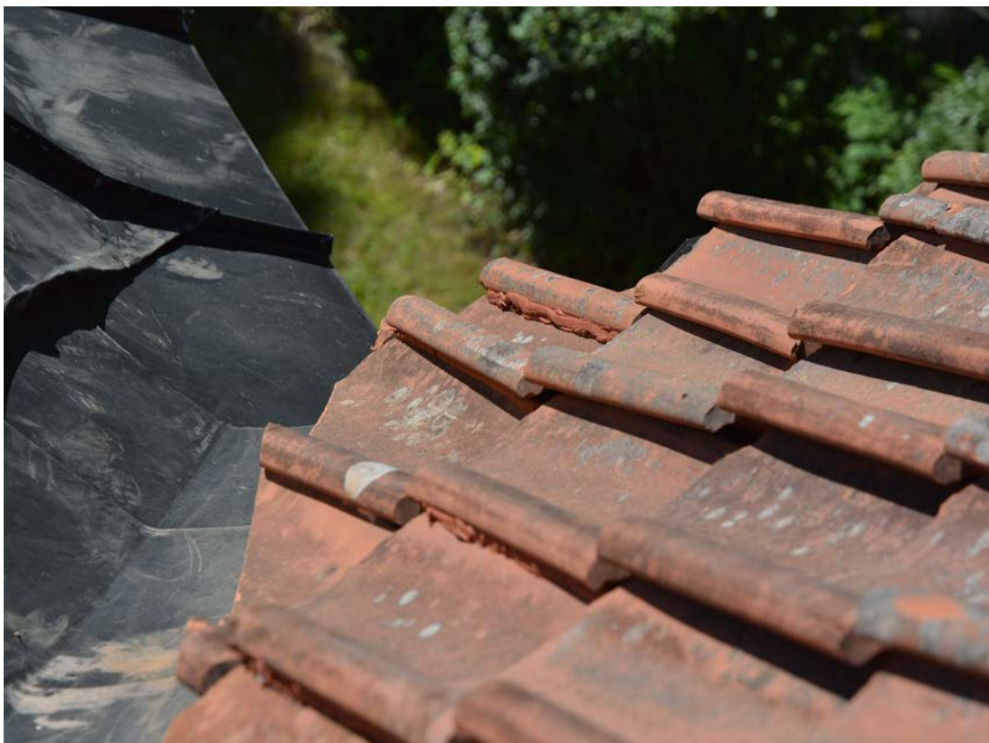
Vid slutbesiktningen iaktogs ifyllningar av röd fogmassa på södra takfallet. Foto 2019-07-03 (SLM D2019-0442).
