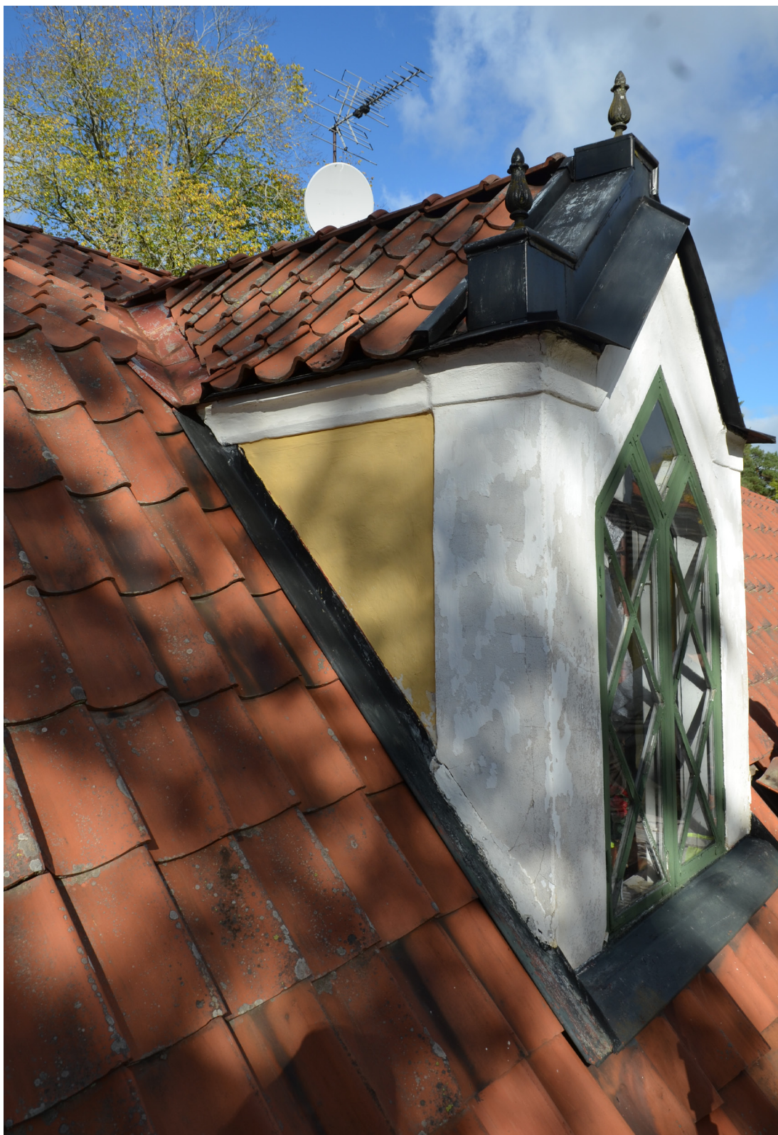
Inträngande regn- och smältvatten hade enligt uppgift från fastighetsägare länge varit ett problem på takkupan mot söder. Anlitad plåtslagare bedömde att kupvinkelrännan inte ledde bort regnvatten på ett tillfredsställande sätt, varpå det misstänktes att regnvatten länge runnit in under takkupans tegel. Notera även skadorna i den vita slätputsen. Foto 2018-10-03 (SLM D2019-0434.)
