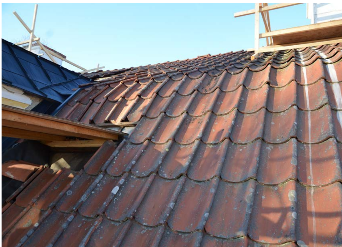
Takfallet mot söder kunde åtgärdas genom endast justering av takpannor samt en avgränsad lagning av underlagstaket och läkten (väster om takkupan). Foto 2018-11-01 (SLM D2019-0439).
