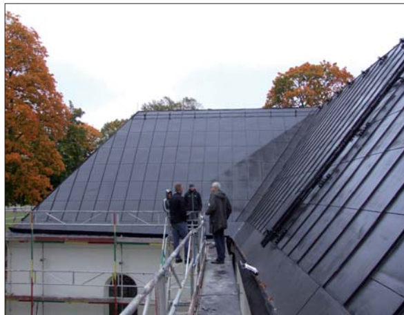
12 Norra takfallet och nykyrkans västra takfall vid slutbesiktningen oktober 2012. Slutresultatet är något ojämnt (Slm D13-0009).
