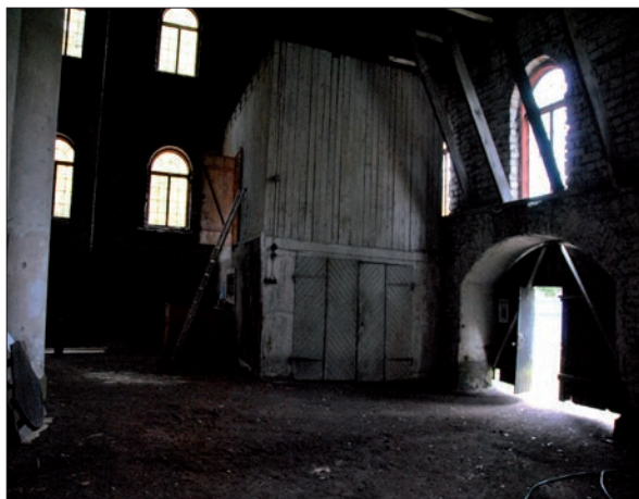
50 Garageutrymmet Nr 6. Utrymmet verkar vara angripet av röta och är kontaminerat av olja (Slm D2013-818).
