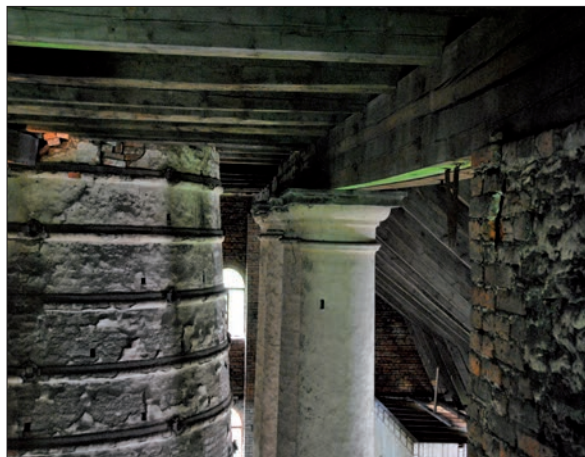
51 Lösa tegelstenar vid pipans topp. Kanske kan detta vara igenmurade öppningar. Järnbandet som är fäst i den längsgående bjälken har förmodligen varit en hållare för något rör. (SLM D2013-819).
