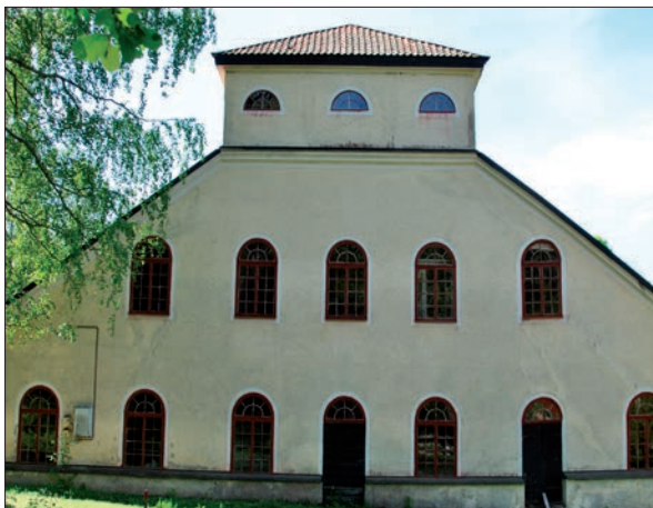
47 Den norra gaveln. Diagonala sprickor i murverket tyder på en mindre sättning i byggnadens mitt. (SLM D2013-815).
