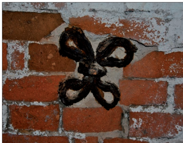
53 Kraftig spaltkorrosion har gett "wienerbrödsutseende" på ett ankarjärn vid pipans bas (SLM D2013-821).
