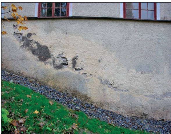
48 Vittringsskador i gjutväggen på den västra sidan (SLM D2013-816).
