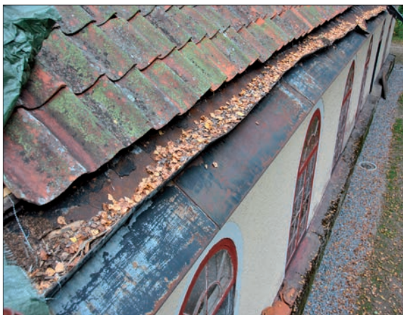
49 Östra sidan, takfotsrännan är genomrostad. (SLM D2013-817).
