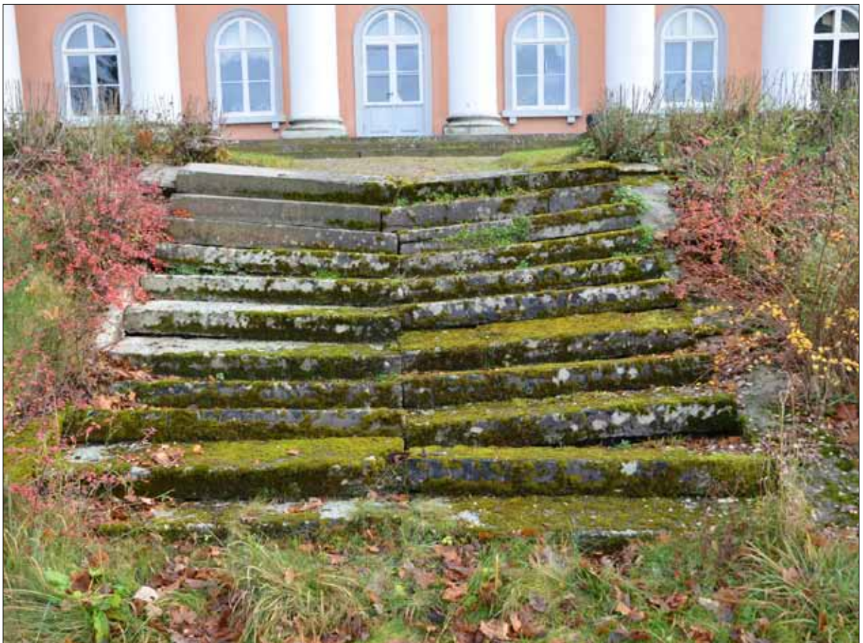
4 Kalkstenstrappan före det att arbeten påbörjades. Trappan hade satt sig och flera av sättstegen hade spruckit. De övre sättstegen är troligen utbytta (Slm D12-0952).
