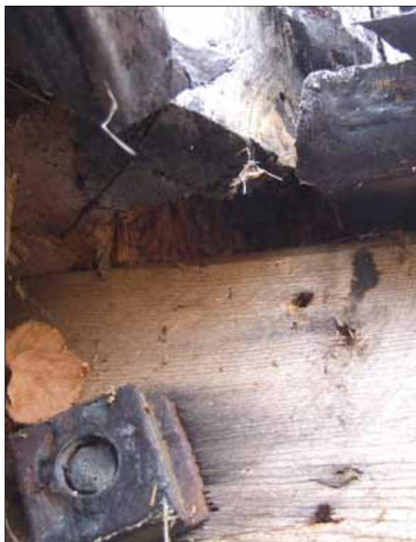
15 Rötskada i stolpen kunde anas, under den spruckna plåten i norr (Slm D11-733). Bilden beskuren.
