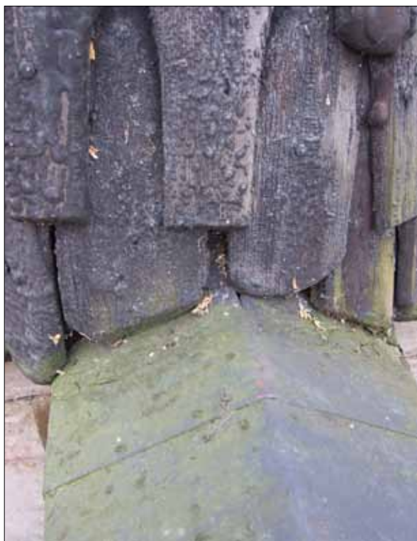
14 Spricka i norra sylplåten på norra stolpen (Slm D11-732). Bilden beskuren.
