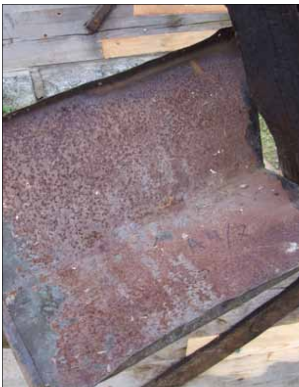
11 Plåtarna var mycket rostiga på undersidan (Slm D11-729). Bildens beskuren.
