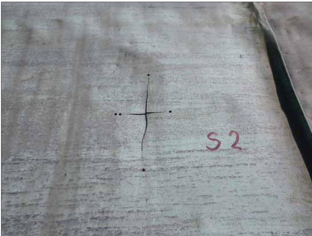
5 Sprickornas yttre spetsar borrades för att minska risken för fortsatt sprickbildning. Foto: Ulf Posse, Bettna Byggplåt.
