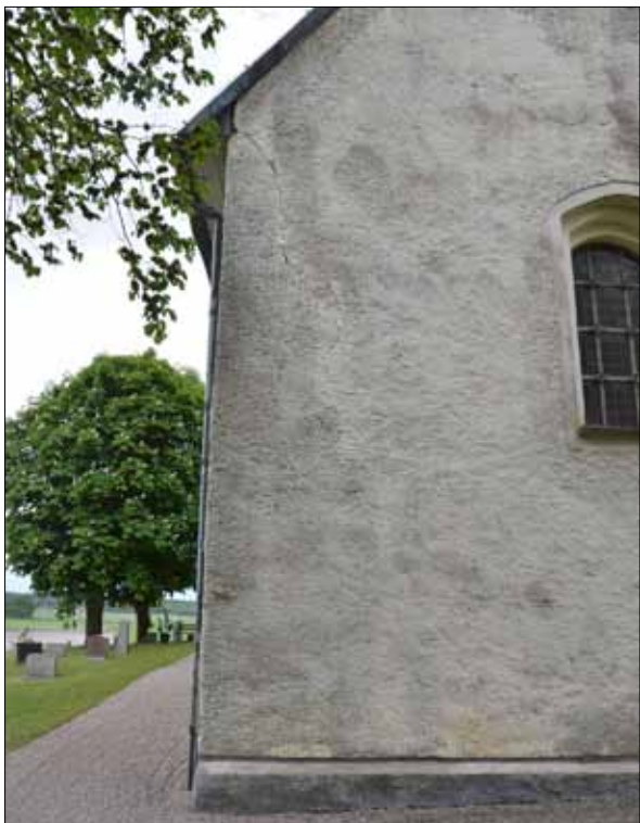
9 Sprickan på korgavelns södra sida före fasadrenoveringen (Slm D11-742).
