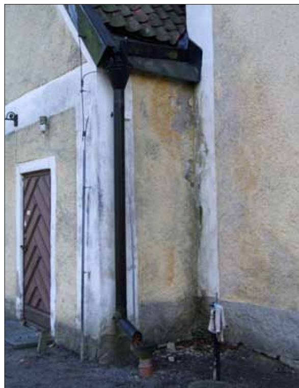
18 Hörnet mellan sakristian och långhuset uppvisade kraftiga fuktskador orsakade av takavvattningen före restaureringen (Slm D11-187).
