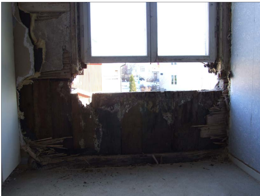
21 Stommen under fönstret i R202 var rötskadad. Fotografi Eva Wockatz, Sörmlands museum.
