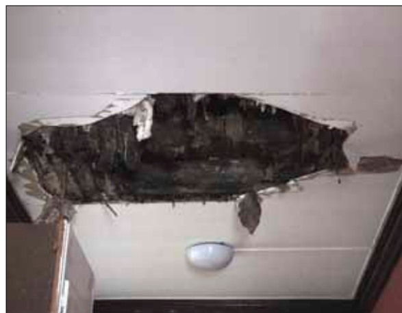
86 Ett av de två hål som finns i bjälklaget mellan hotellets andra våningsplan och vinden.
