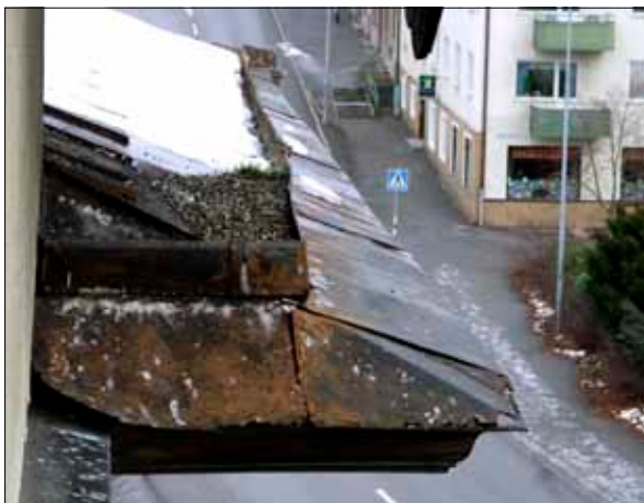
90 Sönderrostad plåt vid takfoten på hotellets södra sida.
