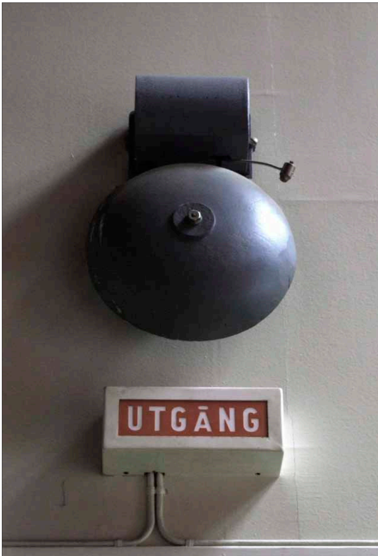
92 Brandlarm och utrymningsskylt över dörren mellan rum 301 och rum 314.
