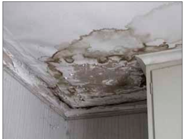
79 Fuktskada i taket i rummets nordöstra hörn.
