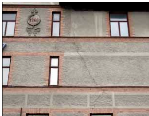
85 Sprickan på den södra fasadens östra del.
