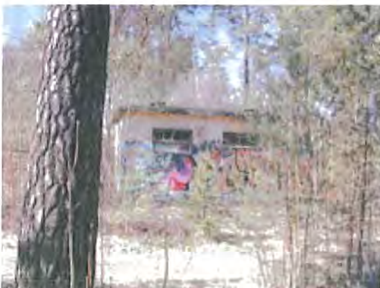
65. Pumpstationshuset ligger övergivet utanför det inhägnade industriområdet och har därigenom utsatts för vandalism.
