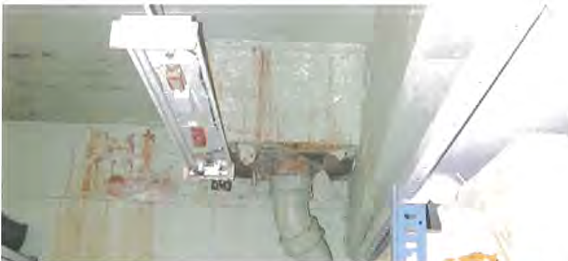
90. Läckage orsakade av att takbrunnarna ej rensas och underhålls är den ojämförligt största orsaken till takläckage och betongskador i anläggningen som helhet. Läckaget på bilden observerades i reservdelslagret vilket i övrigt dock är relativt förskonat från denna typ av skador.
