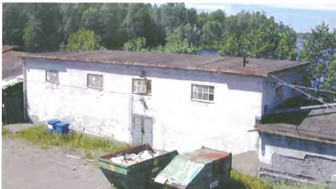
87. Vattenverksbyggnadens tak är i behov av omtäckning har ett fuktgenomslag i anslutning till den monterade stolpen som resulterat i jämförelsevis begränsade betongskador i betongplattan.
