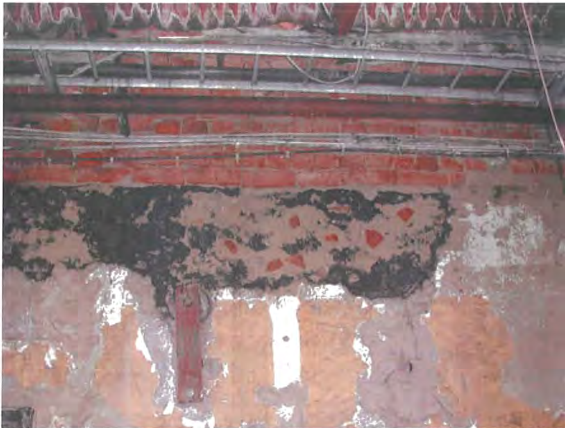
95. Putsskador förekommer på smedjans vägg. I samband med att byggnaden integrerades i det övriga bebyggelsekomplexet höjdes väggarna med några tegelskift varefter konstruktionen försågs med ett platt papptäckt betongtak.
