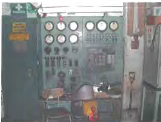
38. Kontrollpanel till elsmältverket.
