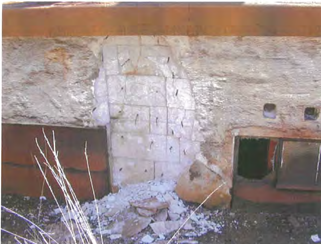
97. Putsskador på det västra verkstadskomplexet i anslutning till det suterrängliggande utrymme som sedan 1970-talet haft funktionen av galveri. Murverket är snarlikt det för vattenverket från 1945.
