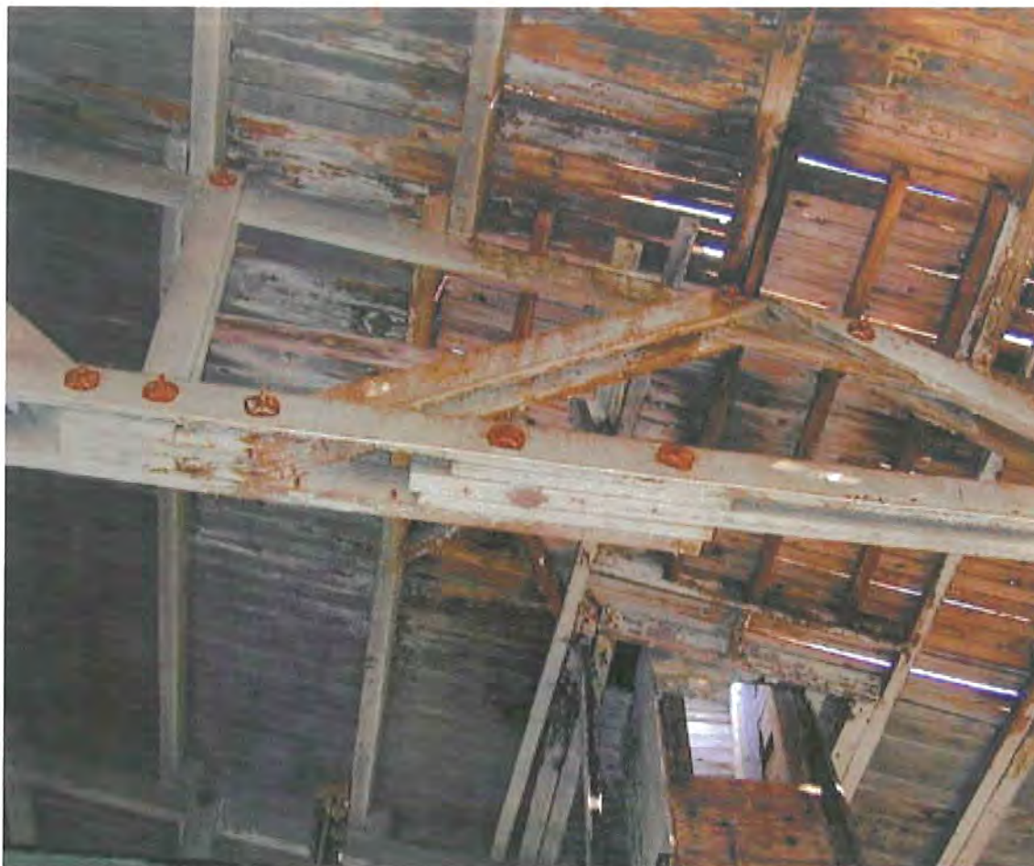
93. Takpapp saknas till sin helhet på partier av taket till det gamla galveriet vilket resulterat i rötskador på undertak och delar av takstol.
