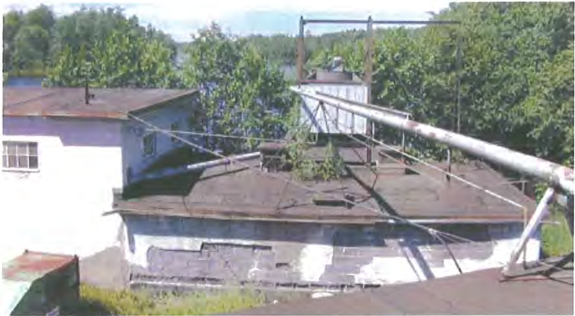
88. Den rena basängdelen på vattenverket är i behov av takomläggning och putsning.
