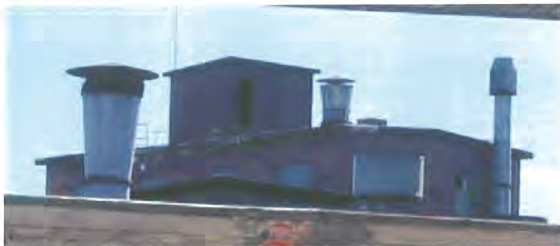
94. Sandberedningstornet har putsskador i anslutning till läckage vid takfoten.
