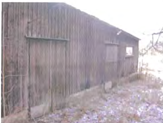
80. Flaskförrådets ursprungliga portar var igensatta och överisolerade från insidan.
