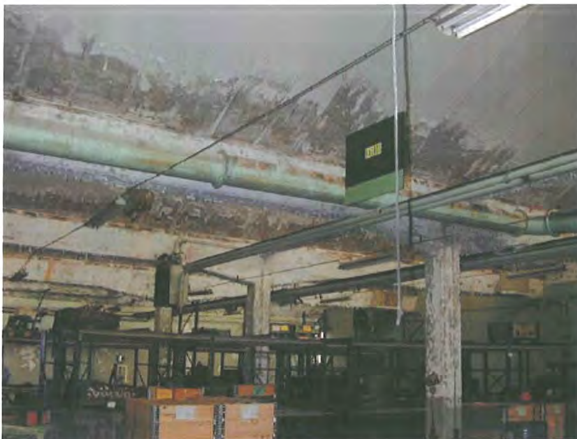
96. Betongskador finns på betongelementen tillhörande sågtandstaket till den västra verkstadslängan. Orsaken till skadorna är att tillsyn och underhåll av takbrunnar och rännaler ej sker.
