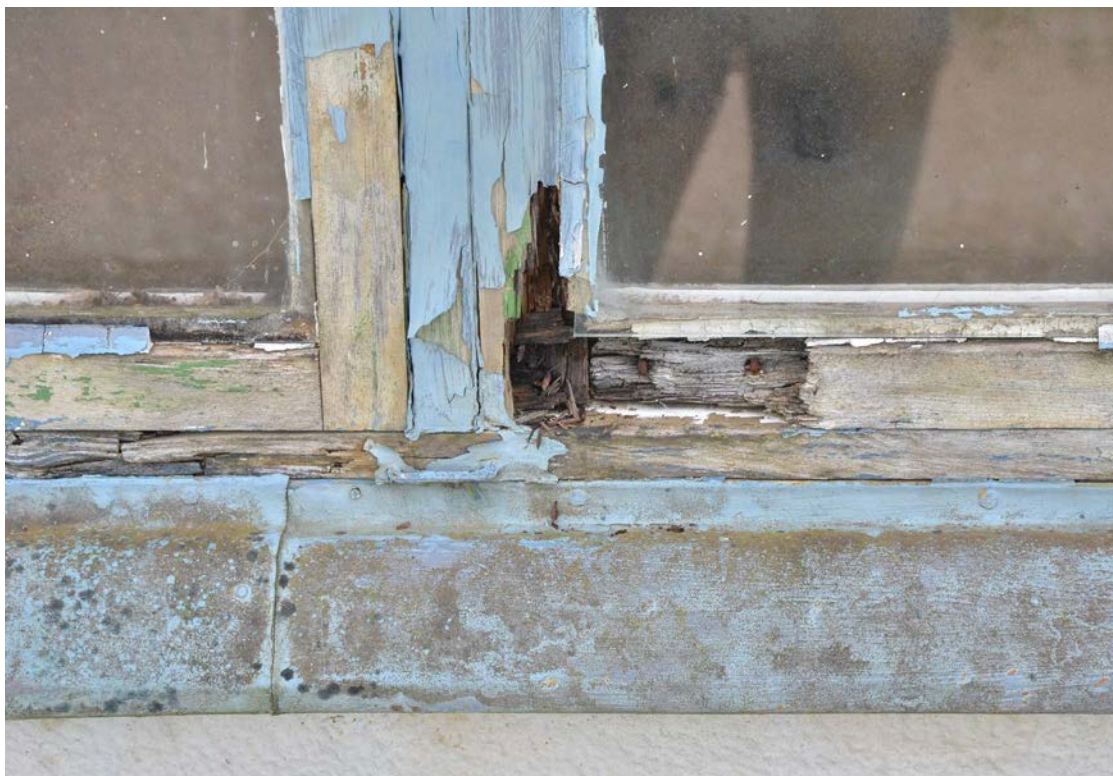
Detalj av fönster till verkstaden. Träet i båge och karmunderstycke är rötskadat och kittet har delvis fallit bort. (SLM D2018-0717)
