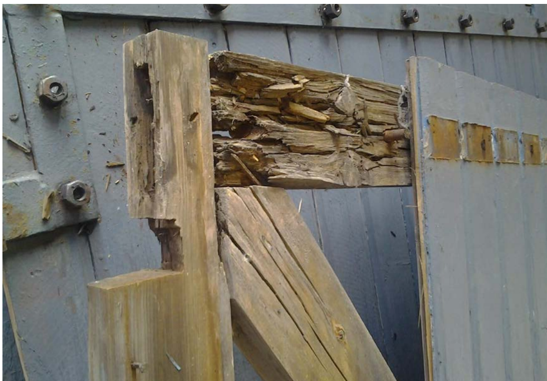
En av portarna under renovering. Panelen har delvis plockats av och träet i ramverket är nästan helt bortruttet. Skruvarna lossades från gångjärnen vid demonteringen och återanvändes i så hög utsträcknings som möjligt. Foto: Anders Axelsson
