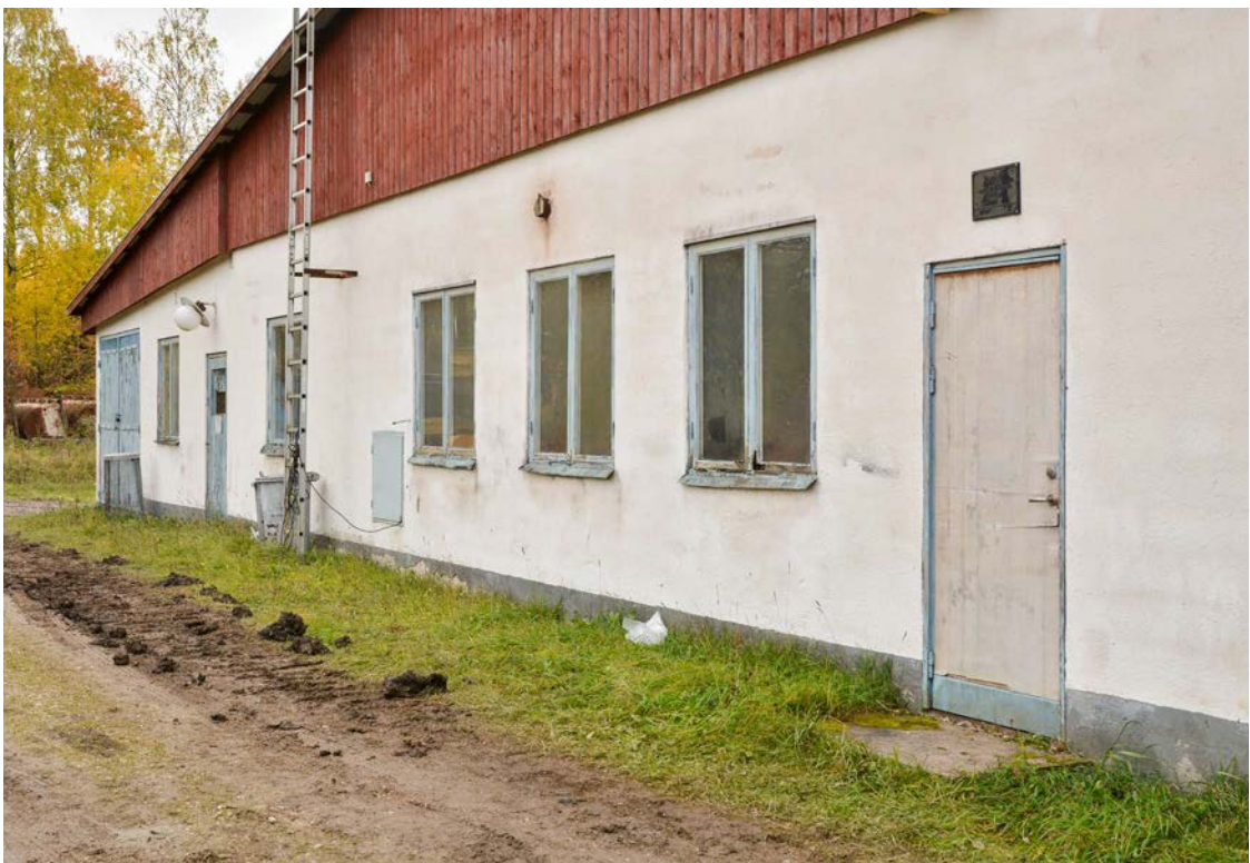
Bild av verkstadens och omklädningsrummens fönster och dörrar före åtgärd. Dörren närmast i bild är inte ursprunglig utan är troligen ditsatt någon gång under 1970-80-talet. Fönster och dörrar är mycket slitna med flera rötskadade partier. (SLM D2018-0715)
