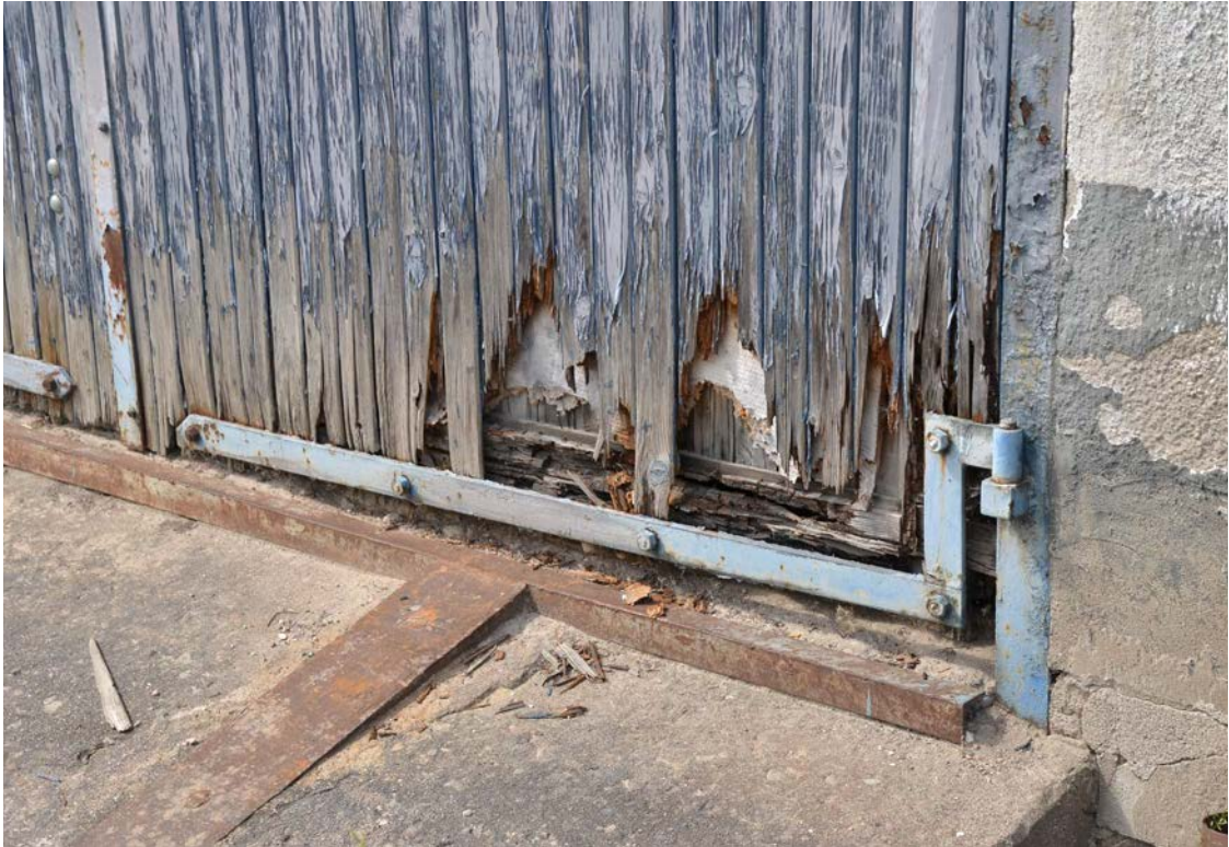
Detalj av en av garageportarna på östra sidan. Det finns inte mycket material kvar som håller gångjärnen på plats. Skadorna har uppkommit genom en kombination av eftersatt underhåll och bristfällig avvattning. (SLM D2018-0718)
