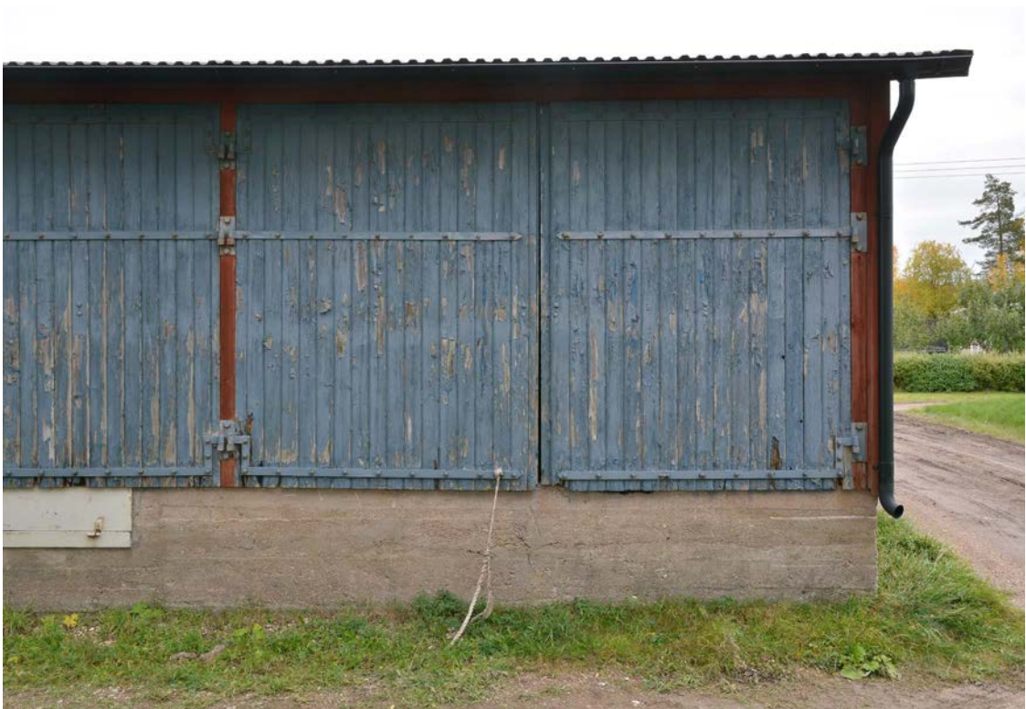
Västra sidans portar till förrådsbyggnaden uppvisar också flera rötskador i panel och underliggande ramverk. (SLM D2018-0719)
