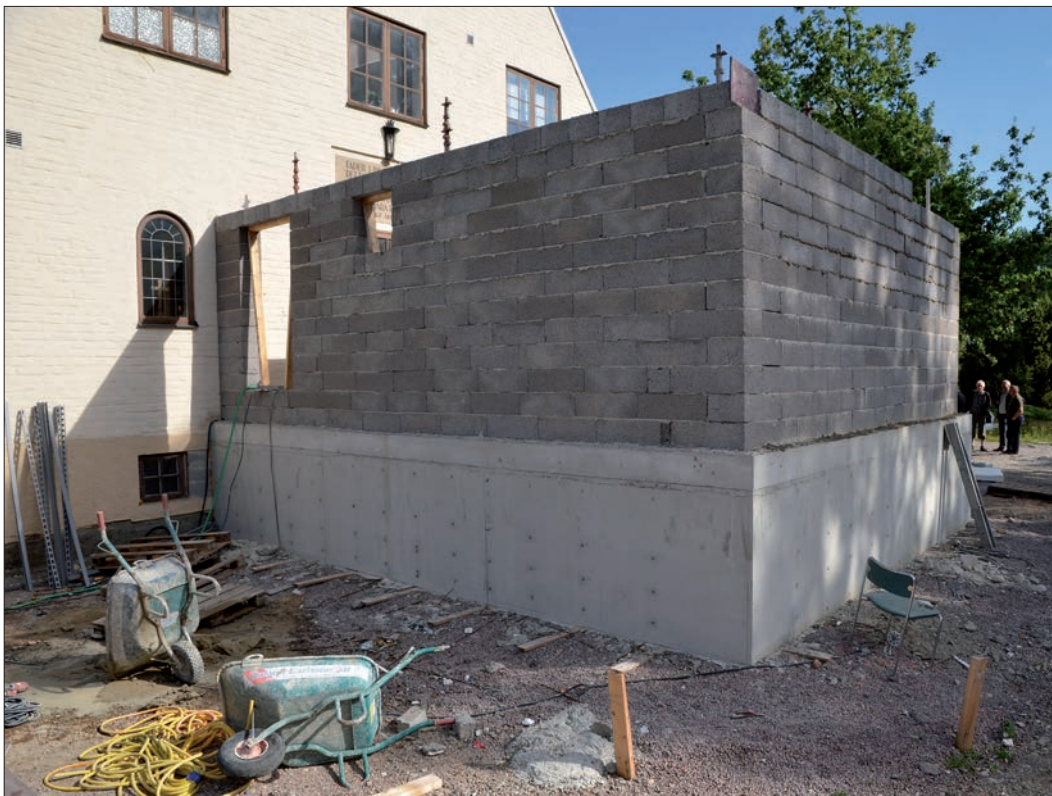
29 På grund av felaktigt utförd gjutning blev tillbyggnadens sockel ca 10 cm högre än sockeln på kyrkobyggnaden (Slm D13-0088).
