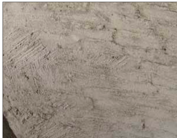
22 Detalj av valvkappa som hade en grov slamming. (D10-906)
