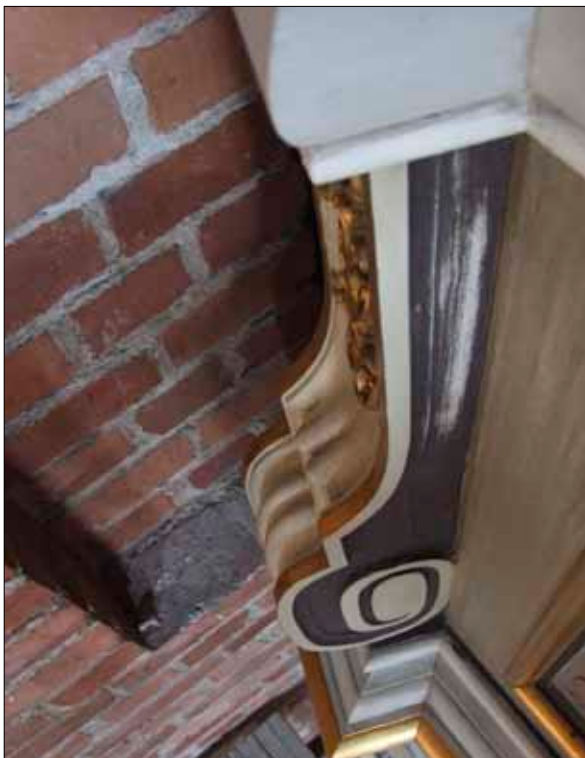
37 Skada på predikstolen som retuscherades. (D10-894)
