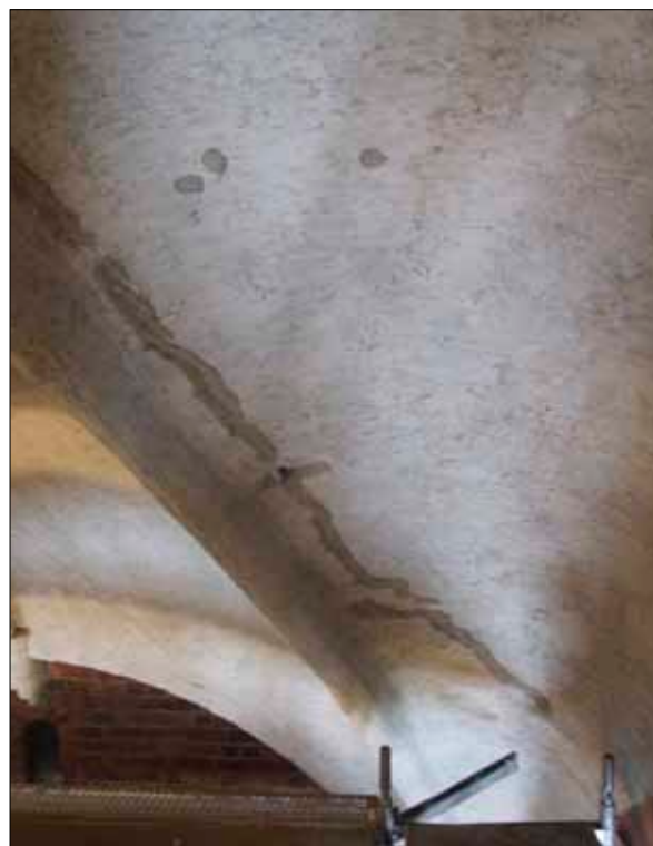
14 Spricka i valv 4 efter lagning. (D10-884)
