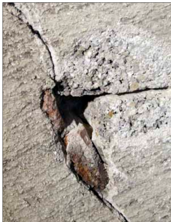
38 Del av upphuggen spricka i valvkappa 4. Till vänster syns tegelsten och till höger syns den skimpbetongstenen. (D10-882)
