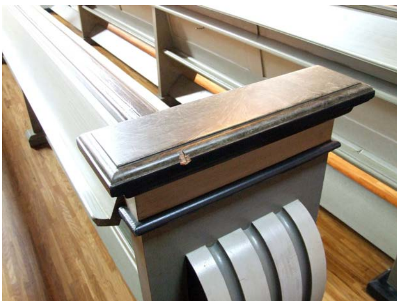
Bild 19. Stötmärke på en kyrkbänk av ställningsbyggnationen, vilket nu har åtgärdats av konservator.
