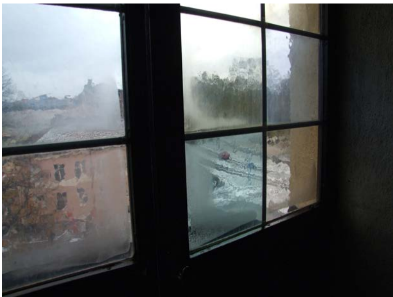
Bild 18. Kondens på fönster nr 17 vid balkongen.
