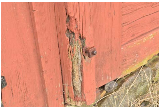
Bild 61. Rötskada på en av följarna på södra ekonomibyggnaden. (SLM D2024-0285)
