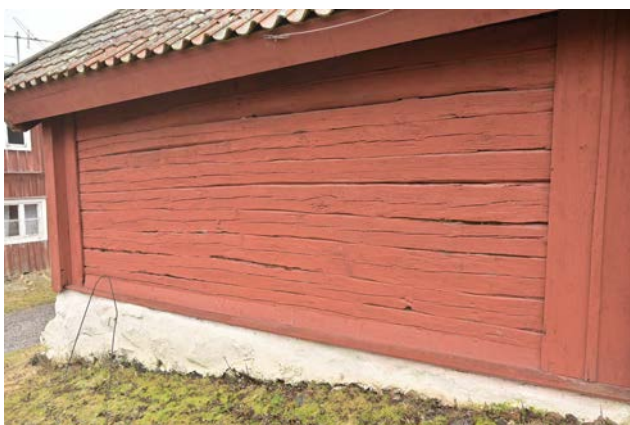
Bild 17. Foto av den opanelade väggen på stora bostadshusets norra sida. Väggen hade fickor i timret efter rötskador. Väggen panelades likt övriga huset innan rapporten färdigställdes. (SLM D2024-0241)
