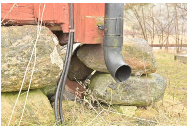
Bild 60. Grundstenarna vid det nordvästra hörnet på södra ekonomibyggnaden har flyttat sig och riskerar att trilla ut. (SLM D2024-0284)
