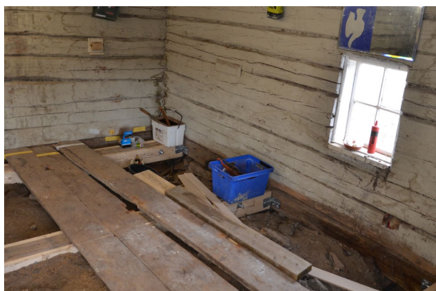
Bild 34. Förrådsdelen under pågående arbete med förstärkning av bjälklaget. Till höger syns fönstret vid husets östra gavel. Foto: Kjell Taawo, Sörmlands museum (SLM D2024-0258)
