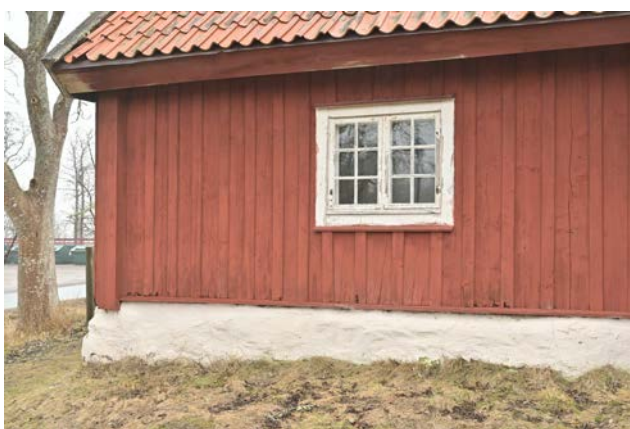
Bild 16. Stora bostadshusets södra fasad, med mindre skadade partier i panelens nederkant. (SLM D2024-0240)
