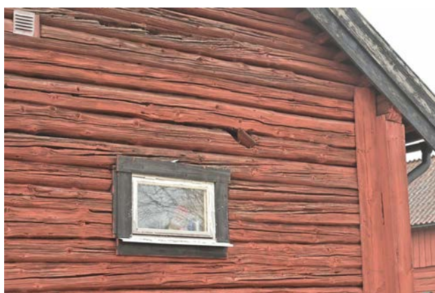
Bild 52. Norra ekonomibyggnadens västra gavel har djupa fickor efter rötskador. (SLM D2024-0276)
