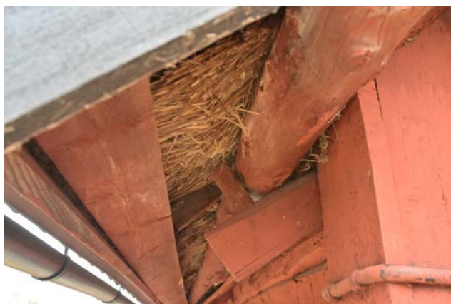
Bild 55. Stråttaket under norra ekonomibyggnaden är synligt vid takfoten. (SLM D2024-0279)
