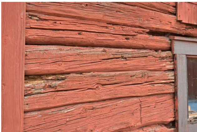
Bild 73. Rötskador i timmerstommen på uthusets södra fasad. (SLM D2024-0297)
