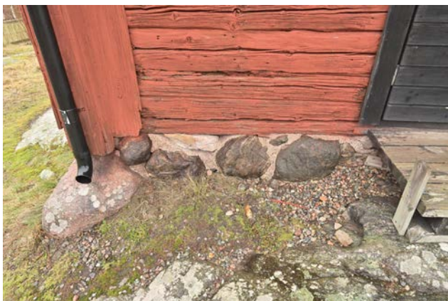
Bild 49. Fogad naturstensgrund och rötskador i timmerstomme på norra ekonomibyggnaden. (SLM D2024-0273)
