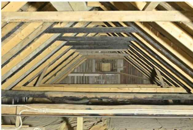
Bild 69. Vinden över den högre delen av södra ekonomibyggnaden sett mot öster. Notera de brandskadade takstolarna som idag är kompletterade med nya takstolar. (SLM D2024-0293)
