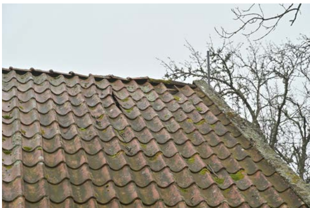
Bild 21. Felaktigt liggande pannor på stora bostadshusets norra takfall. (SLM D2024-0245)
