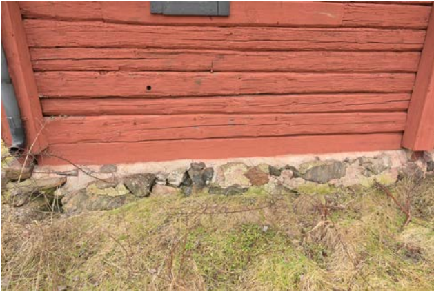
Bild 75. Syllstocken på uthusets västra sida har bytts ut i senare tid. (SLM D2024-0299)
