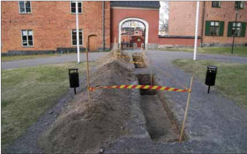
Figur 5. Vy över schakt 3 & 4 med Domkapitel- och tryckerihuset i bakgrunden. Fotot är taget från öst. Foto: Peter Berg 2013, Sörmlands museum.
