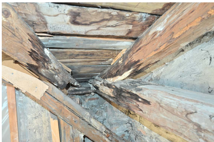
Rötskador efter tidigare takläckage finns i det oinredda vindsutrymmet. (SLM D2025-0115)
