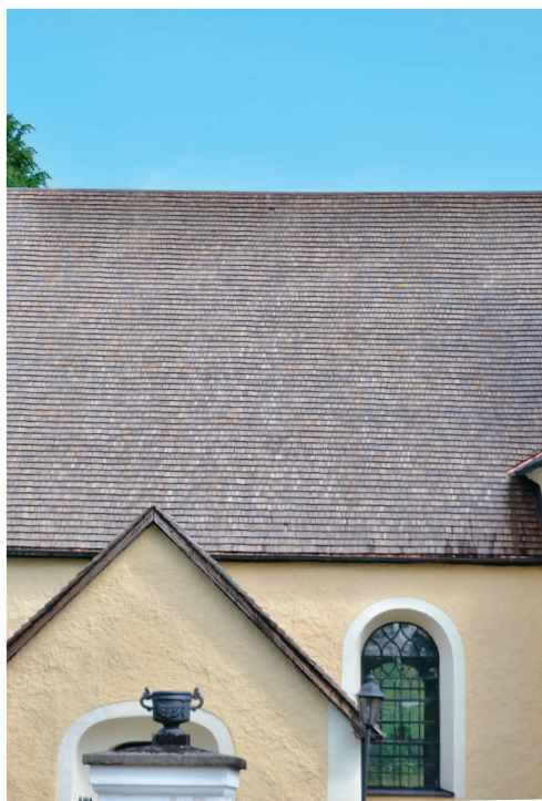
Bild 6. Södra långhustaket innan åtgärder. Foto 2024-06-11. (SLM D2024-0453)
