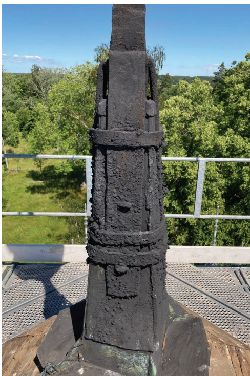
Bild 12. Spirans infästning och stenkolstjära innan renovering. Foto 2024-06-25. (SLM D2024-0459)
