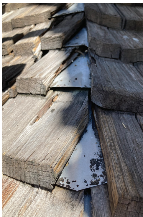
Bild 5. Nynästornets tak innan åtgärder. Foto 2024-06-25. (SLM D2024-0452)
