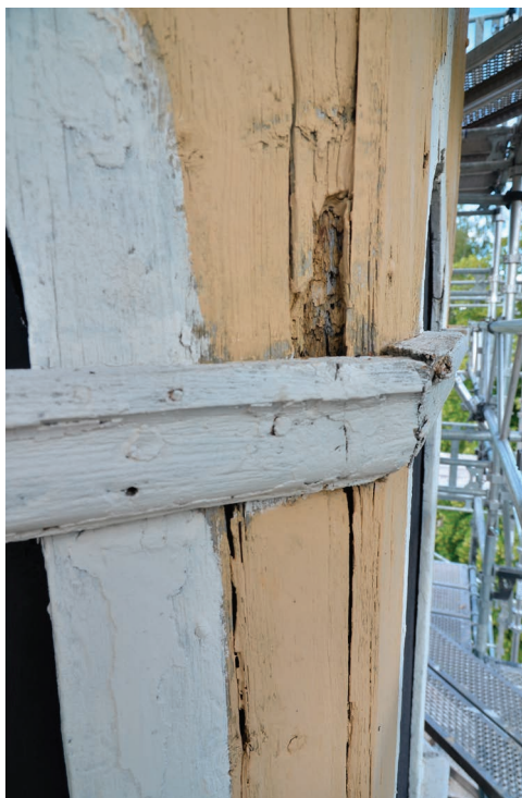
Bild 11. Kransgesims och rötskadad panel. Foto 2024-07-12. (SLM D2024-0458)
