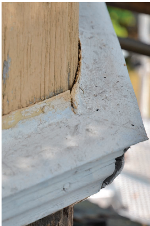
Bild 10. Gördelgesims med vattplåt innan åtgärder. Foto 2024-07-12. (SLM D2024-0457)
