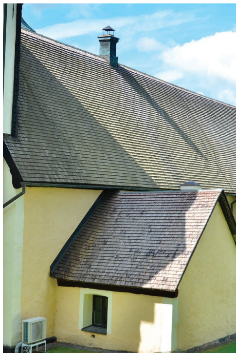
Bild 7. Norra långhustaket och sakristians tak innan åtgärder. Foto 2024-06-11. (SLM D2024-0454)
