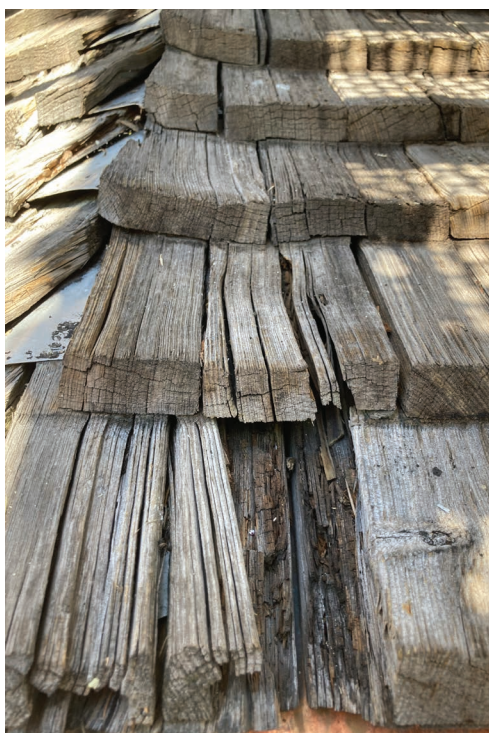
Bild 4. Nynästornets tak innan åtgärder. Foto 2024-06-25. (SLM D2024-0451)
