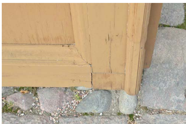
Portgångens dörrar är i behov av underhåll. Färgskikten flagar och färgen har mattats, framförallt på sidan som vetter mot torget. (SLM D2025-0072)
