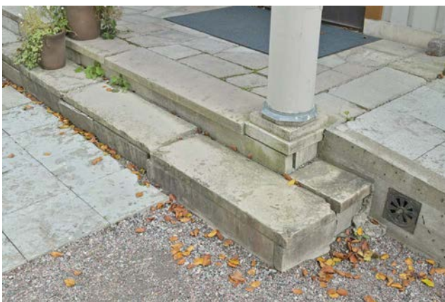
Entrétrappa och terrass har sättningar samt flera trasiga stenar. Stora glipor finns på flera ställen, och flera av sättstegen är på väg att trilla ur. Trappan behöver sättas om i sin helhet. (SLM D2025-0074)
