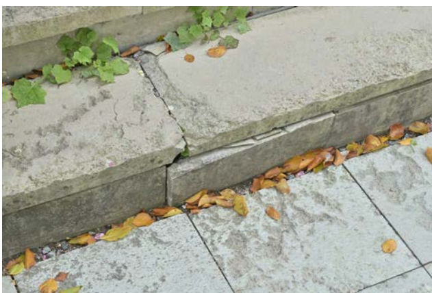
Närbild på trappan där sättsteg är på väg att trilla ur. Växtlighet finns också i trappan. (SLM D2025-0075)
