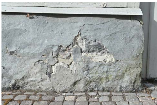
Den putsade grunden har sprickor och även stora putsbortfall. (SLM D2025-0071)
