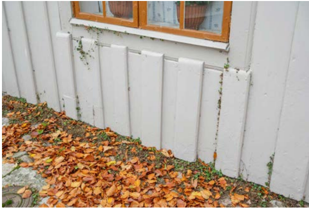
Växtlighet har fått fäste nära byggnaden, som också tar sig upp på och bakom fasadpanelen. (SLM D2025-0083)
