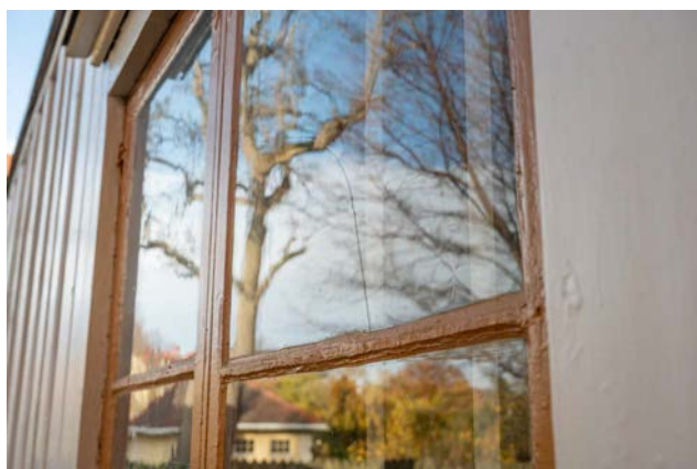
En glasruta på stallflygelns fönster mot lusthuset är trasig. Glaset är handblåst och ska därför ersättas av likvärdigt glas. (SLM D2025-0090)
