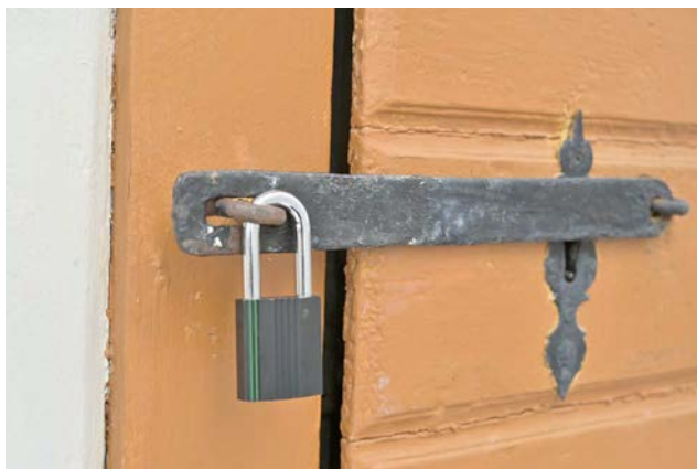
Stallflygelns mittersta dörr på den sydvästra väggen går inte igen helt. Låsregeln sitter för långt ut och trycker inte igen dörrbladet vilket gör att snö och regn kan blåsa in. (SLM D2025-0087)
