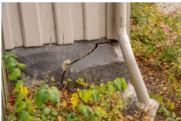
En större spricka finns på bostadsflygelns västra hörn där hörnstenarna har satt sig och inte längre har kontakt med knuten. (SLM D2025-0082)
