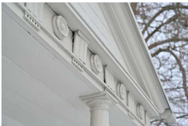
Delar på lusthusets fris sitter löst och riskerar att falla bort. (SLM D2025-0091)
