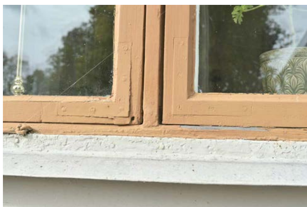
Huvudbyggnadens fönster mot torget är mest utsatta och har störst underhållsbehov. Färg flagar och har mattats, hörnjärn reser sig och kittet släpper på sina ställen från glas och trä. (SLM D2025-0076)
