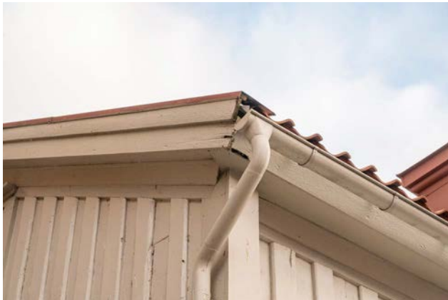
En rötskada finns vid takfot och vindskiva på bostadsflygelns västra hörn. Man bör undersöka om det finns ett läckage från taket på detta ställe. (SLM D2025-0085)
