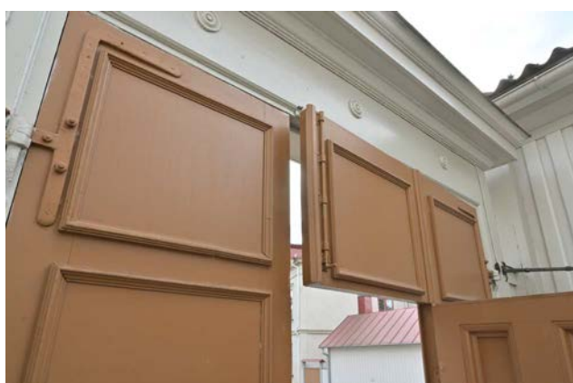
Portgångarnas dörrar har slagit sig och är svåra att regla. Dessutom är det tjocka färglager på reglar som gör att de fastnat. (SLM D2025-0073)
