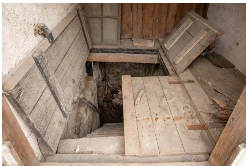
Nedgången till källaren under stallflygelns sydvästra länga. Väggarna i denna del har en korsvirkeskonstruktion med tegel som putsats. (SLM D2025-0020)
