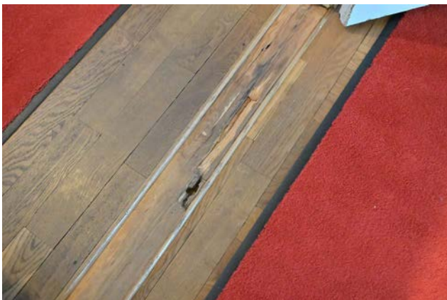
Golvet mellan hall (1) och passage (2) har skador i parketten. (SLM D2025-0079)
