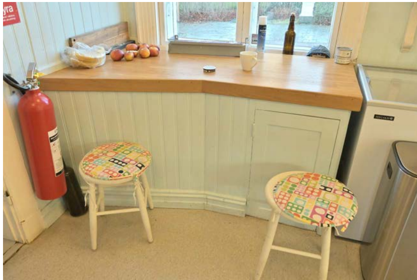
Ett bevarat bänkskåp från den äldre inredningen i köket, dock med utbytt bänkskiva. (D2025-0047)
