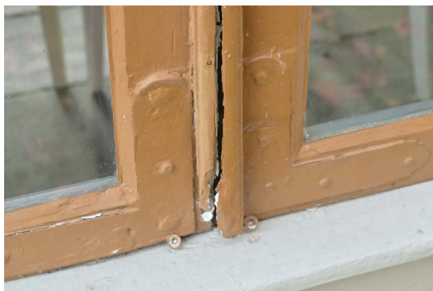
Täcklisten är sprucken och riskerar leda in vatten mellan bågarna. (SLM D2025-0093)
