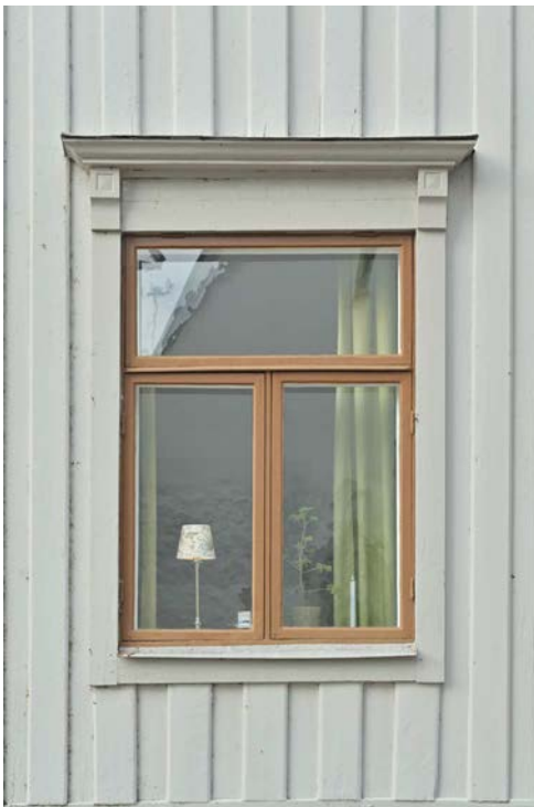
Närbild på ett av fönstren idag. Fönsterindelingen och avsaknad av spröjs stjälp uppmärksamheten från de vackert snidade fönsteröverstyckena. (SLM D2025-0098)
