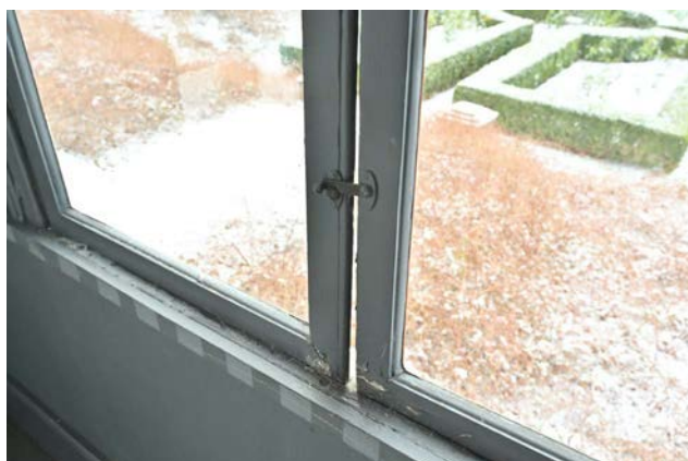
Det finns stora glipor mellan fönsterbågarna där regn och snö tar sig in. (SLM D2025-0094)
