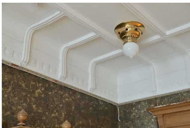
Detalj av taket i Lilla matsalen med ursprunglig armatur. Denna har sannolikt tidigare varit driven av acetylengasverket. (SLM D2025-0379)
