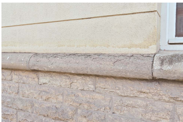
Vissa av sockellistens stenar är kraftigt vittrade, här på den norra flygelarmen mot Storgatan. (SLM D2025-0370)
