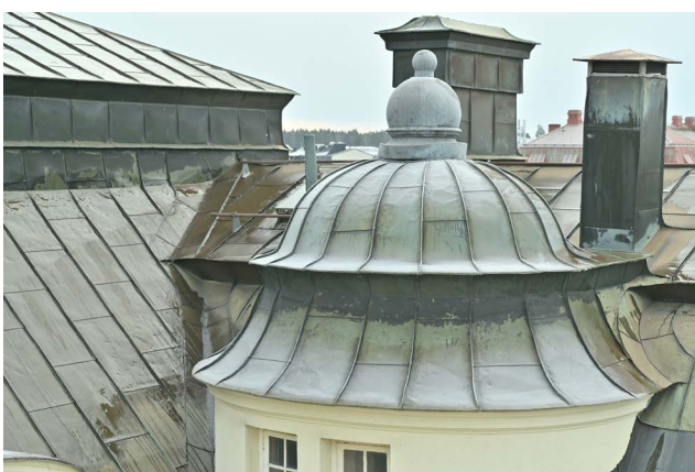
Kupolen över den södra flygelarmens halvcirkelformade schakt är fortfarande oförändrad. Kopparsplåtens kulör skiljer sig från övriga taket vilket kan tyda på att den inte bytts på detta tak. (SLM D2025-0365)
