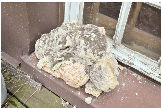
Den lossnade biten av festongen ligger på terrassen. (SLM D2025-0367)
