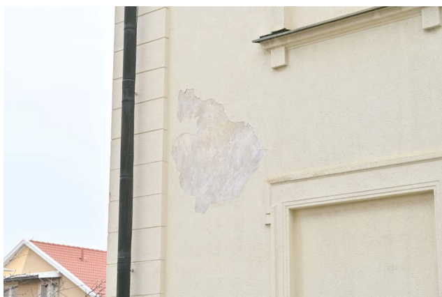
Parti på södra flygelarmens fasad där den yttersta sprutputsen har fallit bort. Den underliggande putsen uppvisar både en liknande kulör som idag, men också en vitare nyans. (SLM D2025-0368)
