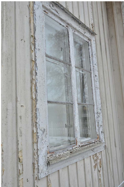
Bild 32. Fönster i behov av renovering. Hörnjärn rostar. Fönsterkitt släpper och målarfärg flagar. (SLM D2024-232)
