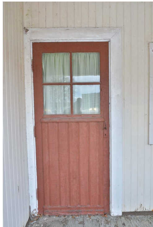
Bild 38. Ytterdörren vid verandan är glasad. Kittet är sprucket. Målarfärgen flagar kraftigt. (SLM D2024-238)
