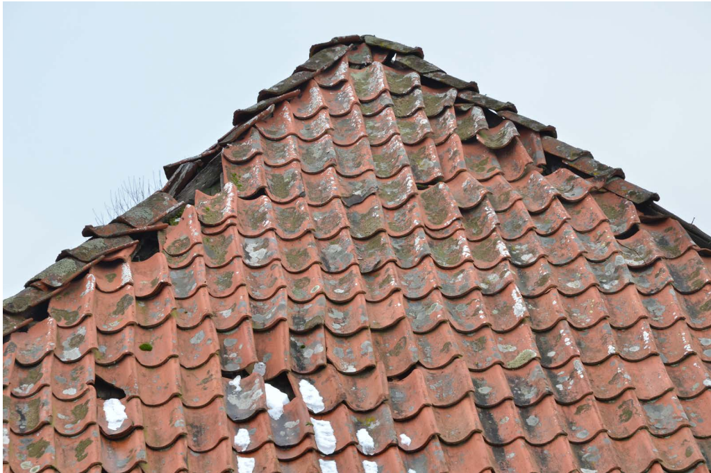
Bild 20. Taket på magasinet har stora brister. Tegelpannor saknas, är trasiga eller har kanat ur läge. (SLM D2024-220)
