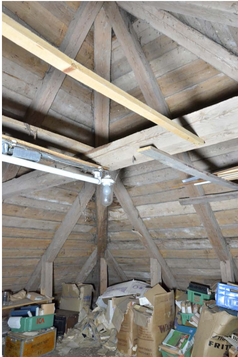
Bild 23. Större delen av underlagstaket ser underifrån ut att vara i funktionsdugligt skick, tack vare dess tjocklek och höga virkeskvalitet. (SLM D2024-223)
