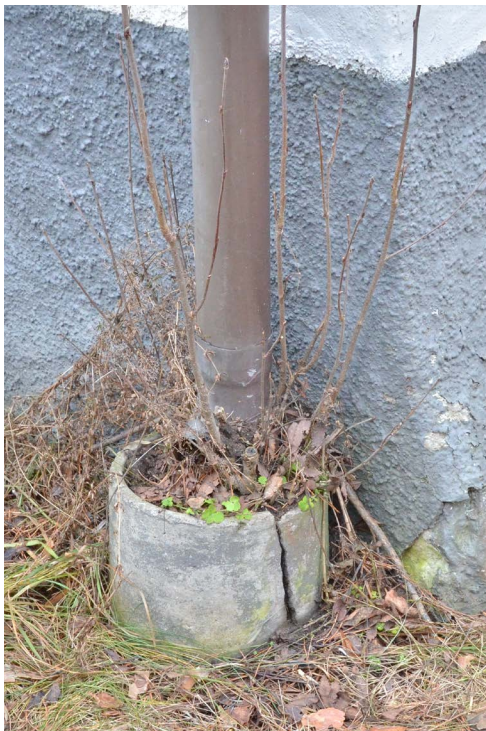
Bild 17. Dräneringsröret är igenproppat och cementröret är sprucket. (SLM D2024-217)
