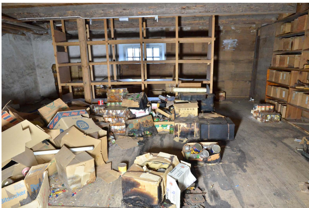
Bild 22. Våning 1 sedd mot öster. Specerier och konservburkar läcker, vilket riskerar att orsaka omfattande skador på framförallt träbjälklagen. (SLM D2024-222)
