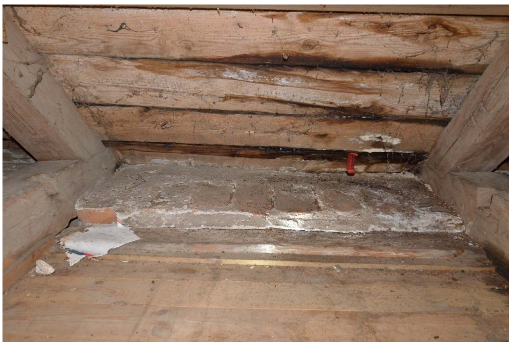
Bild 19. Underlagstaket har lokala rötskador och pågående takläckage syns. Våning 2 sedd mot söder. (SLM D2024-219)
