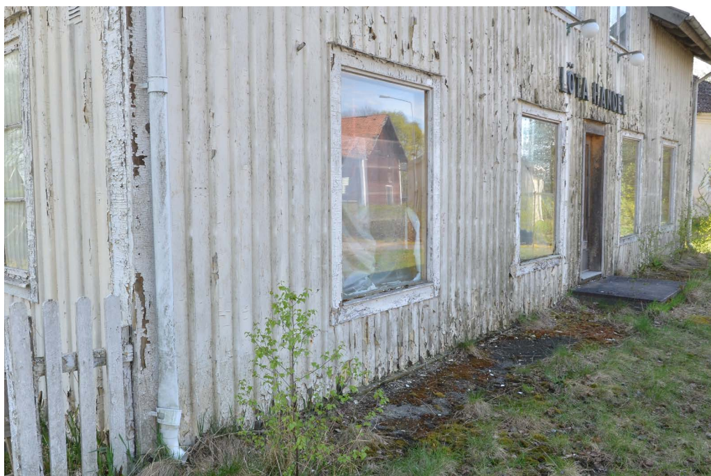
Bild 29. Marknivån är för hög utefter norra fasaden. Fasadpanelen står i princip på marken. Vattbrädan/fotbrädan och fasadpanelen är rötskadad. Målarfärgen flagar kraftigt. (SLM D2024-229)
