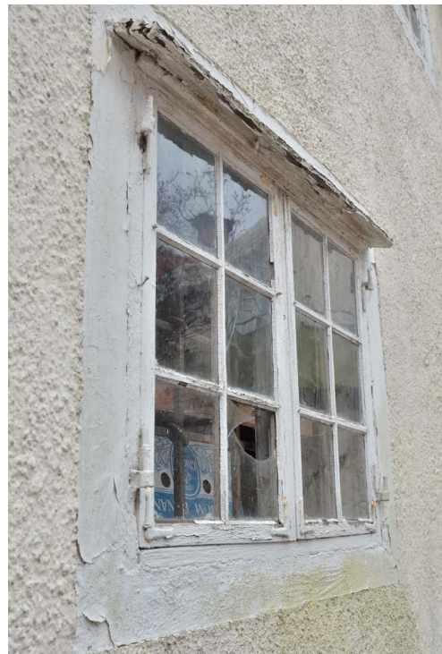
Bild 18. Fönstren är i behov av renovering. Vissa glas är trasiga. Droppbrädan ovanför fönstret är rötskadad. (SLM D2024-218)
