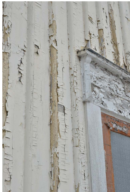
Bild 33. Fasadens målarfärg flagar kraftigt. Underliggande färglager är linoljefärg. (SLM D2024-233)
