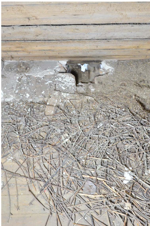
Bild 25. På våning 2 där traversbalken är rötskadad, finns ett hål, vilket gör att fåglar kan flyga in. Rester av gammalt fågelbo. (SLM D2024-225)
