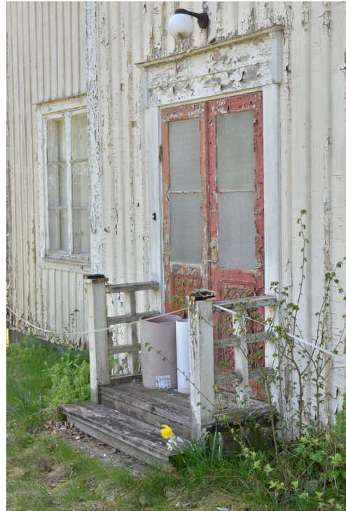
Bild 31. Ingången på östra gaveln. Fönsterkitt på dörren har lossnat. Räckets är kraftigt rötskadat. (SLM D2024-231)
