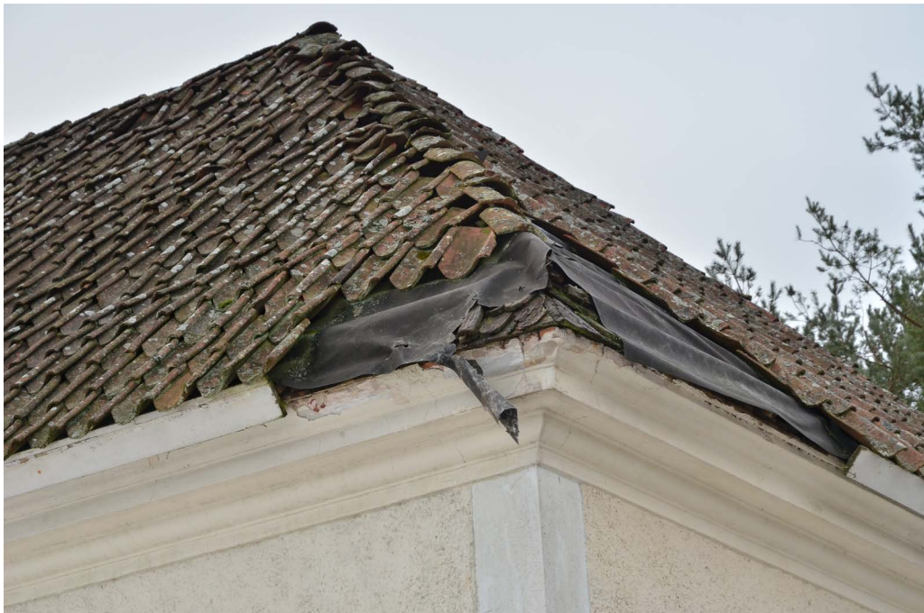
Bild 21. Magasinet nordvästra hörn där tegelpannor saknas och istället har en takduk lagts dit. Under syns äldre spånläggning. Takfotsbrädan har lossnat helt. (SLM D2024-221)
