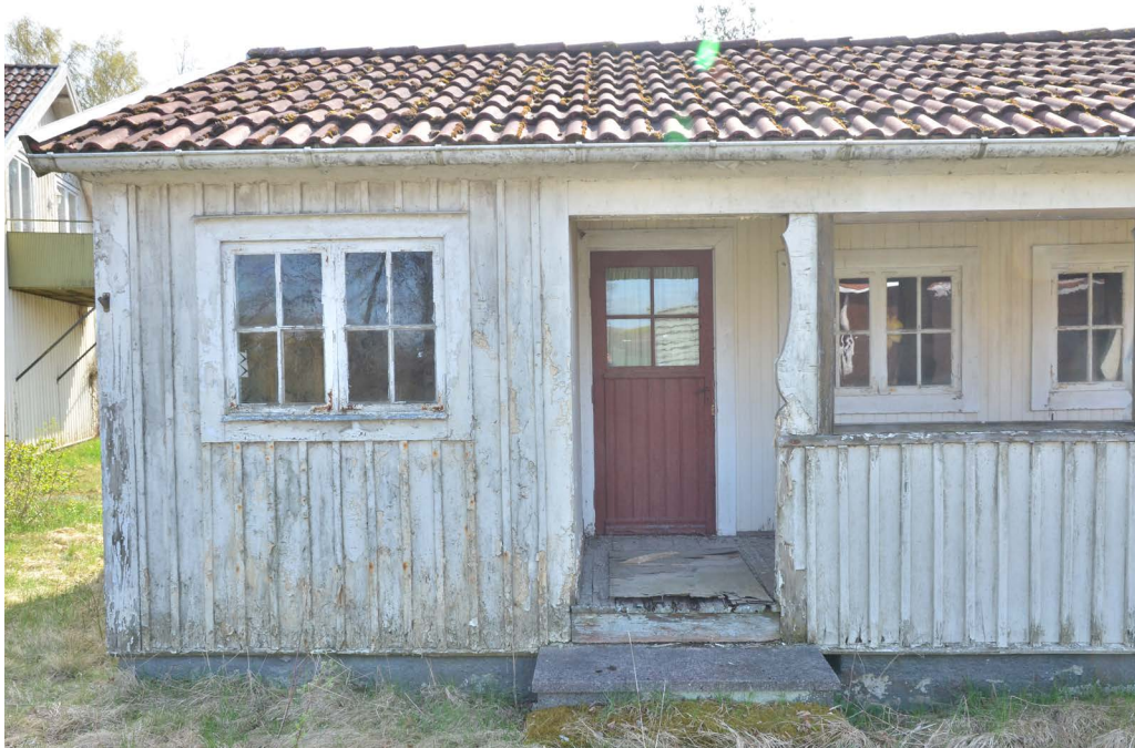
Bild 36. Vattbrädan/fotbrädan och delar av fasadpanelen är rötskadad. Målarfärgen flagar kraftigt. Verandans golv är rötskadat. (SLM D2024-236)
