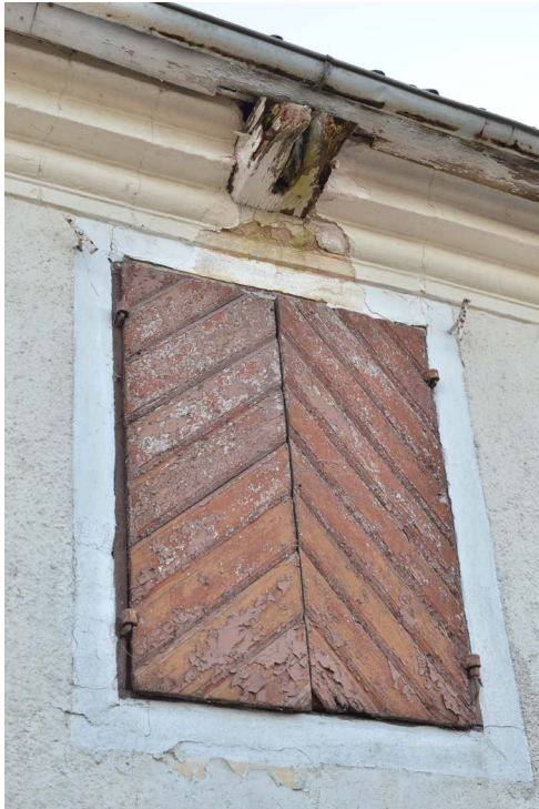
Bild 15. Luckan för spannmålsintaget på våning 2. Målarfärgen flagar. Den ovanförliggande traversbalken är rötskadad. (SLM D2024-215)
