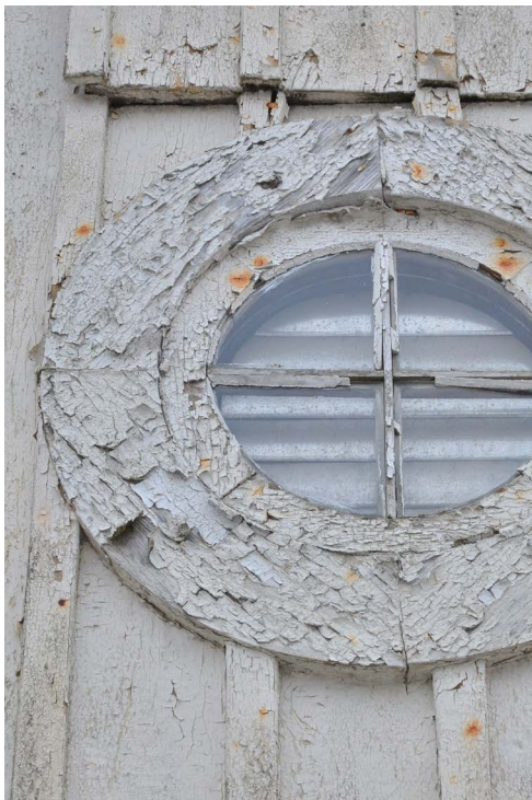
Bild 37. Fönster är i behov av renovering. Kittet har lossnat. Målarfärgen flagar kraftigt. Rost förekommer. (SLM D2024-237)
