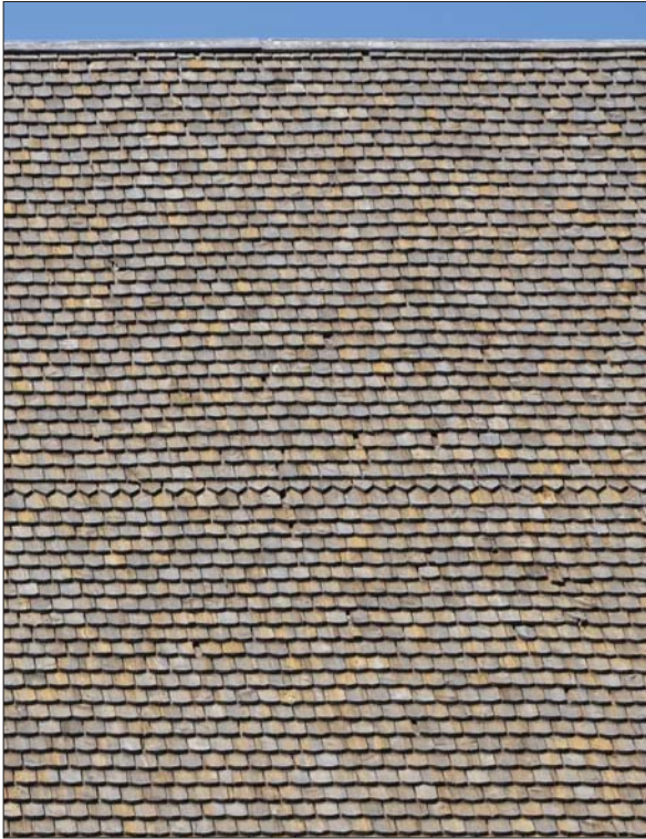
24 Del av långhustakets spåntak före arbeten (SLM D2015-1094).
