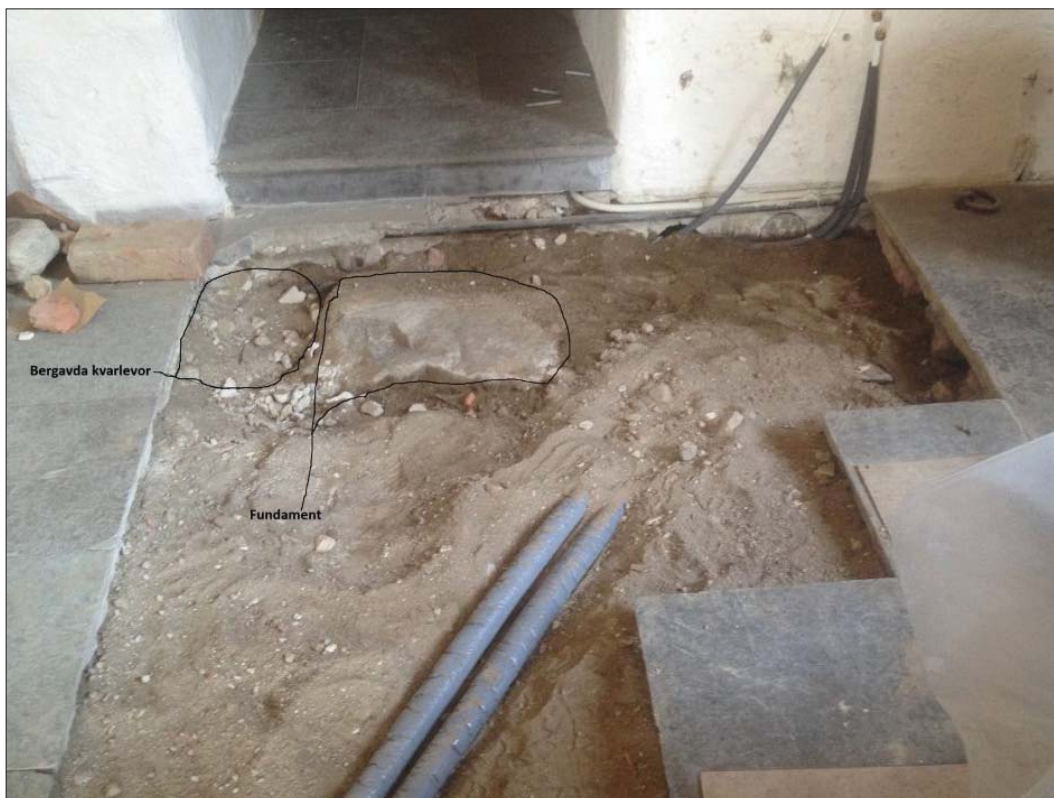
10 Naturstenen flyttades nu åt väster, samt placerades något djupare. Väster om naturstenen lades benen tillbaks. Bild från Tyrfors Bygg.
