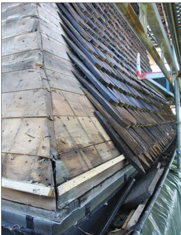
19 Tornets underlagstak var i gott skick. Spånen lades på samma sätt som tidigare...(SLM D2015-1089).
