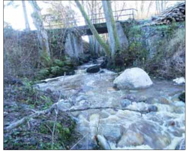
Figur 8. Objekt 1 efter åtgärden genomförts. Det stora stenblocket placerades i bäcken som en del av tröskeln. Bron över bäcken syns i bakgrunden. Till höger syns den stenskonig som möjligen utgjort grunden till en masugn. Bilden är tagen från nordöst vid högvatten. Foto: Ingeborg Svensson 2012, Sörmlands museum.
