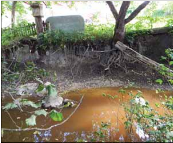
Figur 28. Den kraftigt eroderade ytterkurvan innan åtgärden genomfördes. Bilden är tagen från västnordväst och vid lågvatten. Foto: Ingeborg Svensson 2012, Sörmlands museum.
