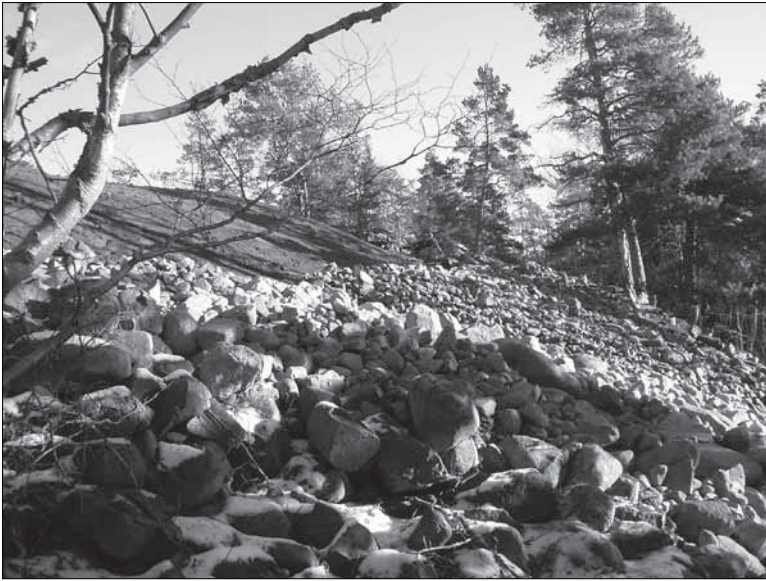
Figur 15. Det återskapade muravsnittet inom det tidigare skadade området i södra delen av fornborgen. Bilden är tagen från väster. Foto: Ingeborg Svensson 2005, Sörmlands museum.
